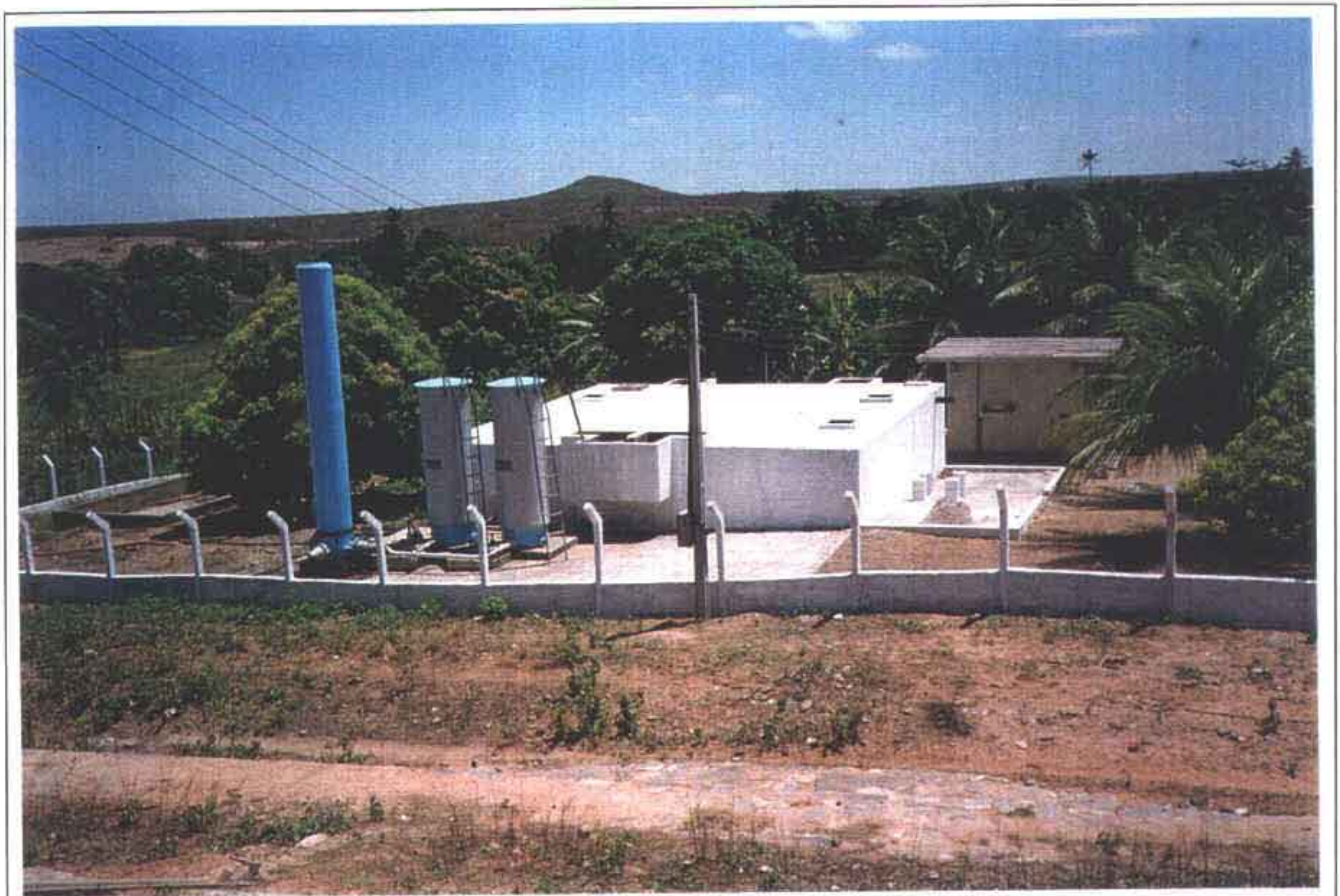
FOTO 09/17 - Visão geral da Estação de tratamento da Vila de Feiticeiro.
