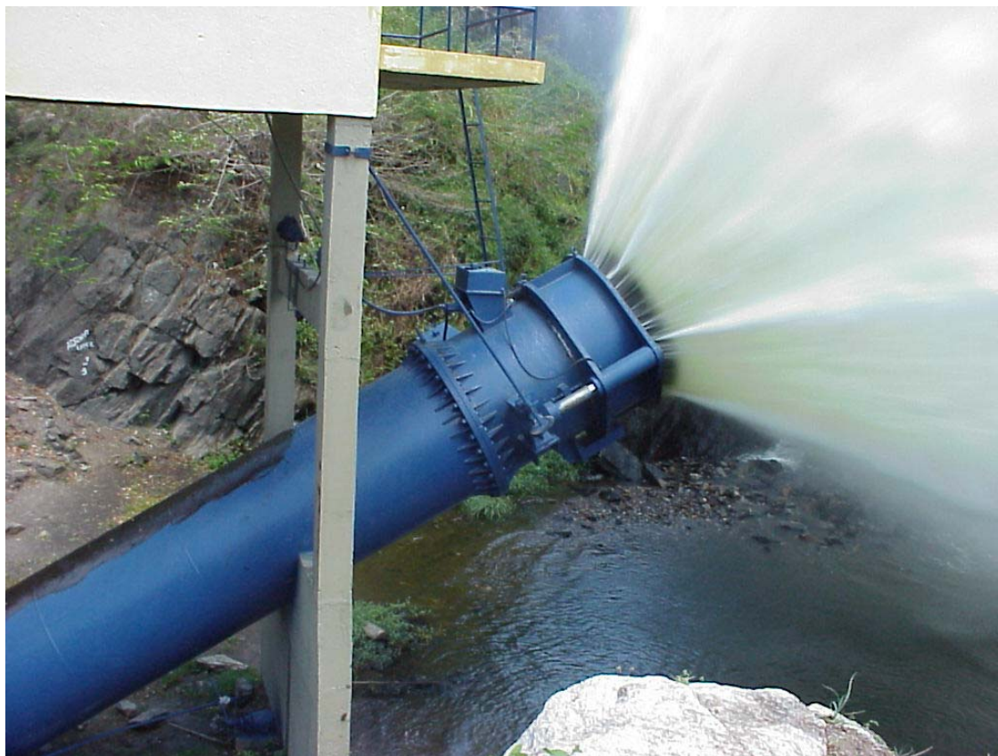
Figura 5 – Detalhe da Válvula Dispersora e Flange de conexão do barrilete
