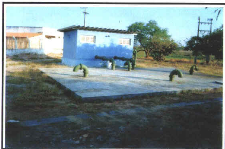
Foto 13 – Vista da EE-03 existente.
