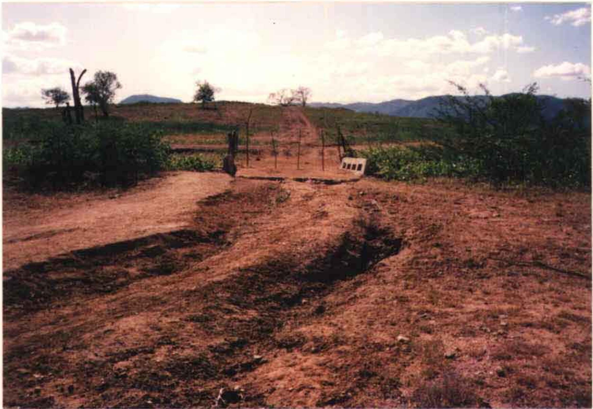
FOTO 39: Estado da estrada. A foto mostra a estrada principal que margeia o canal P 1 . Em certos trechos há grande erosão, atingindo o sub-leito. Na foto aparece atrás o canal sob um pontilhão.
