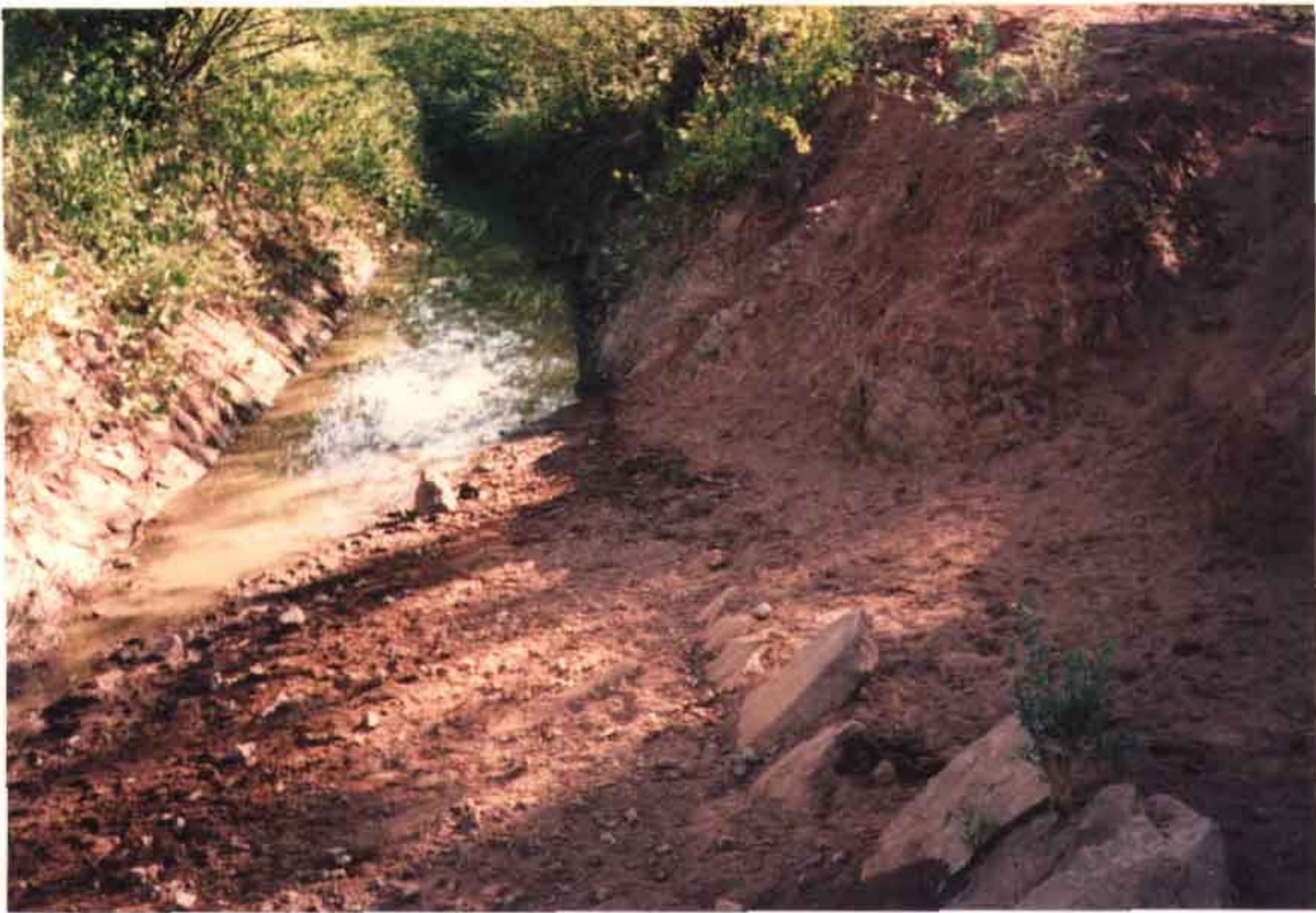
FOTO 08: Vista de jusante do canal P_1 no Km 10,7 após seu início. Observar a destruição de parte do canal em um trecho de 10 m com uma pequena lâmina de água acumulada.
