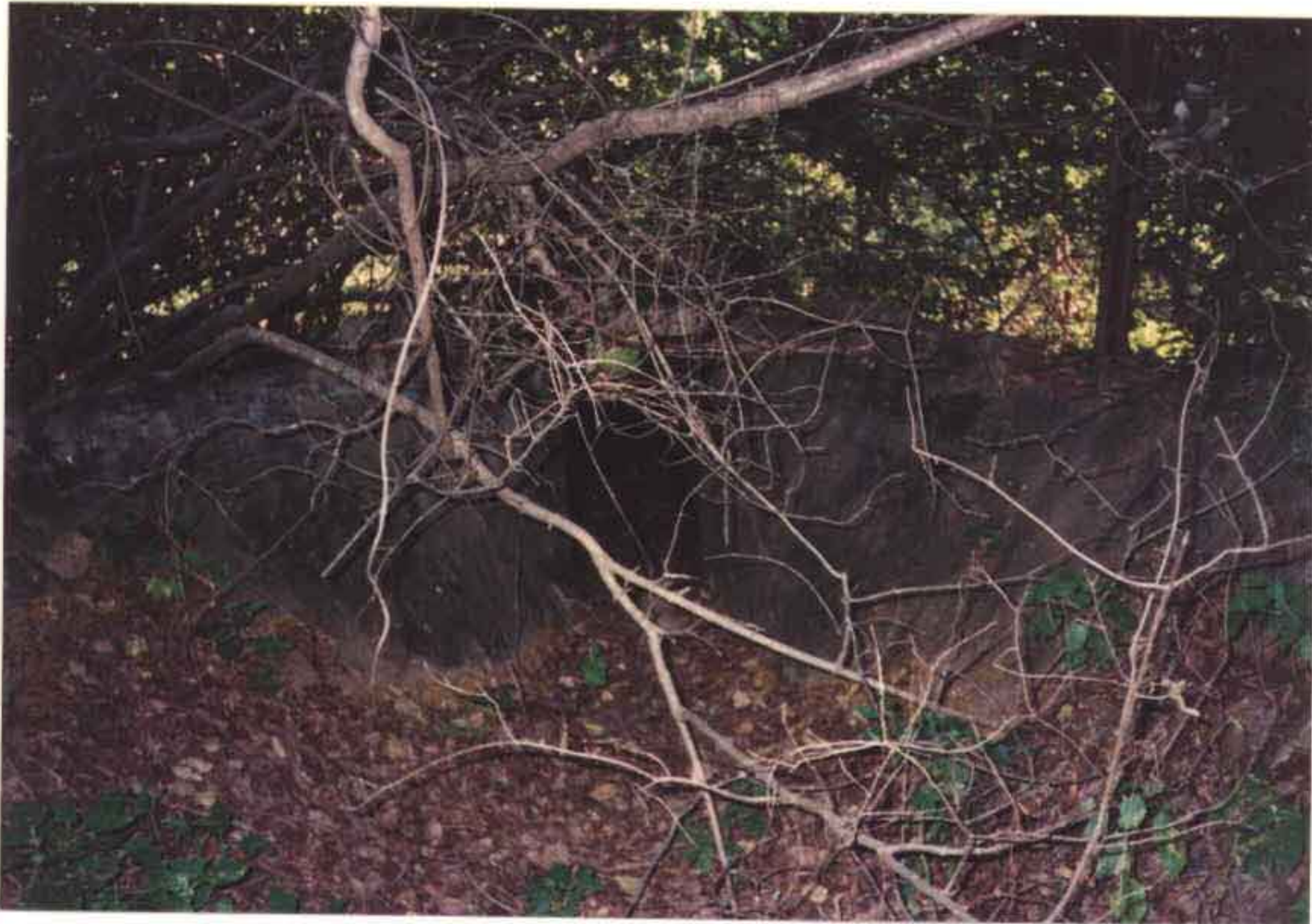
FOTO 15: Ponte canal do canal P_1 de onde foi tirada a foto anterior no Km 15 após seu início. Neste ponto não passa água, uma vez que o canal foi destruído alguns metros antes.
