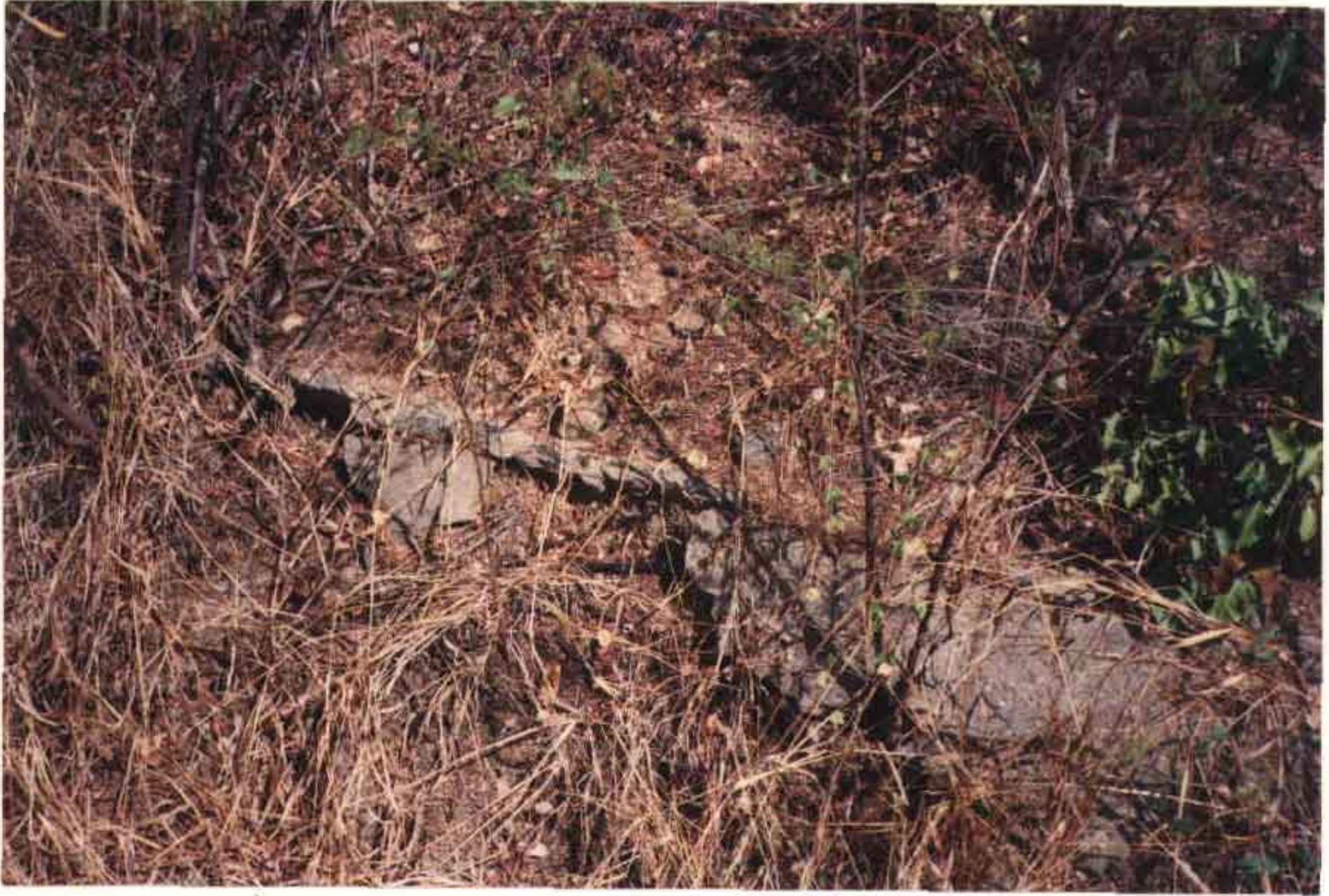
FOTO 36: Trecho com revestimento em péssimo estado. Em diversos trechos ao longo deste canal ocorre este problema.
