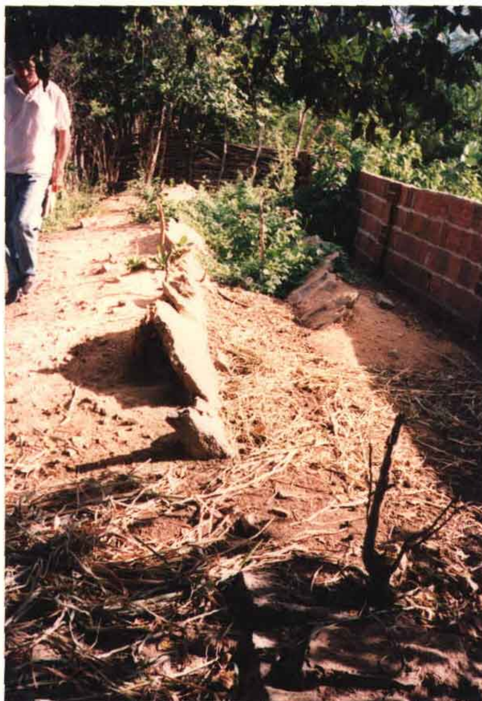
FOTO 17: Final do canal P_1 . Observar sua completa destruição.
