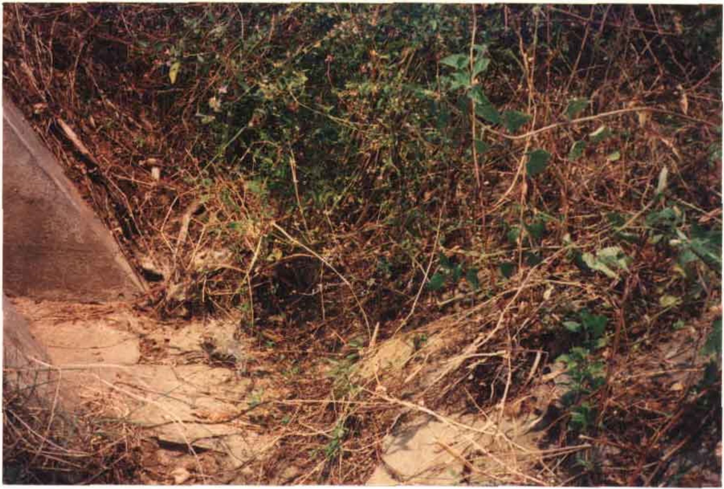
FOTO 30: Tomada T_{41} do canal P_3 . A partir desta tomada, o canal encontra-se obstruído pela vegetação que se desenvolve nos taludes e no interior do canal.
