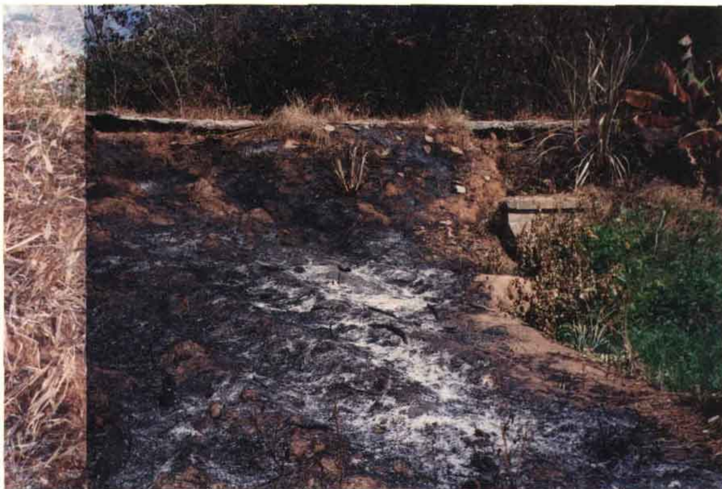
FOTO 34: Aspecto de outro trecho do canal A_1P_3 com evidente marca da erosão devido ao transbordamento da água do canal.
