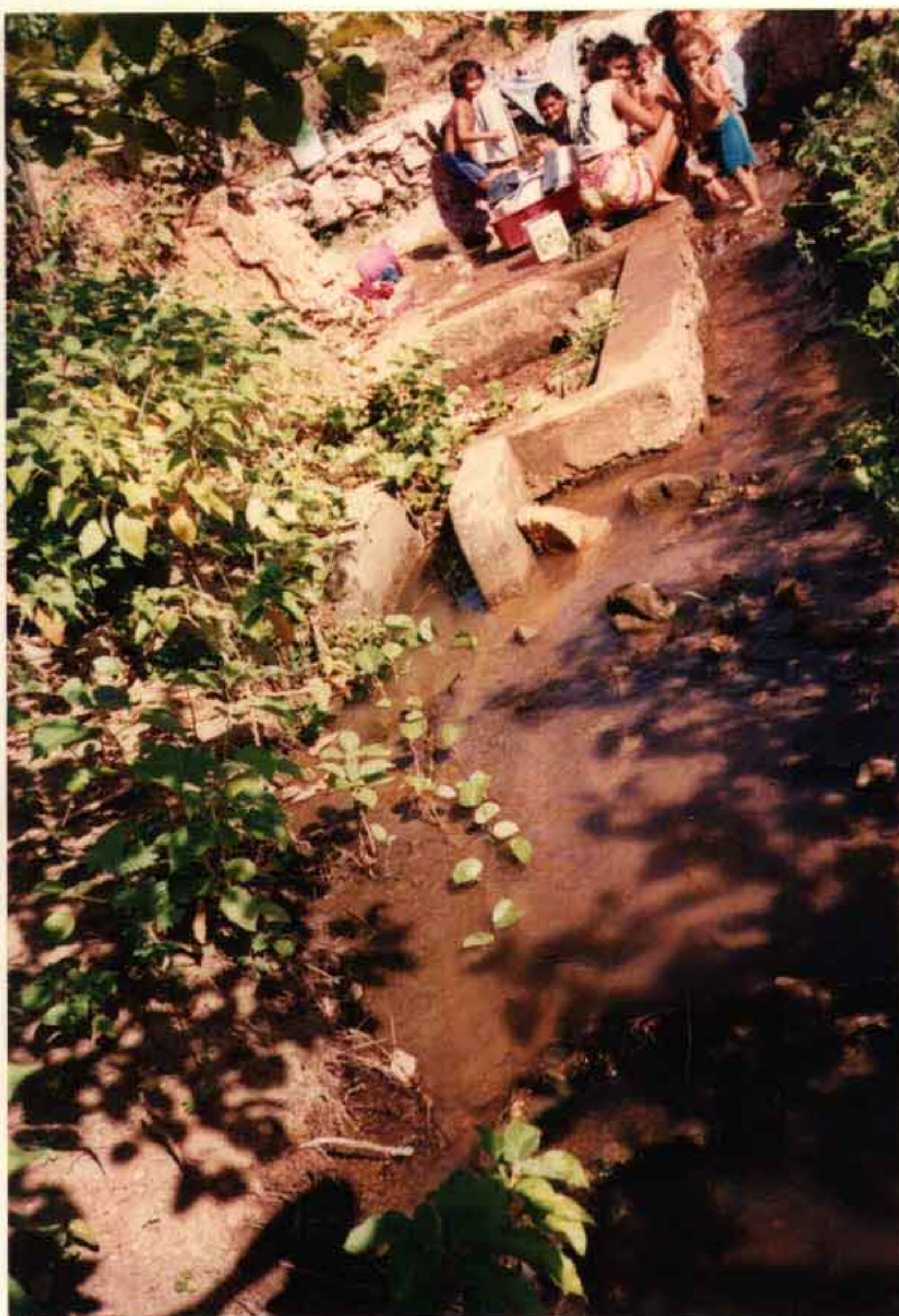
FOTO 21: Ponto onde termina o fluxo de água do canal principal P_2 , no Km 1,1 após seu início. Observa-se que a tomada de derivação encontra-se totalmente assoreada e as acéguas foram arrancadas. A água neste início de canal secundário é utilizada apenas pelas lavadeiras.
