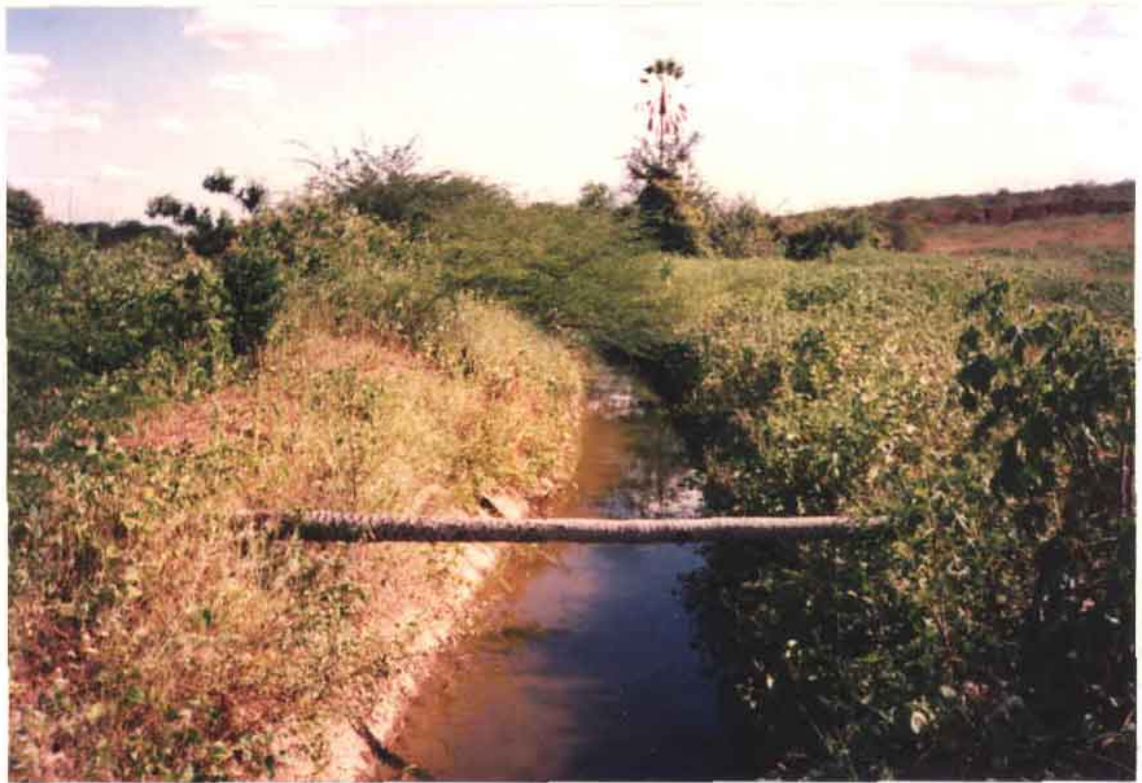
FOTO 02: Densa vegetação nas margens do canal P 1 . Observa-se no talude à esquerda da foto o revestimento precisando de reparo em pequeno trecho. Isso ocorre com frequência ao longo dos canais.
