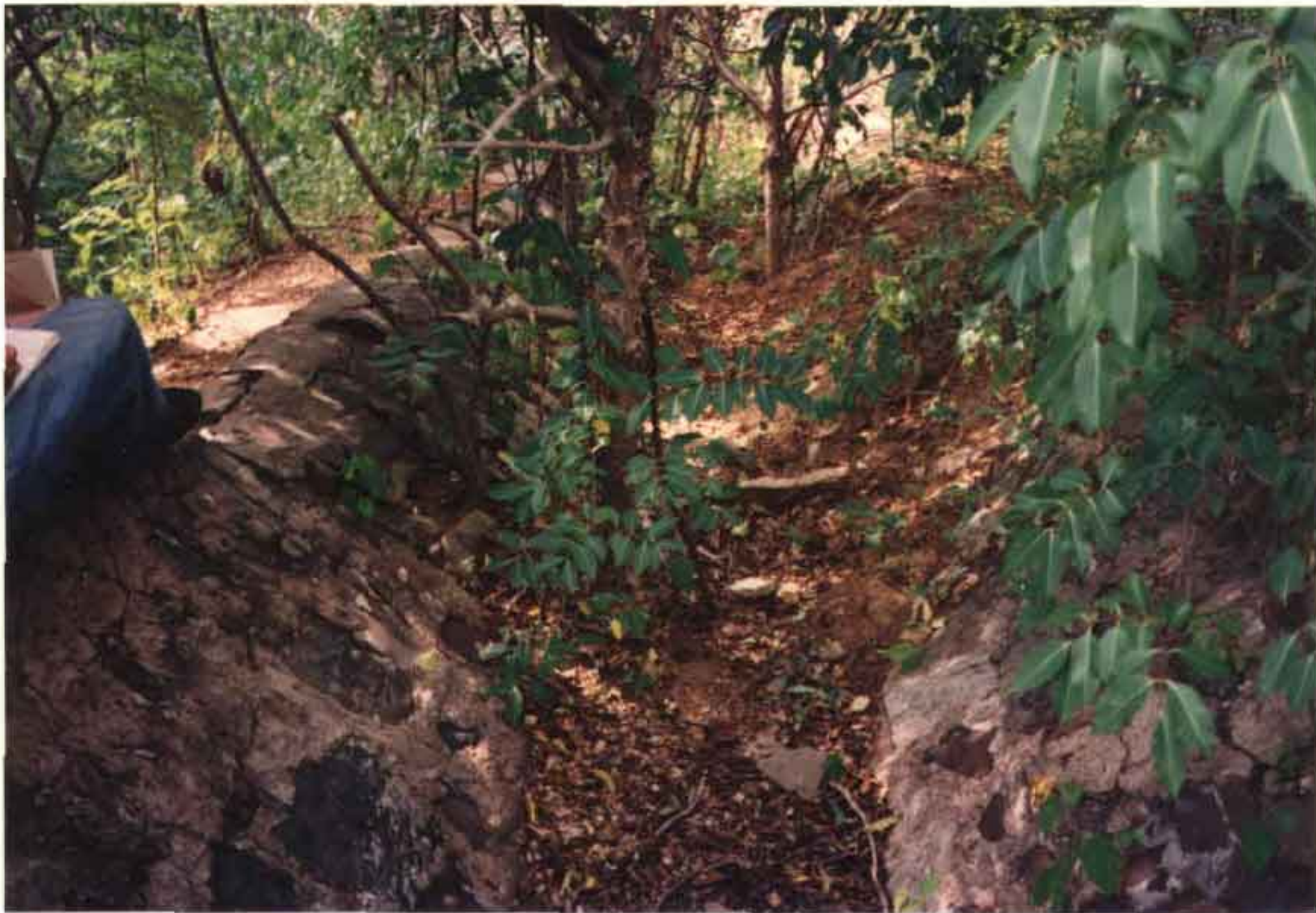
FOTO 24: Detalhe do canal P_2 logo após a ponte canal (foto anterior). Observar o estado regular do revestimento dos taludes e o intenso assoreamento do fundo do canal. Observar também que árvores de grande porte se desenvolvem no interior do canal.
