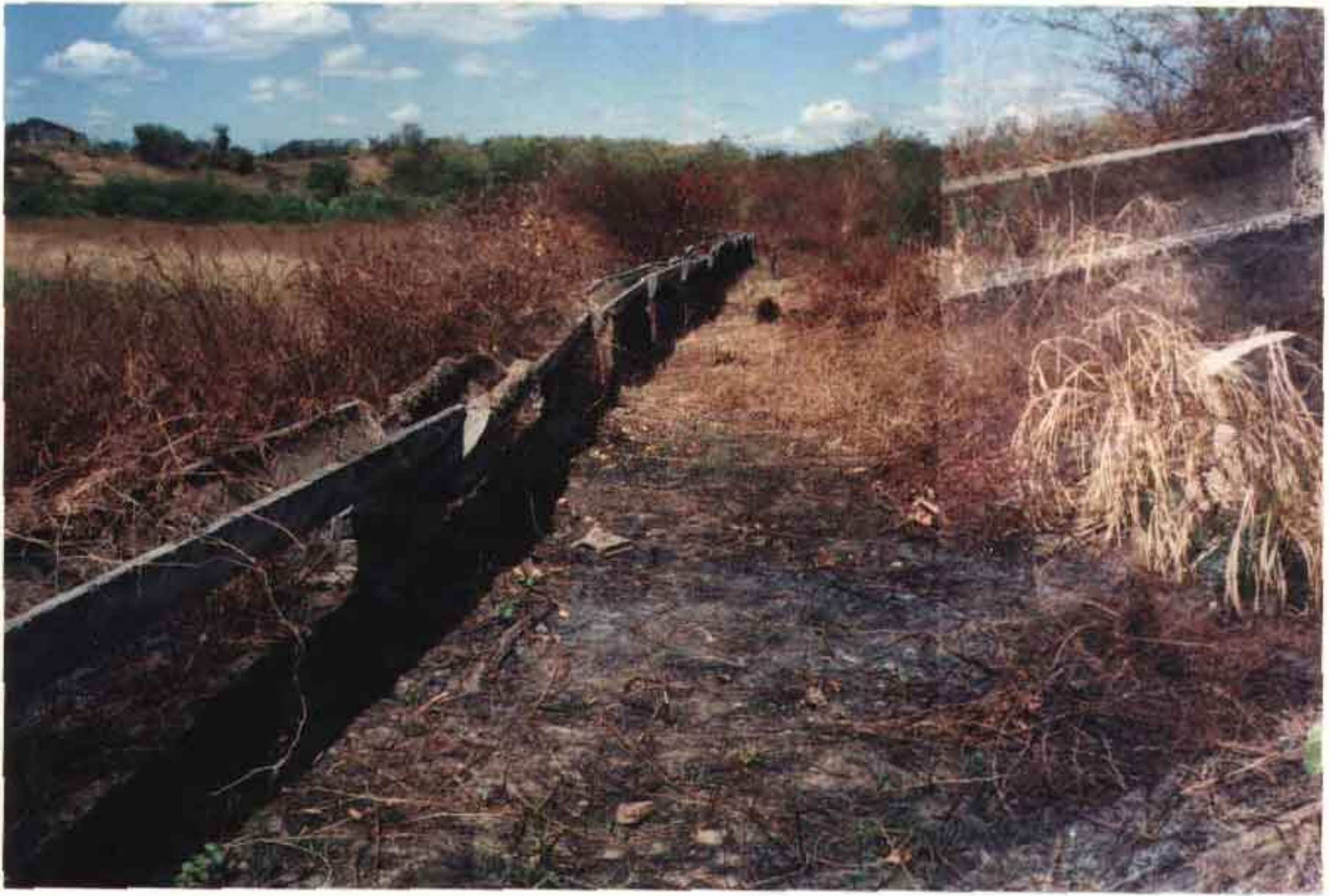
FOTO 32: Trecho de acéguas que saem da tomada T_{41} do canal P_3 , precisando de reparos. Há necessidade de substituição do berço, alinhamento e nivelamento das acéguas.
