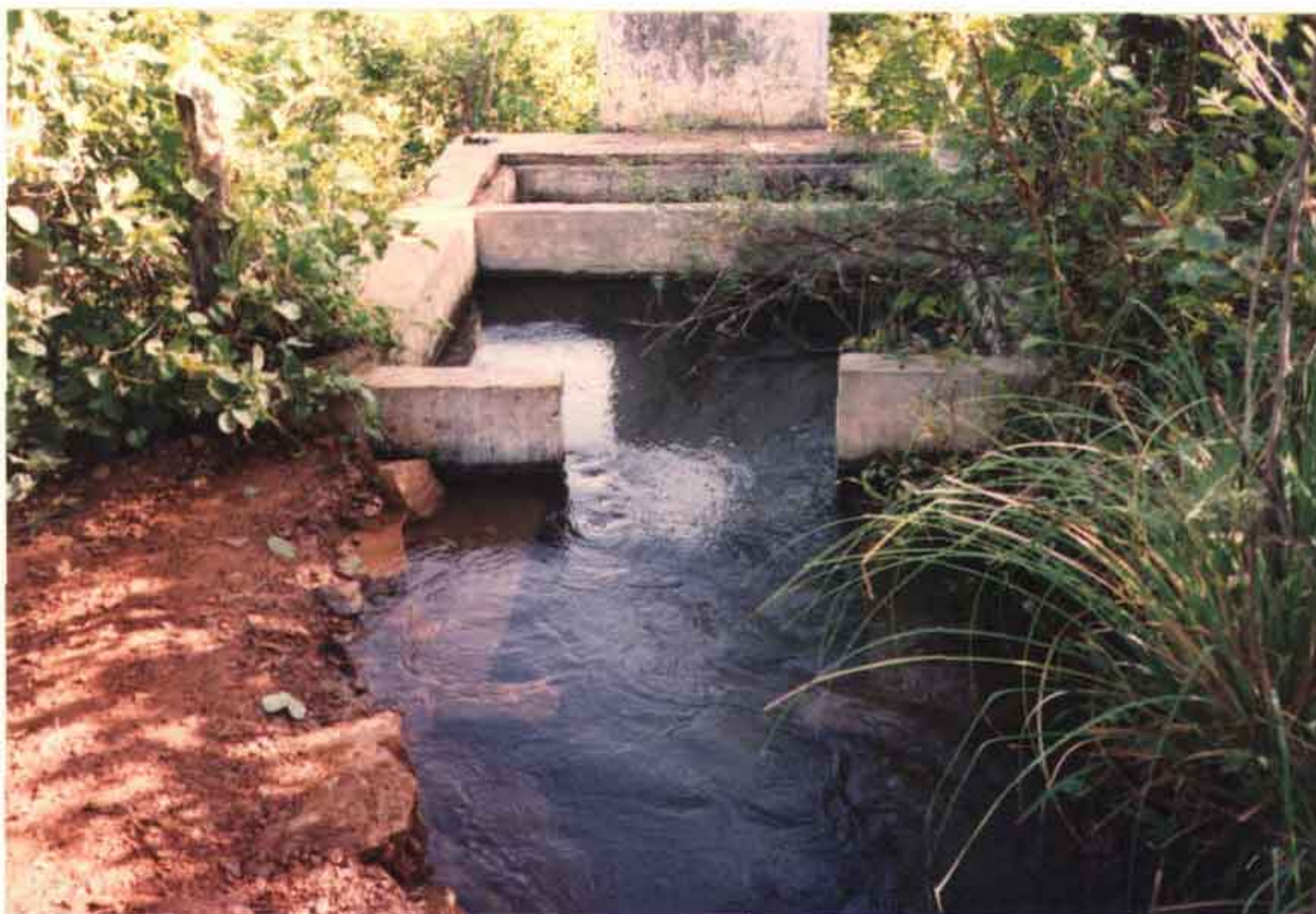
FOTO 19: Caixa de chegada do sifão que sai do canal principal P_1 para o canal principal P_2 . Como não há comportas na entrada da caixa do canal principal P_1 , a água chega a essa caixa sem nenhum controle, afogando completamente o início do canal P_2 .
