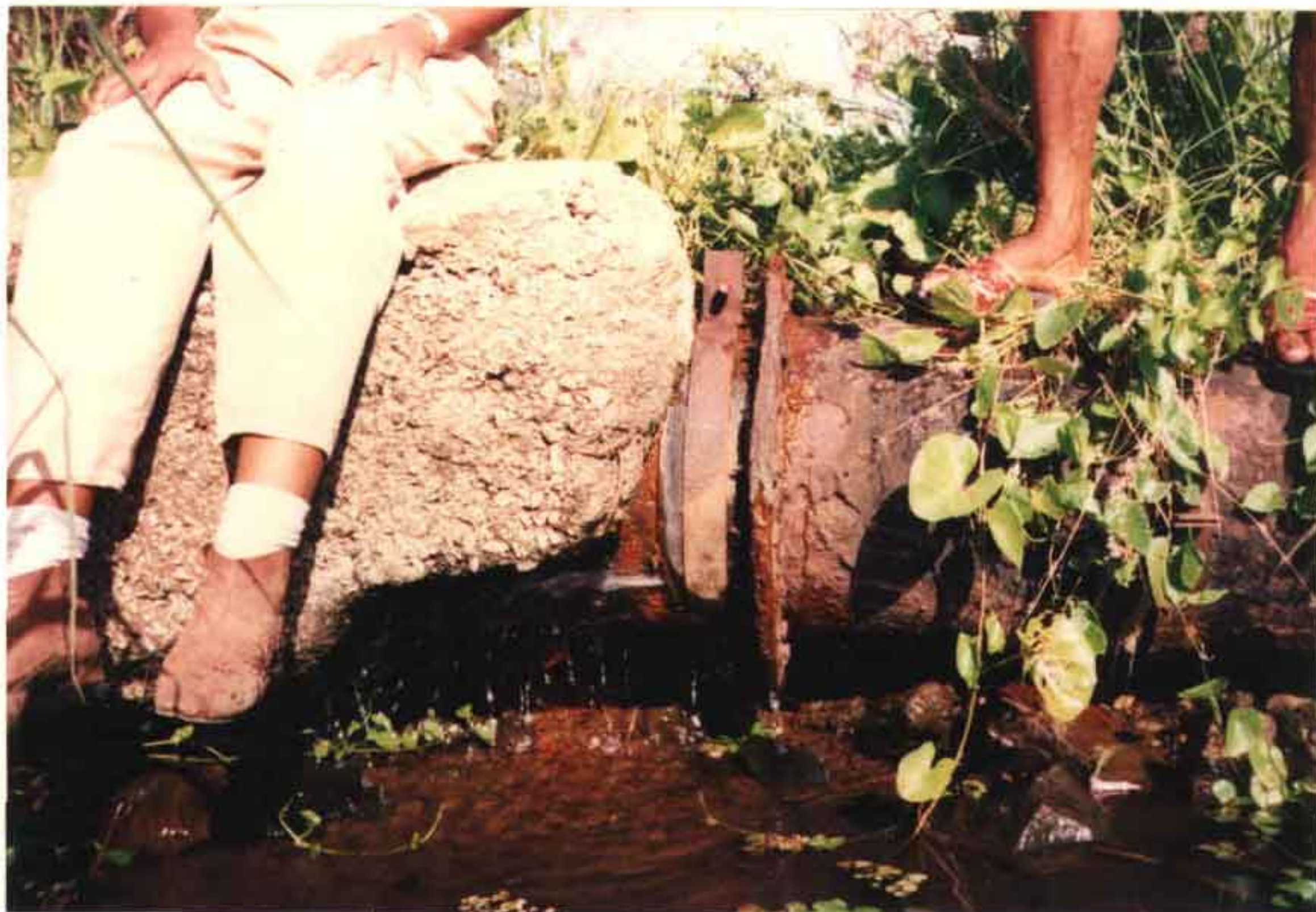
FOTO 18: Vazamento do sifão que liga o canal principal P_1 para o canal principal P_2 . Os irrigantes tentaram em vão corrigir este vazamento utilizando borracha envolvida por abraçadeiras.
