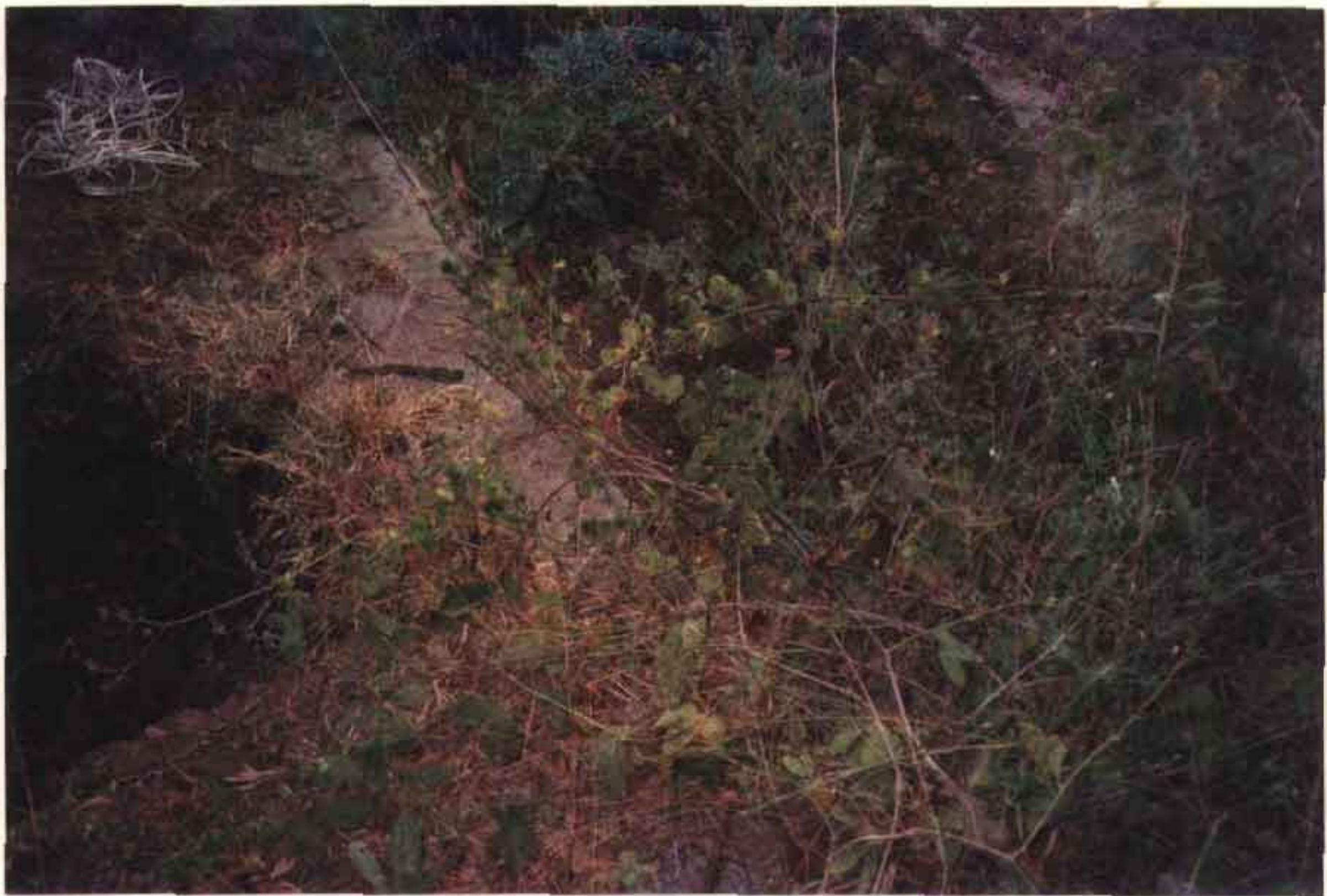
FOTO 37: Destruição do talude do canal causada pela infiltração da água. Observa-se também grande quantidade de vegetação no interior do canal.
