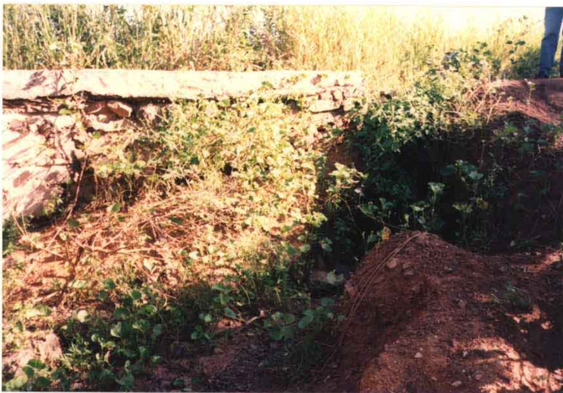
FOTO 10: Margem esquerda externa do canal P_1 , logo após o trecho fotografado anteriormente. Observa-se a destruição do talude do canal em um trecho de 7 metros.
