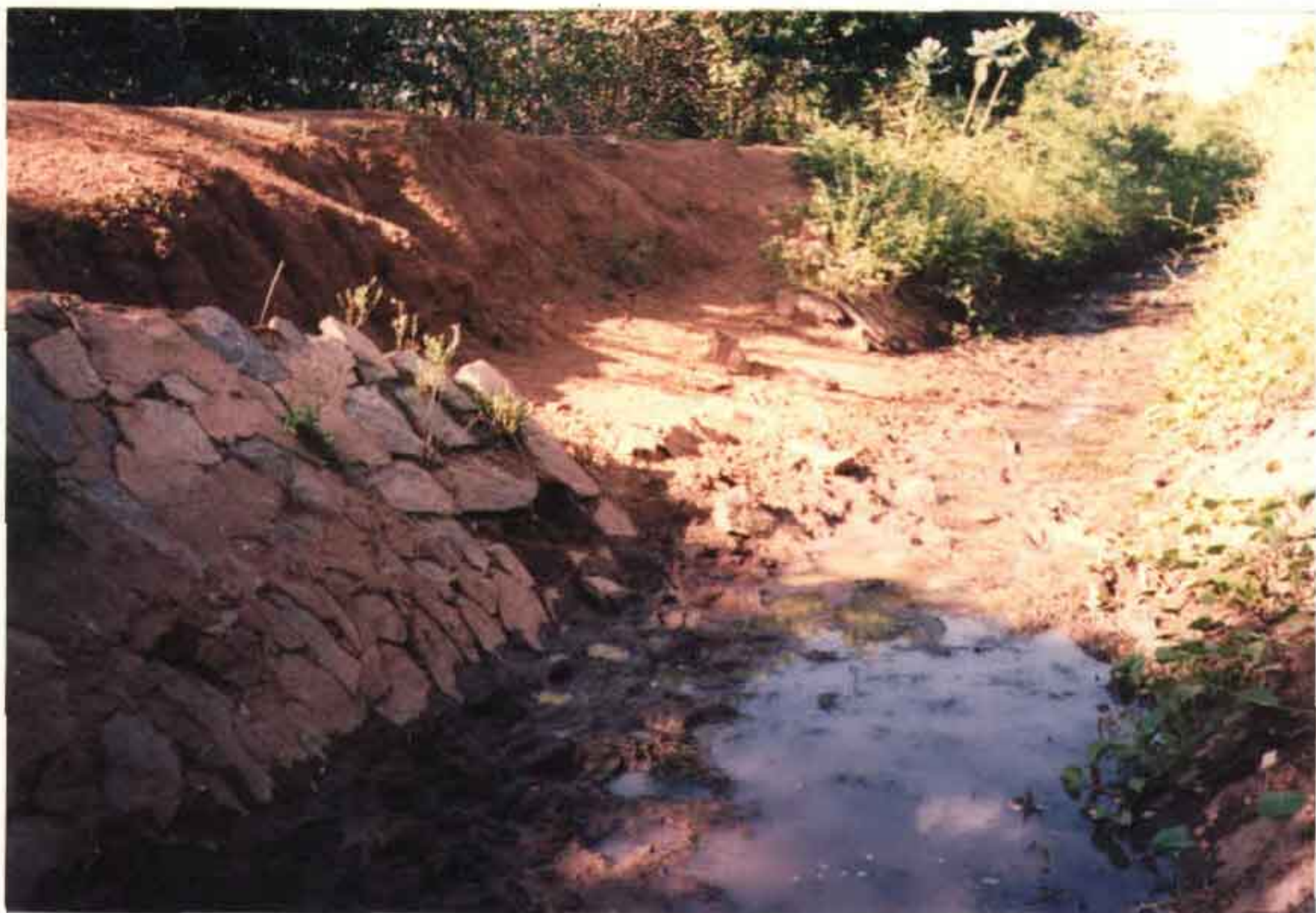
FOTO 09: Vista de montante no mesmo local da foto anterior, mostrando o trecho erodido.
