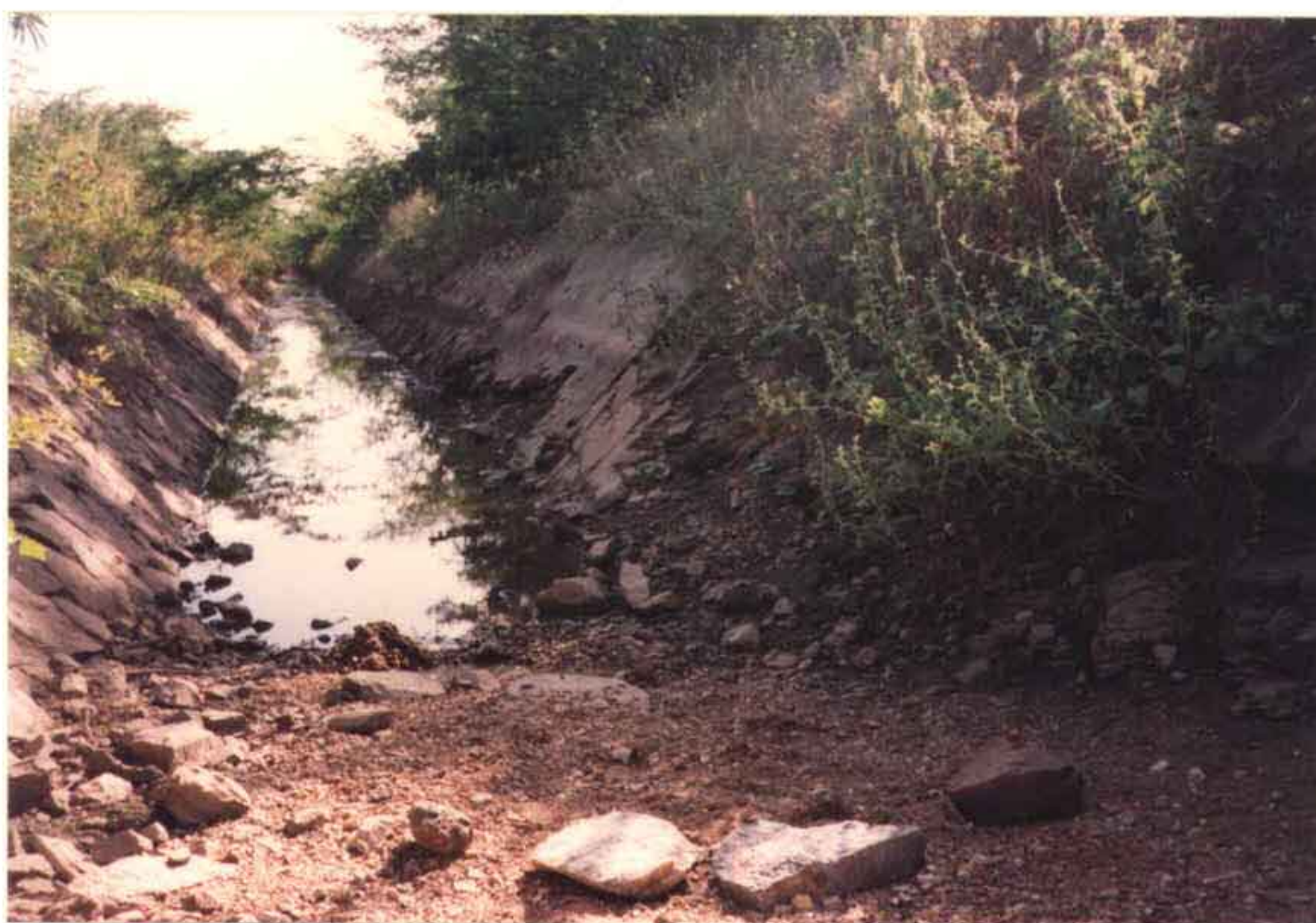
FOTO 11: Destruição do revestimento do canal P_1 , no Km 11,7 após seu início.
