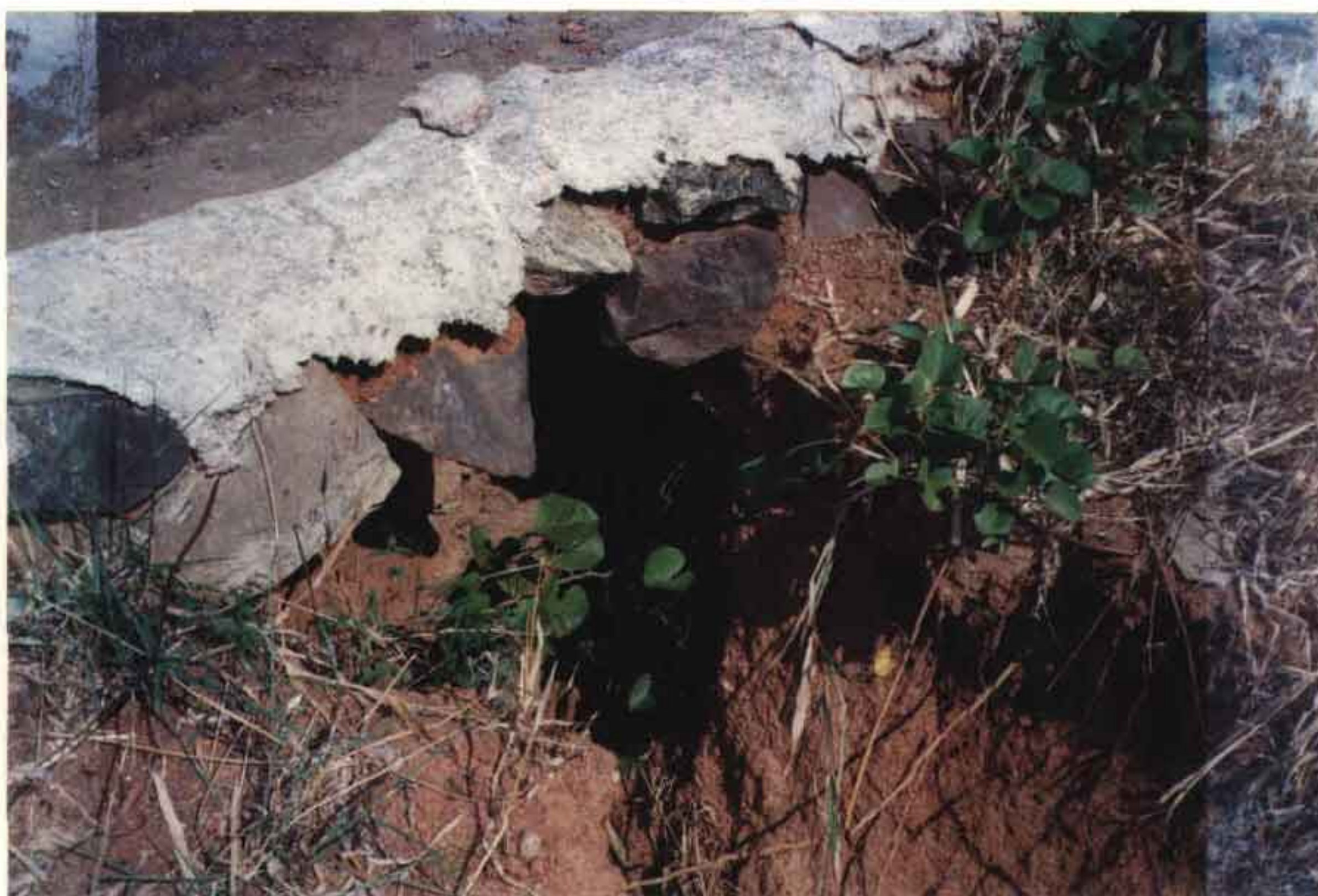
FOTO 35: Detalhe da foto anterior, mostrando o descalçamento do revestimento.
