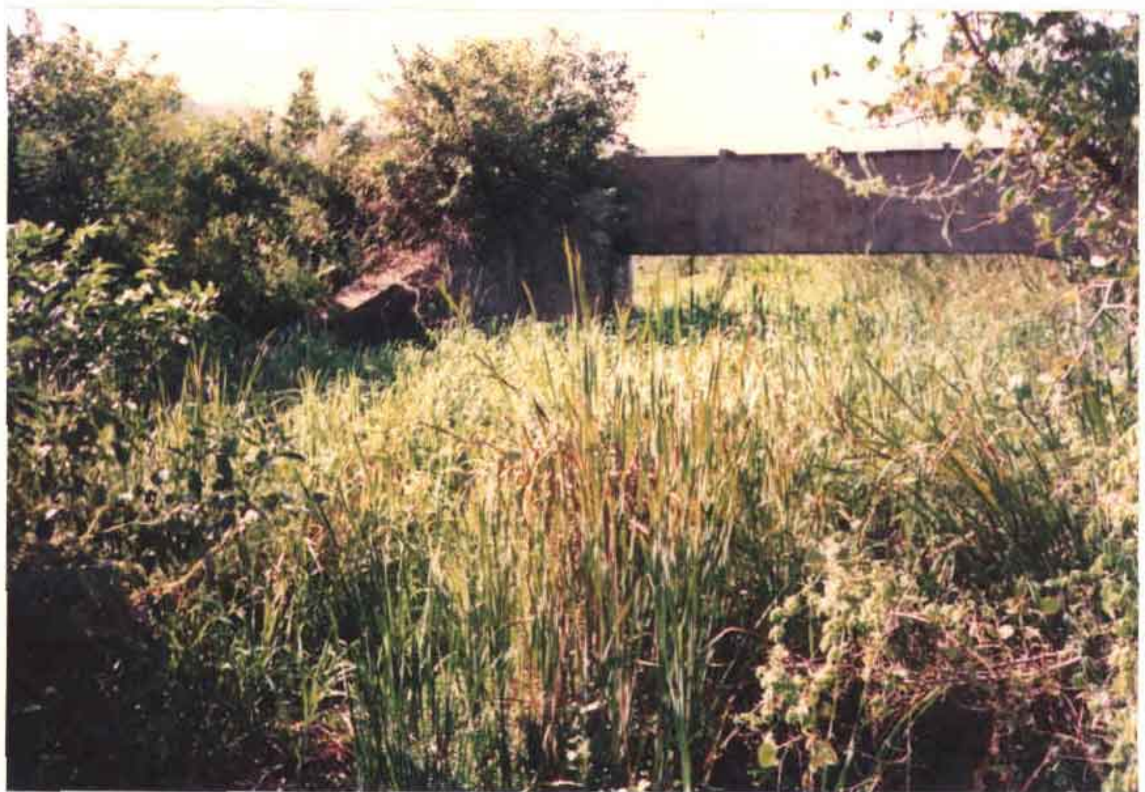
FOTO 03: Segunda ponte canal do canal principal P 1 . Observa-se intenso vazamento de água no encontro canal/ponte canal, possibilitando o nascimento do viçoso capim sob a ponte.
