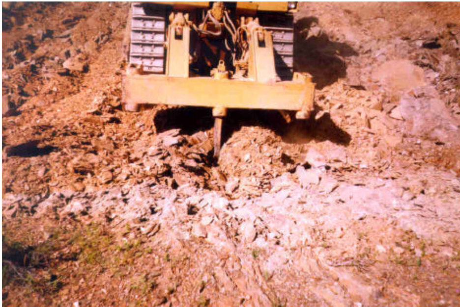
Foto 10 – Detalhe escarificação paralela à foliação.
