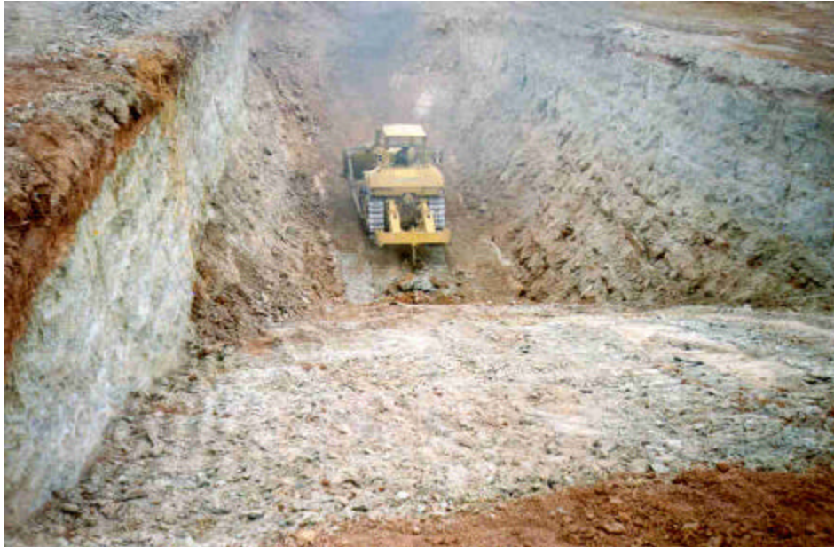
Foto 11 – Execução da trincheira com D8 provido de um dente escarificador. Material de fácil escavação.
