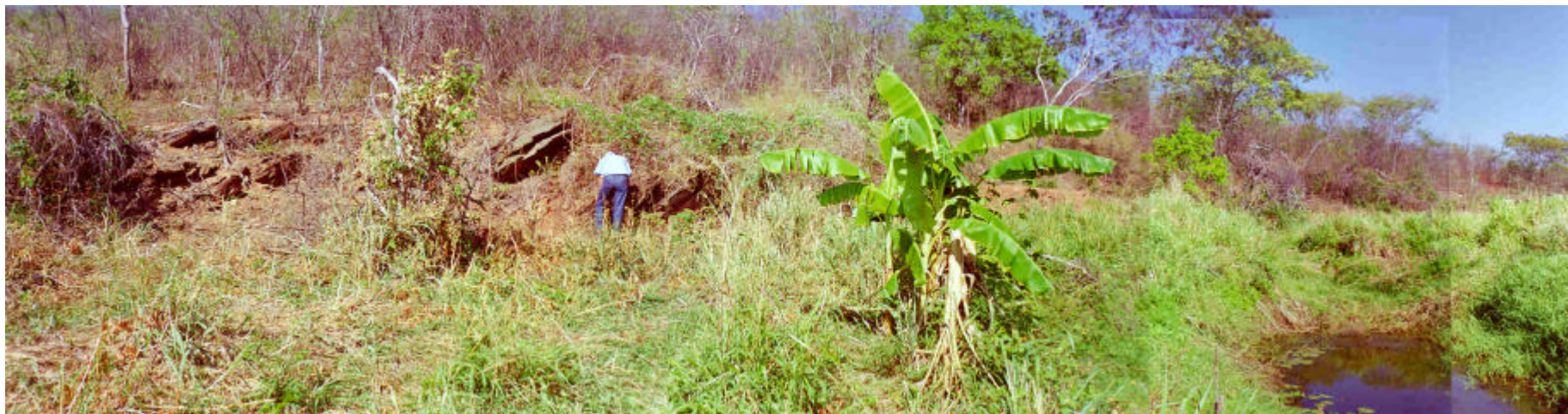
FOTO 25: Barragem Milagres - Vista da ombreira direita da barragem. Observar afloramentos de rocha no pé do talude. A lagoa (direita da foto) corresponde à uma depressão do leito do rio Milagres.
