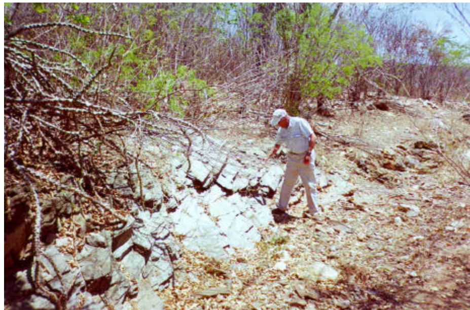
FOTO 30: Barragem Jatí - Canal de açude rompido a montante da barragem, com afloramentos de filito.
