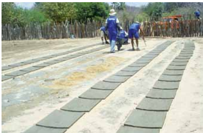
Foto 4 – Placas de cimento das paredes da cisterna Fonte: Equipe técnica do PRODHAM.
