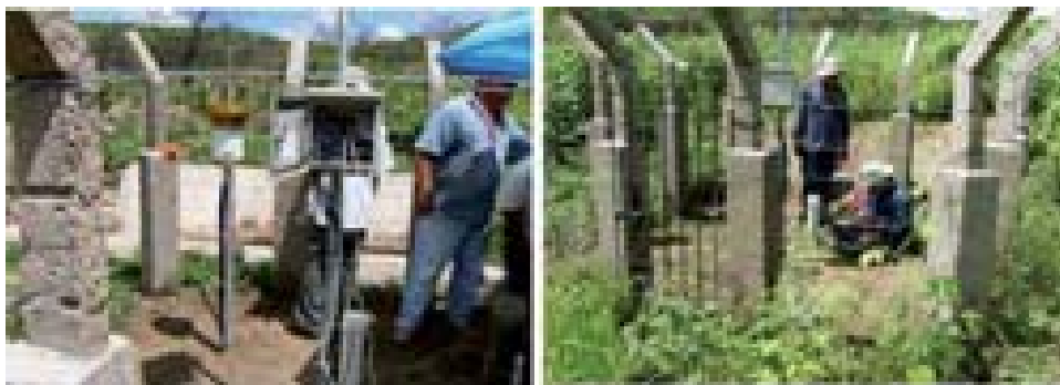
FOTO 2.06 – Instalação da PCD na calha 02, e realização de coleta de dados e avaliação da calibração do equipamento.
