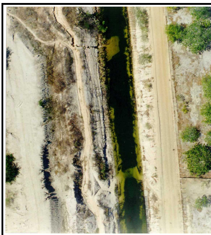
Foto 34/44 - Desencadeamento de processos erosivos nos taludes internos do Canal do Trabalhador, provocando o seu assoreamento e comprometendo a sua capacidade de adução. Tal situação pode ser verificada em diversos pontos ao longo do canal, sendo este um dos trechos onde o problema apresenta-se mais grave.
