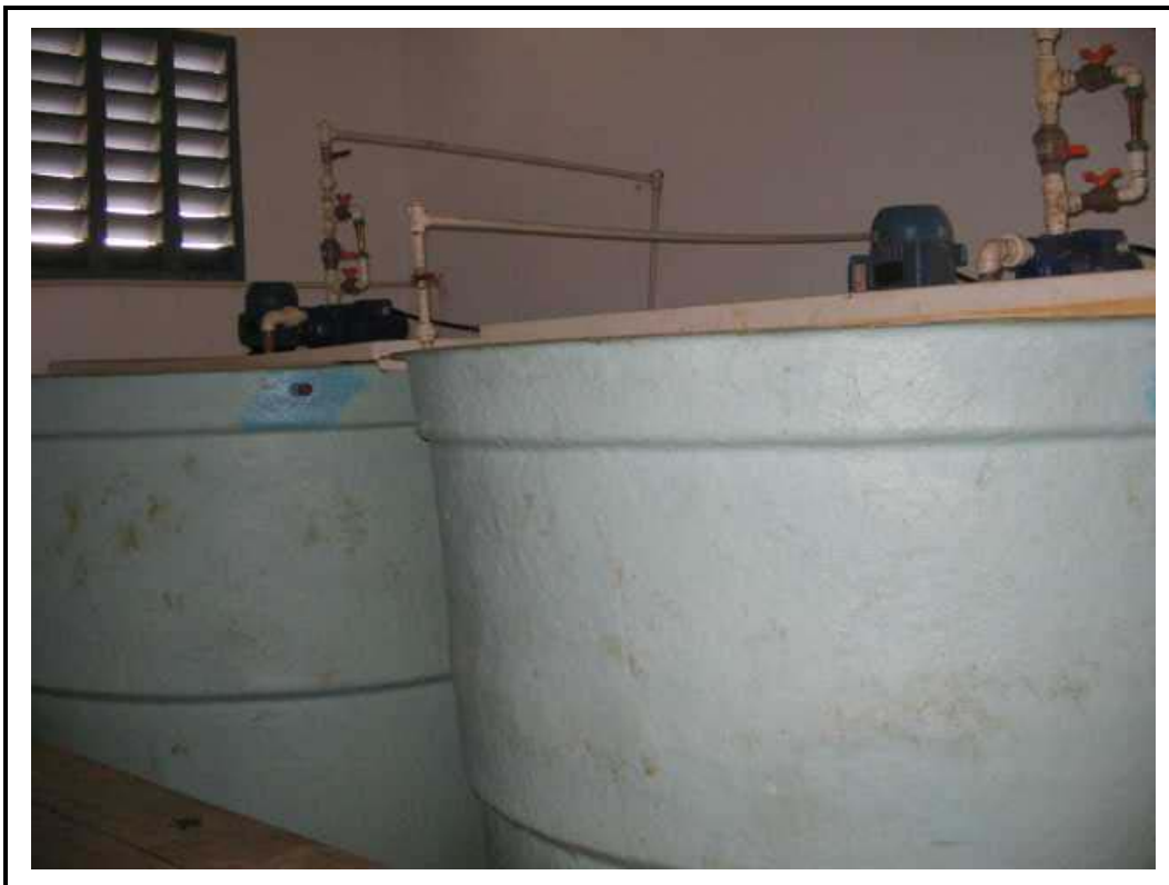
Foto 11A - Tanques de mistura de produtos químicos.
