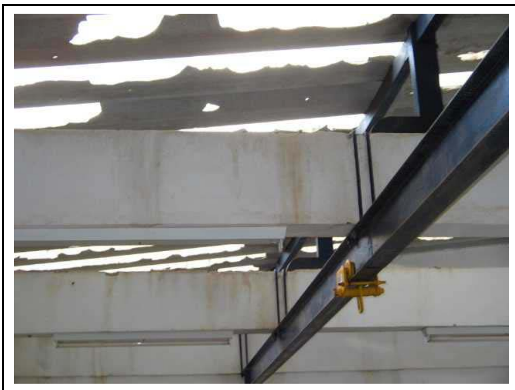
Foto 34 - Teto da EE5 destruído (vandalismo).
