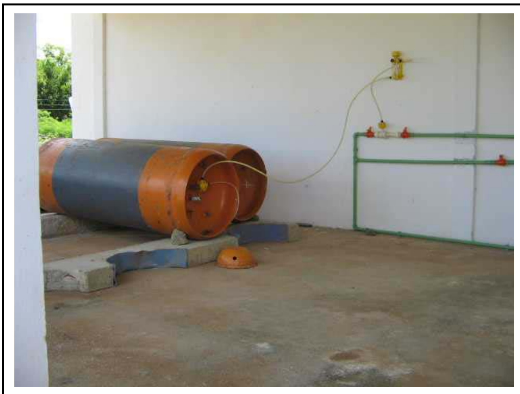
Foto 09 - Área de cloração da ETA - detalhe.
