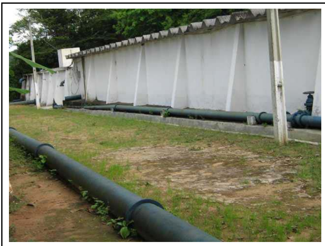
Foto D - Reservatório de distribuição da ETA de Baturité (abastece Baturité e Aracoiaba à noite).
