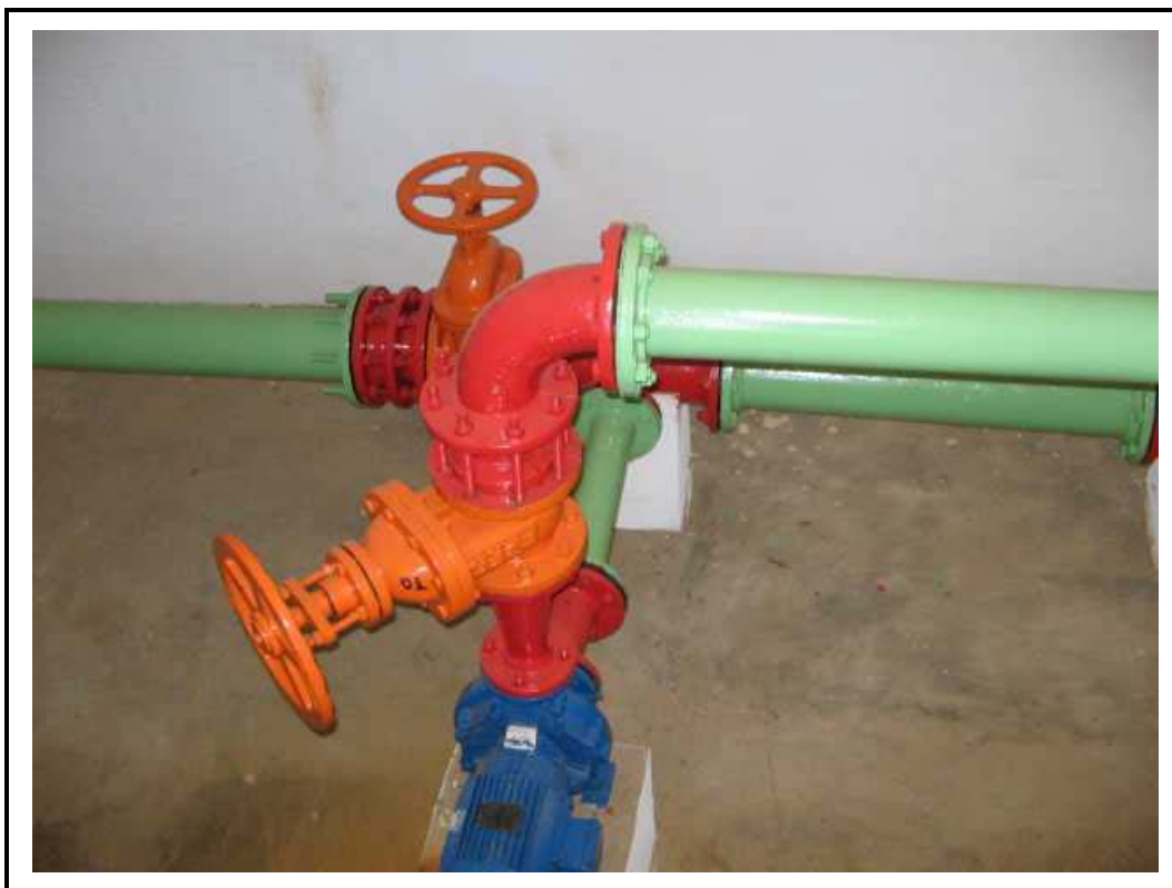
Foto 29 - Conexões para reservatório elevado em operação normal.
