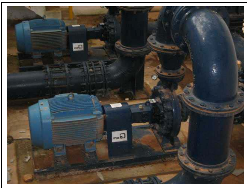
Foto 35 - Bombas da EE5 - fora de operação (deveria recalcar água recebida da EE4).
