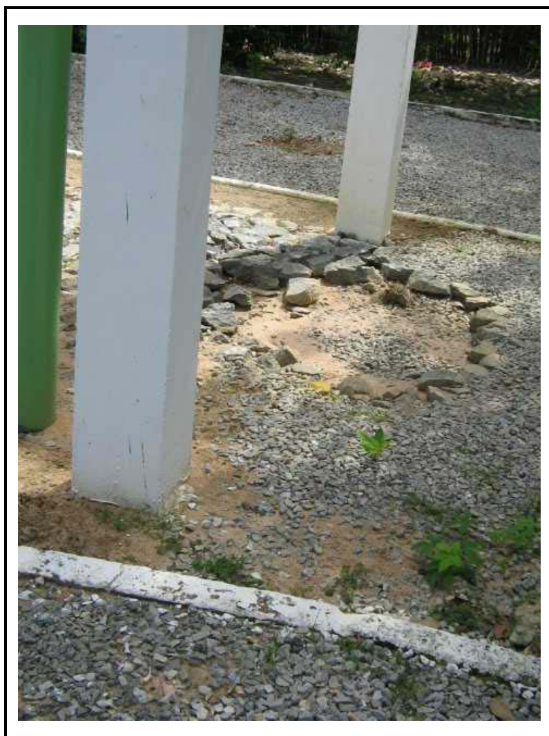
Foto 22 - Reservatório elevado em São João de Baixo. Existe constante extravasão por falta de automação.
