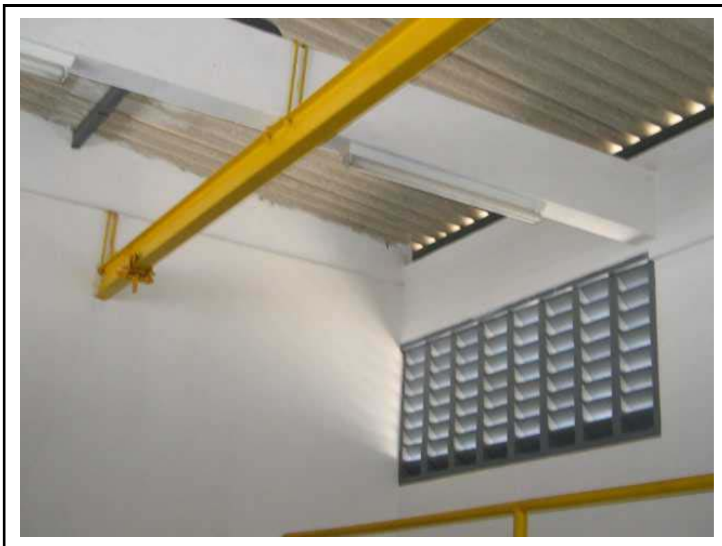
Foto 21 - EE3 - monovia sem talha.
