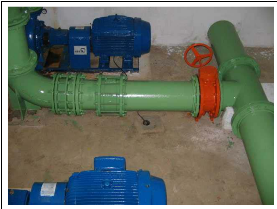
Foto 14 - Sistema de bombas em operação - pintura recente - aparência excelente.
