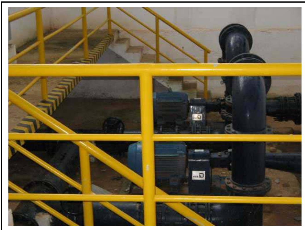
Foto 25 - EE4 - vista do equipamento.
