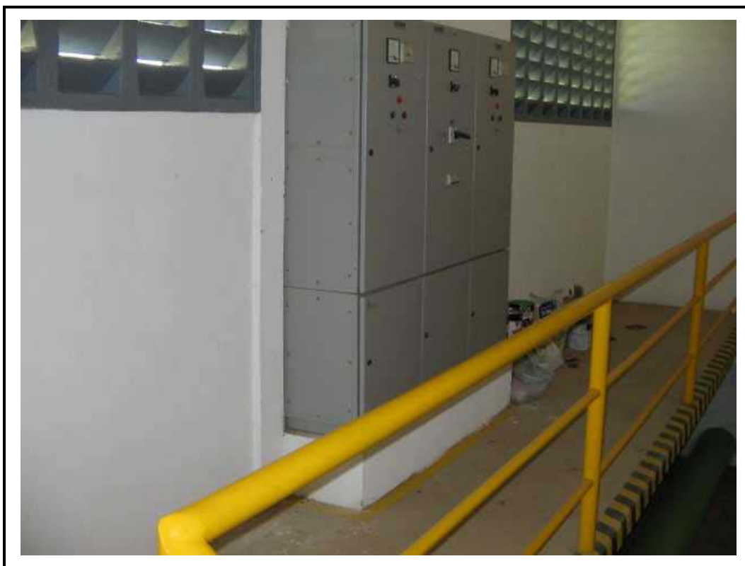
Foto 31 - Painel elétrico da EE4 (desligado).
