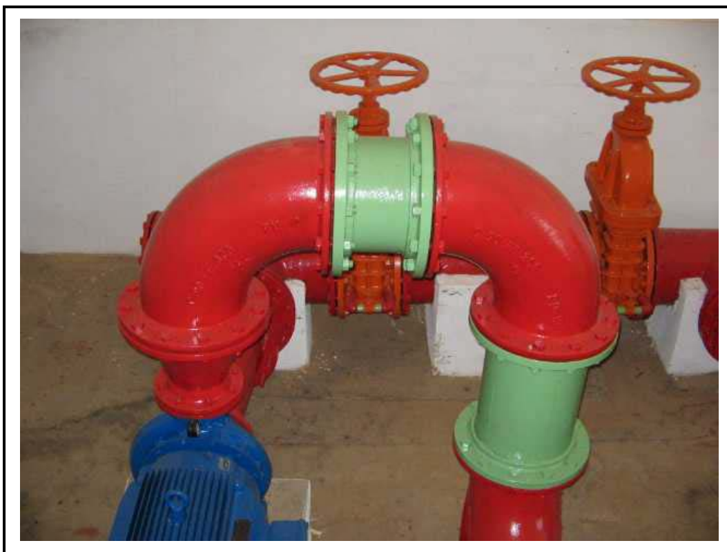
Foto 27 - EE4 - conexões internas (estação desligada) - ótimo estado de conservação.
