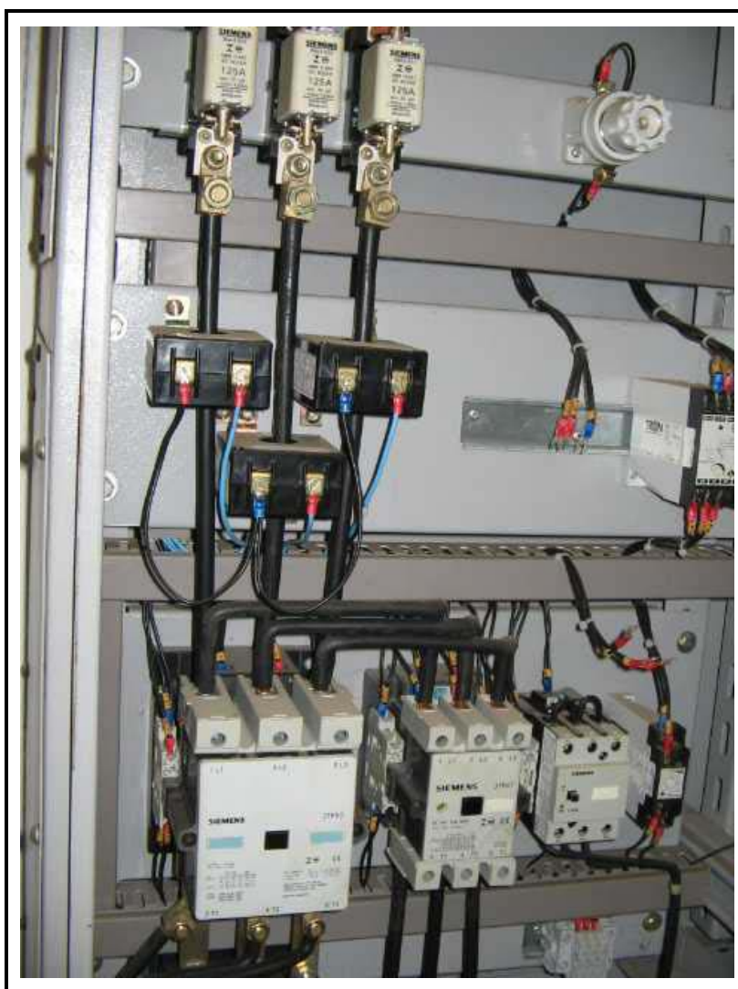
Foto 32 - Painel elétrico da EE4 (desligado).
