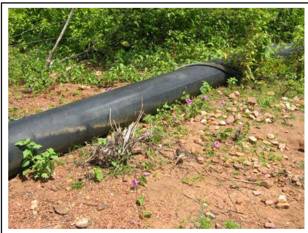
Foto 02A - Tubo PEAD que interliga o flutuante à ETA.
