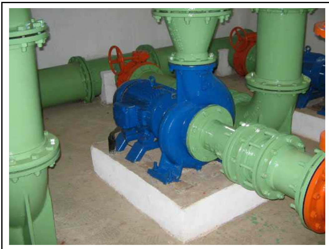
Foto 15 - Sistema de bombas em operação - pintura recente - aparência excelente.
