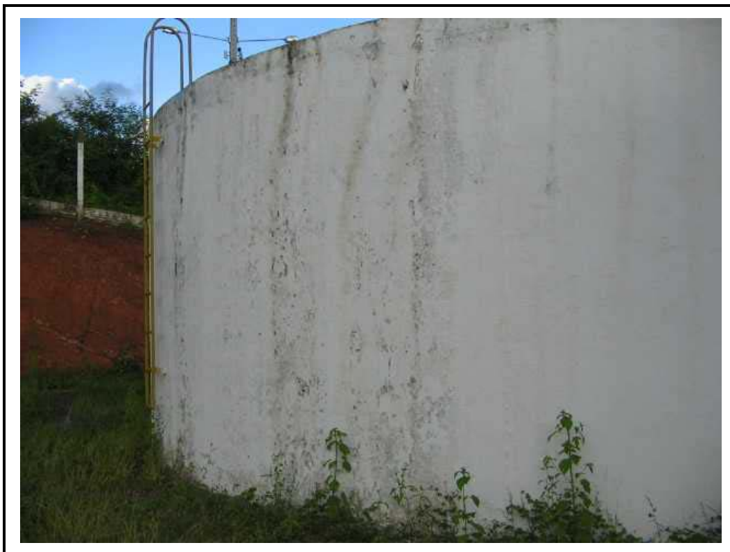
Foto 24 - Reservatório apoiado, onde chega à adutora de Aracoiaba.
