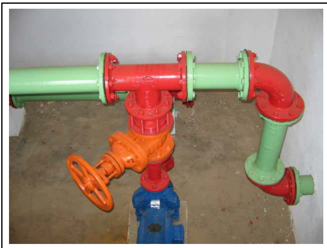
Foto 30 - Conexões para reservatório elevado em operação normal (abastece Aracoiaba durante o dia).
