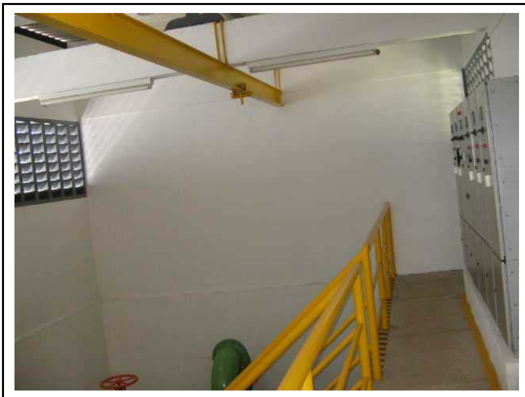
Foto 17 - Painel elétrico da EE2 e monovia sem talha (pouca ou nenhuma utilidade).
