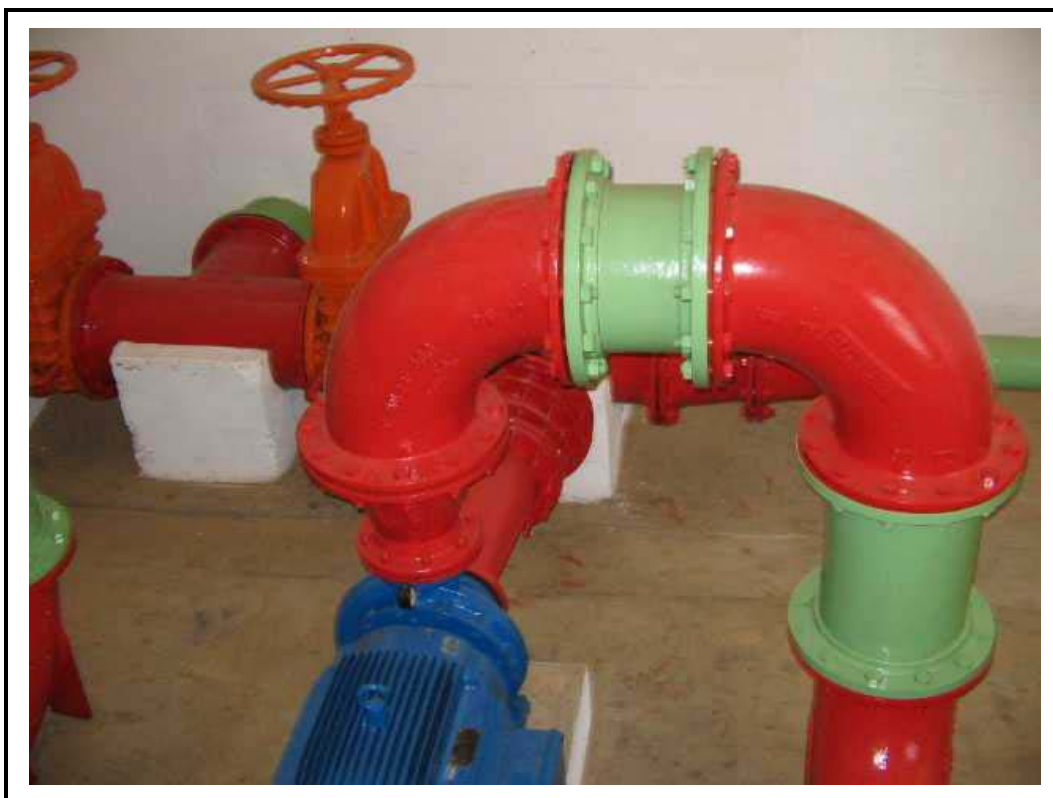
Foto 26 - EE4 - conexões internas (estação desligada) - ótimo estado de conservação.
