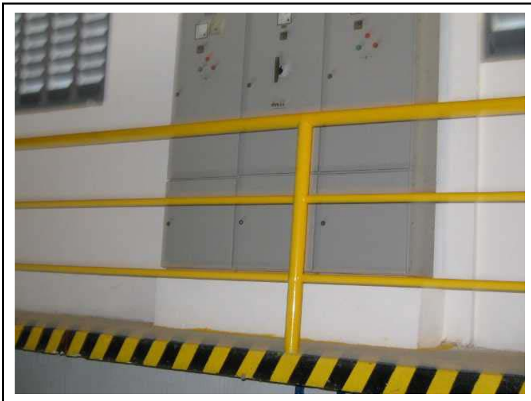
Foto 20 - EE3 - painel de comando das bombas.
