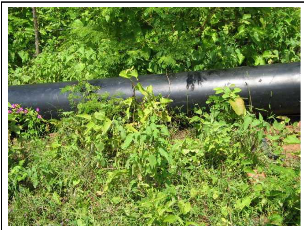
Foto 02B - Tubo PEAD. Nota-se que não existe apoio adequado no solo.
