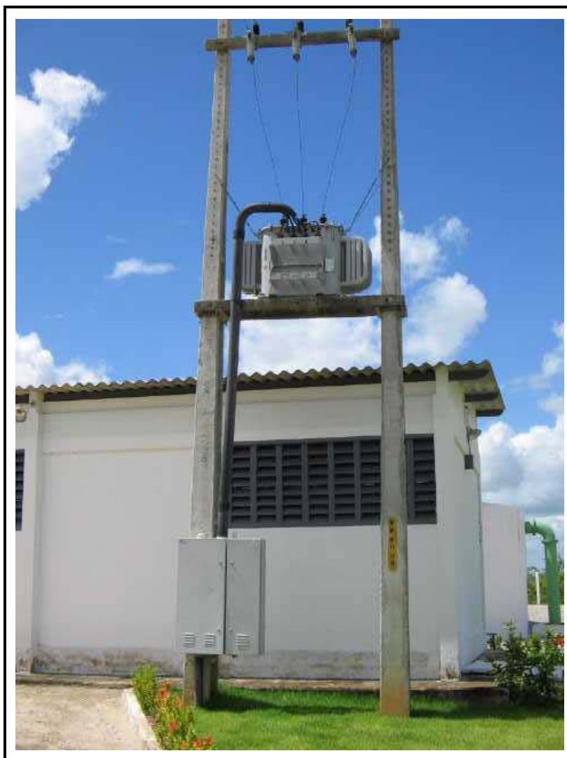
Foto 12A - Transformadores da ETA (nota-se painel de comando ao relento).
