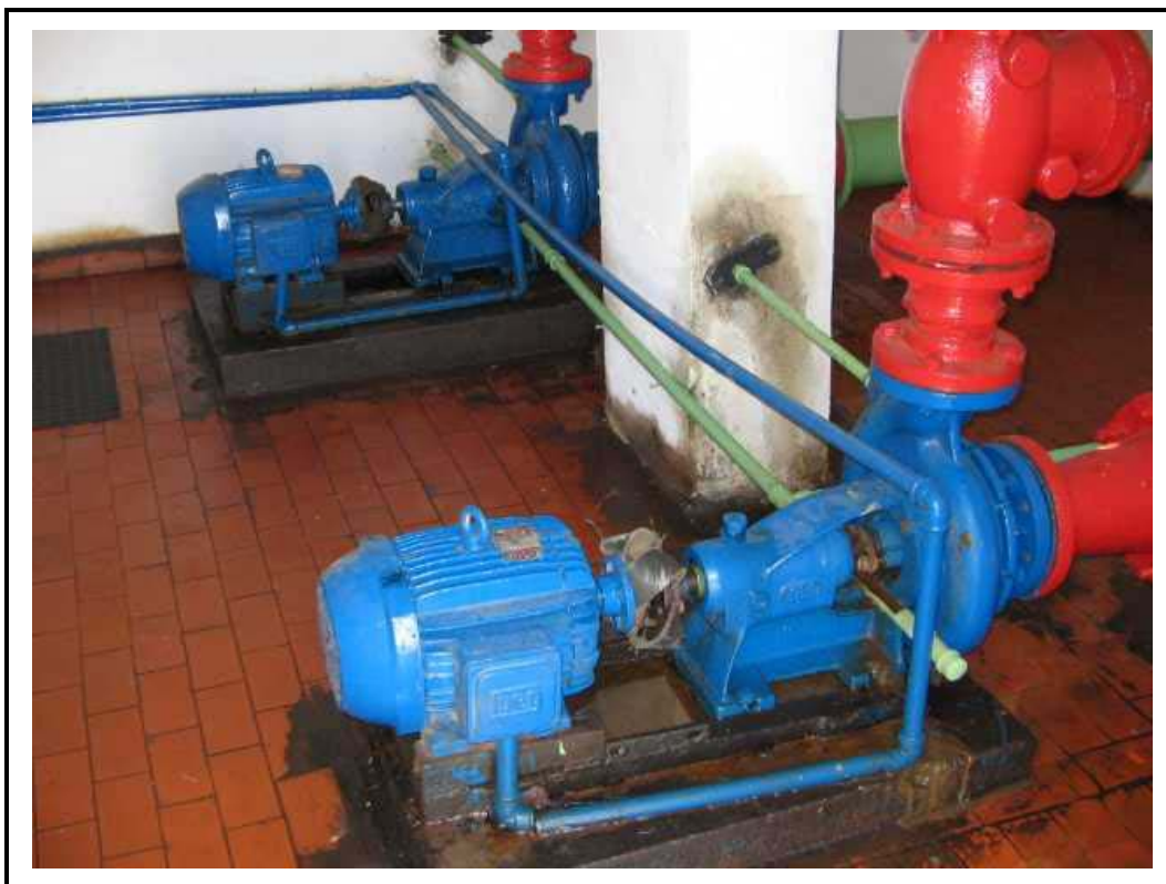
Foto 16 - Bombas de lavagem dos filtros da ETA.
