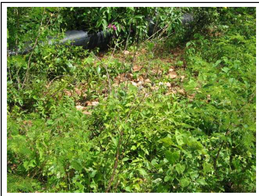
Foto 02C - Tubo PEAD coberto por vegetação.
