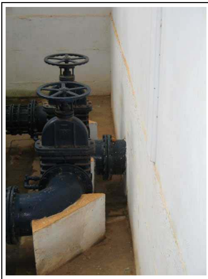
Foto 36 - Bombas da EE5 desligadas - sem qualquer manutenção.
