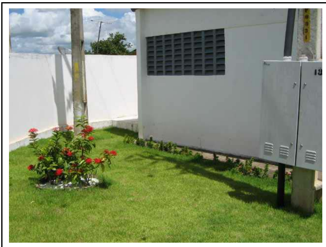
Foto 23 - EE4 - estação fora de uso (energia desligada).
