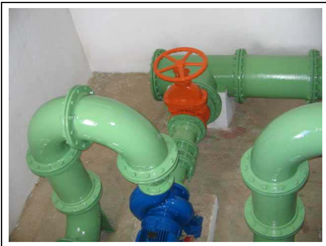
Foto 13 - Sistema de bombas em operação - pintura recente - aparência excelente.
