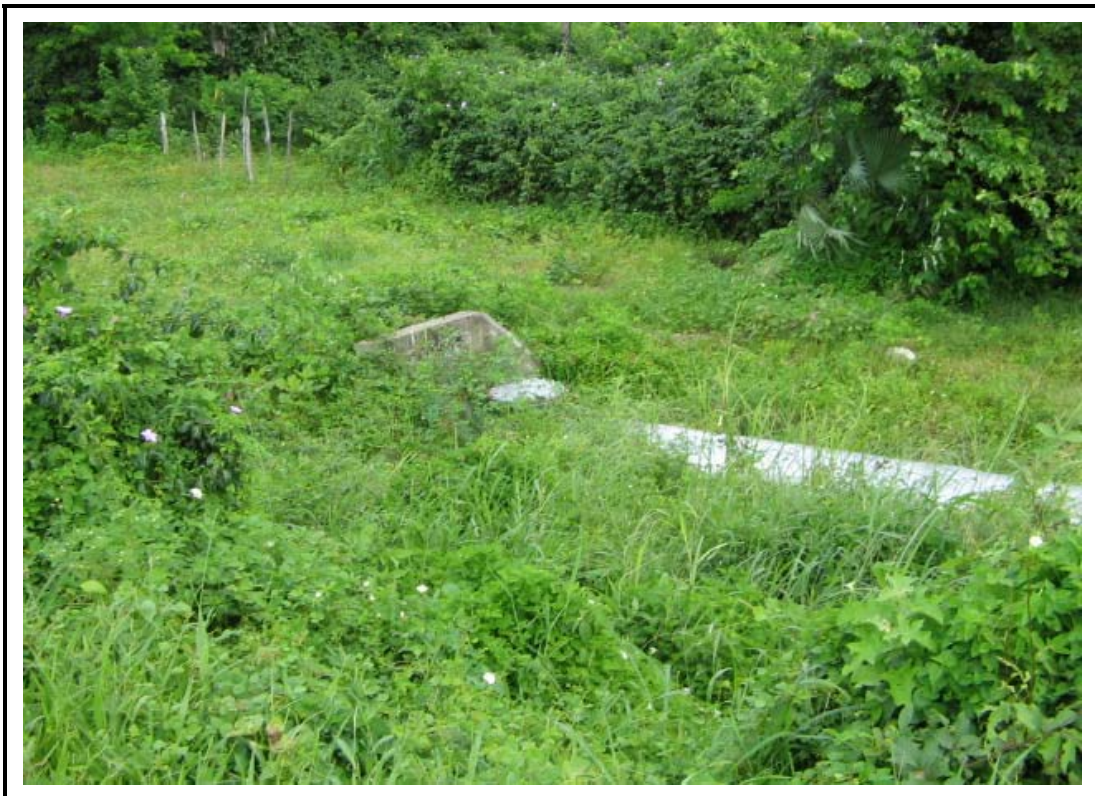
Foto 02 - Adutora praticamente coberta por vegetação.
