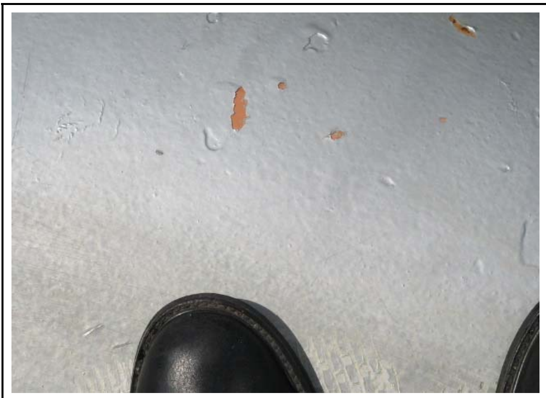
Foto 06 - Marca de impactos na superfície da adutora (é necessária constante manutenção).
