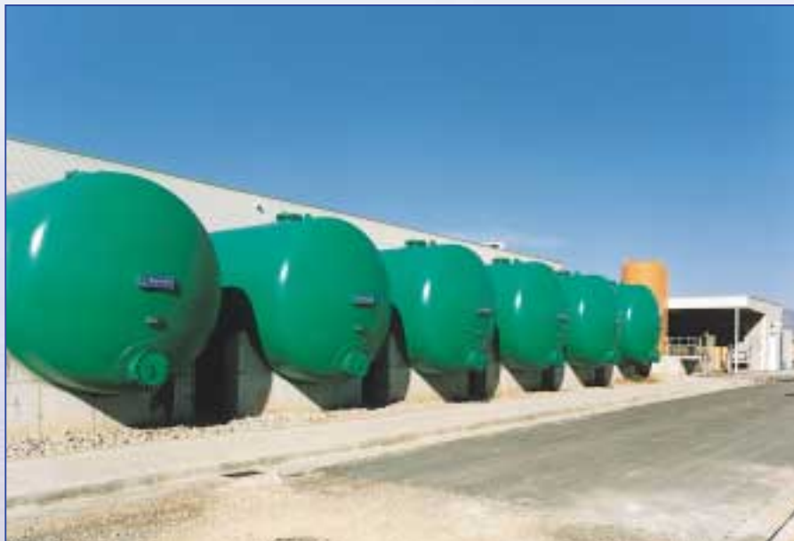
■ Filtros de arena y reactivos de pretratamiento de la desaladora Bahía de Palma.
