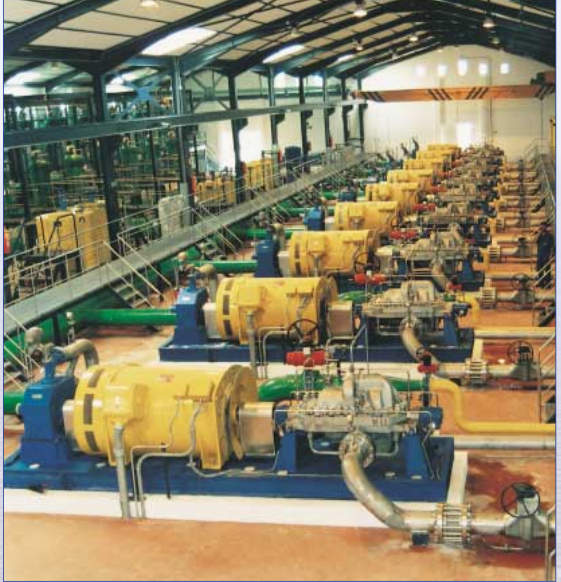
■ Vista interior del edificio de proceso de la desaladora de Marbella.
