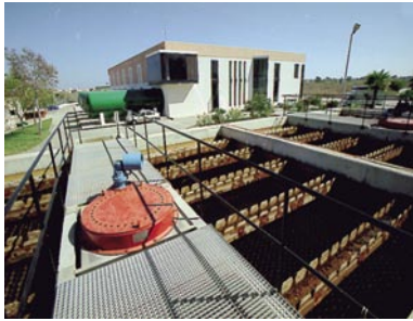
Desaladora de Denia
