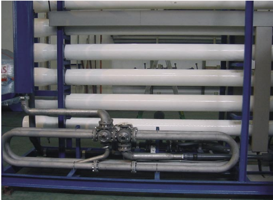
Cámara isobárica conectada a planta de ósmosis inversa
