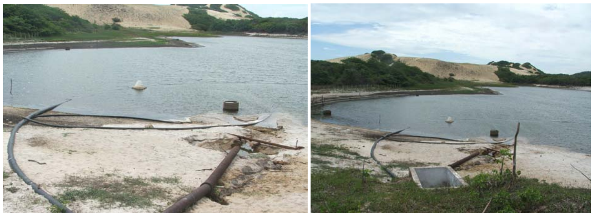
Figura 7.3 – Sistema de Captação e de Adução de Água Bruta na Lagoa do Pecém.
