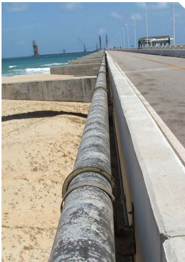
Figura 8.3 – Tubulação do Emissário da Termelétrica do Pecém
