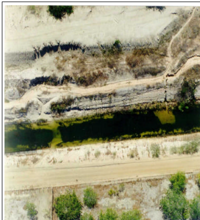
Foto 46/51 - Desencadeamento de processos erosivos nos taludes internos do Canal do Trabalhador, provocando o seu assoreamento e comprometimento da sua capacidade de adução. Tal situação pode ser verificada em diversos pontos ao longo do canal, sendo este um dos trechos onde o problema apresenta-se mais grave.
