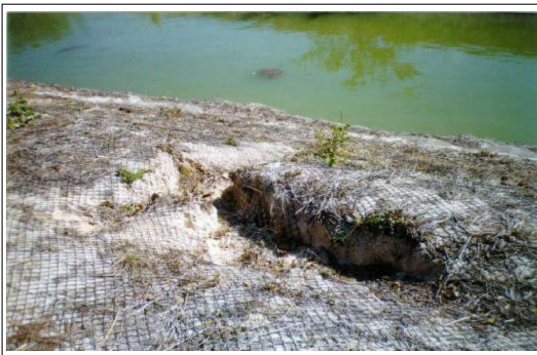
Foto 45/51 - Trecho do Canal do Trabalhador onde existia a hidro-semeadura. Observa-se o desenvolvimento de sulco de erosão.
