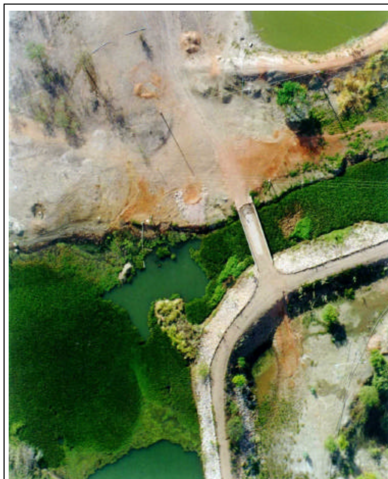
Foto 51/51 - Vista parcial do Canal do Trabalhador a cerca de 2,0 km do ponto de captação d'água na Barragem de Itaíçaba. Observa-se neste trecho o canal de adução tomado por vegetação aquática, podendo vir a ocorrer redução do fluxo d'água e obstrução de sifões e outras infra-estruturas. Caso essas plantas sejam tóxicas pode haver comprometimento da qualidade da água aduzida.
