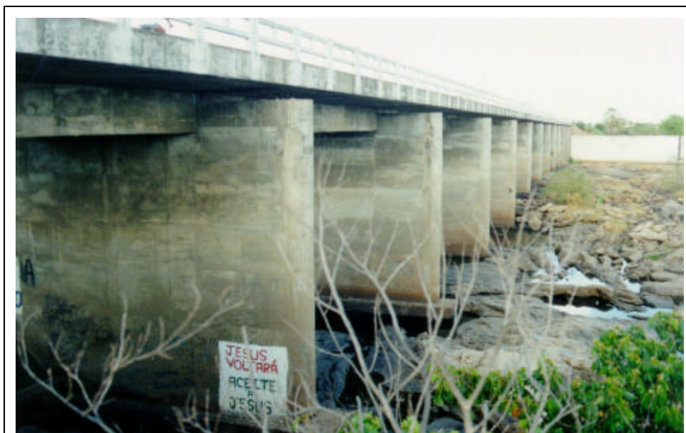
Foto 24/51 - Trecho de jusante da ponte da CE-371. O local escolhido para realizar a travessia do rio Banabuiú com tubulação sob pressão anexada a estrutura da ponte. Ao fundo e à direita, observa-se o início do canal principal do Perímetro Irrigado de Morada Nova.
