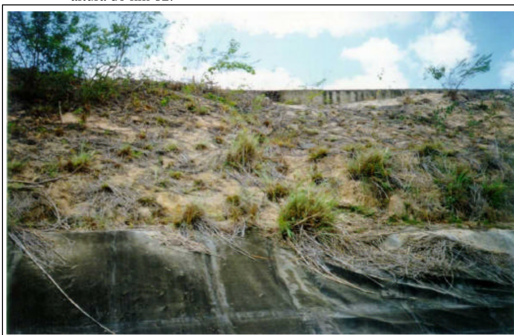
Foto 44/51 - Talude em aterro do Canal do Trabalhador com ocorrência de colapso do solo.
