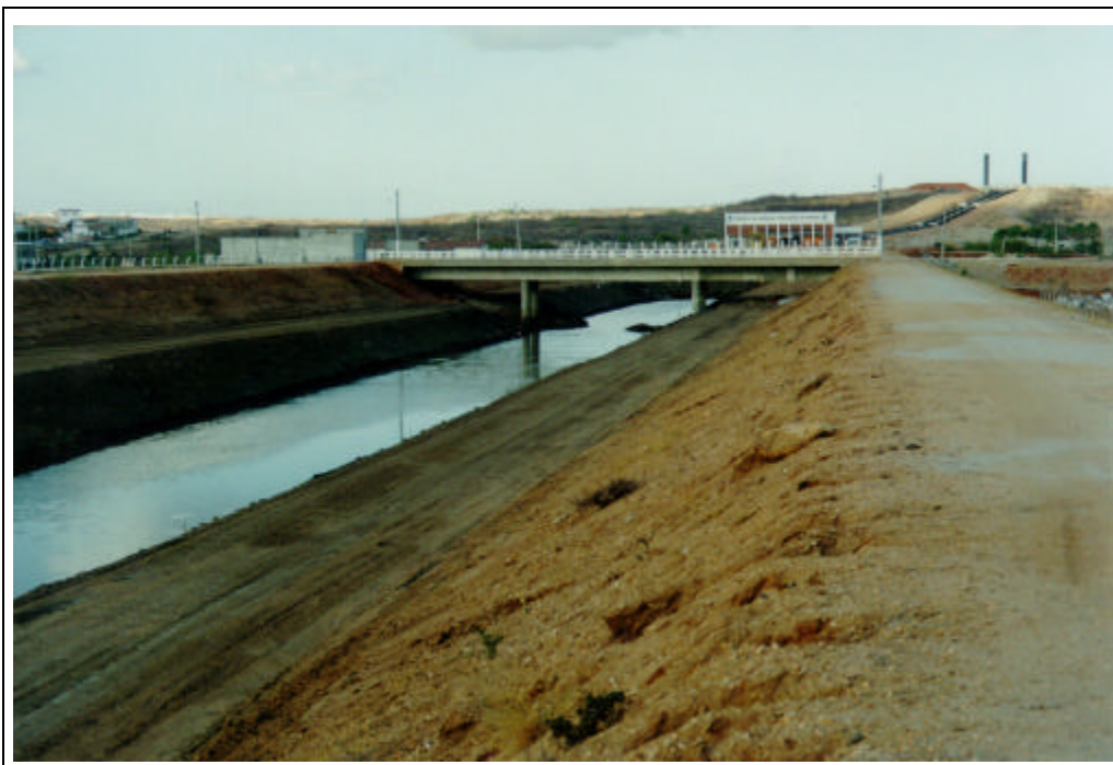
Foto 28/51 - Canal da tomada d'água do Projeto de Irrigação Tabuleiros de Russas, o qual tem início no reservatório formado pela barragem de derivação construída na ponte sobre o rio Banabuiú.
