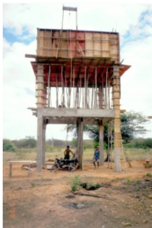
Foto 2.2 – Reservatório Elevado (50.000 l)
