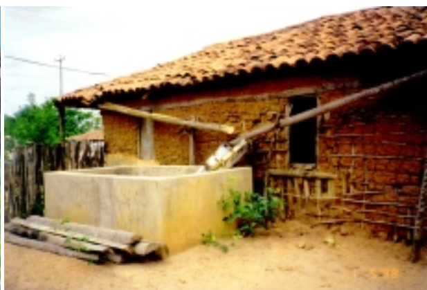
Foto 1.2 – Faz Cajazeiras – Sistema de Coleta de Água da Chuva.
