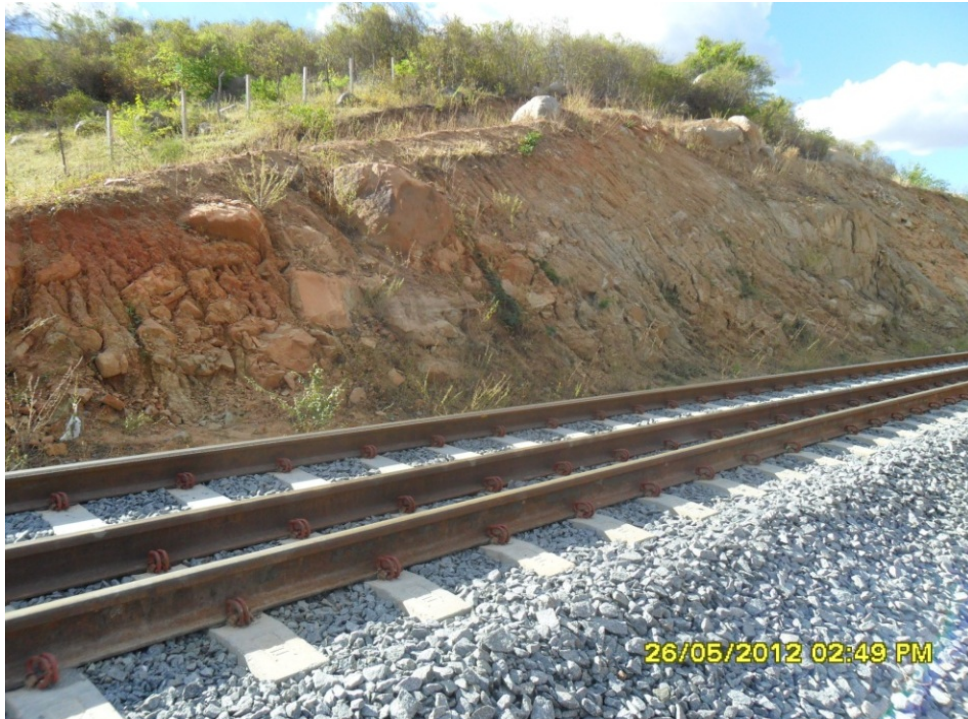
Foto 10 – Matacões soltos envolvidos por granito alterado
