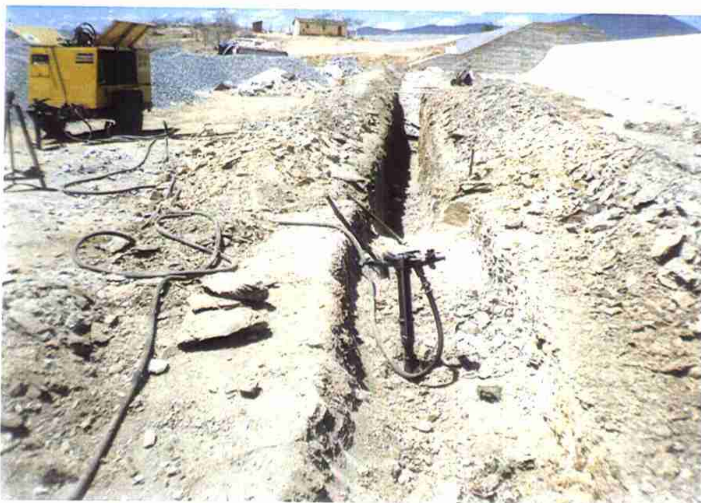
Vista da escavação com rompedor do Cordão de Fixação entre as extremidades dos Muros Direito e Esquerdo do Sangradouro, onde se vê
