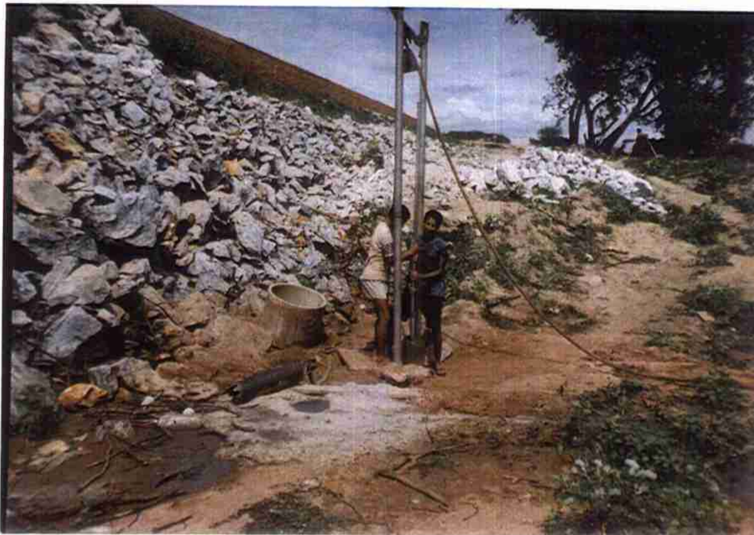
Vista de Poço de Alívio em fase de construção na calha do rio.
