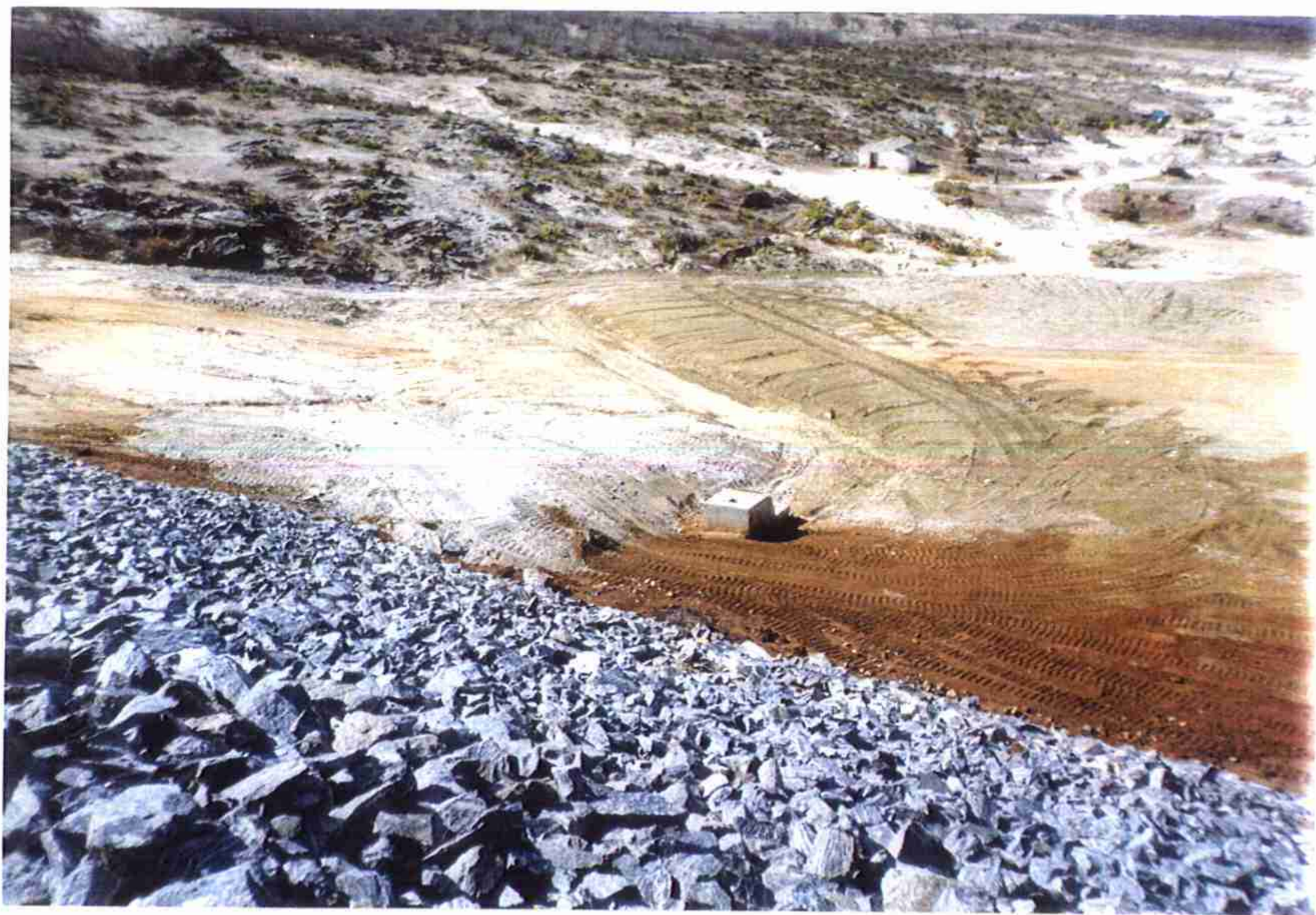
Vista Geral da Tomada D'água e Canal de Aproximação a nível de porão (cota 149,9).
