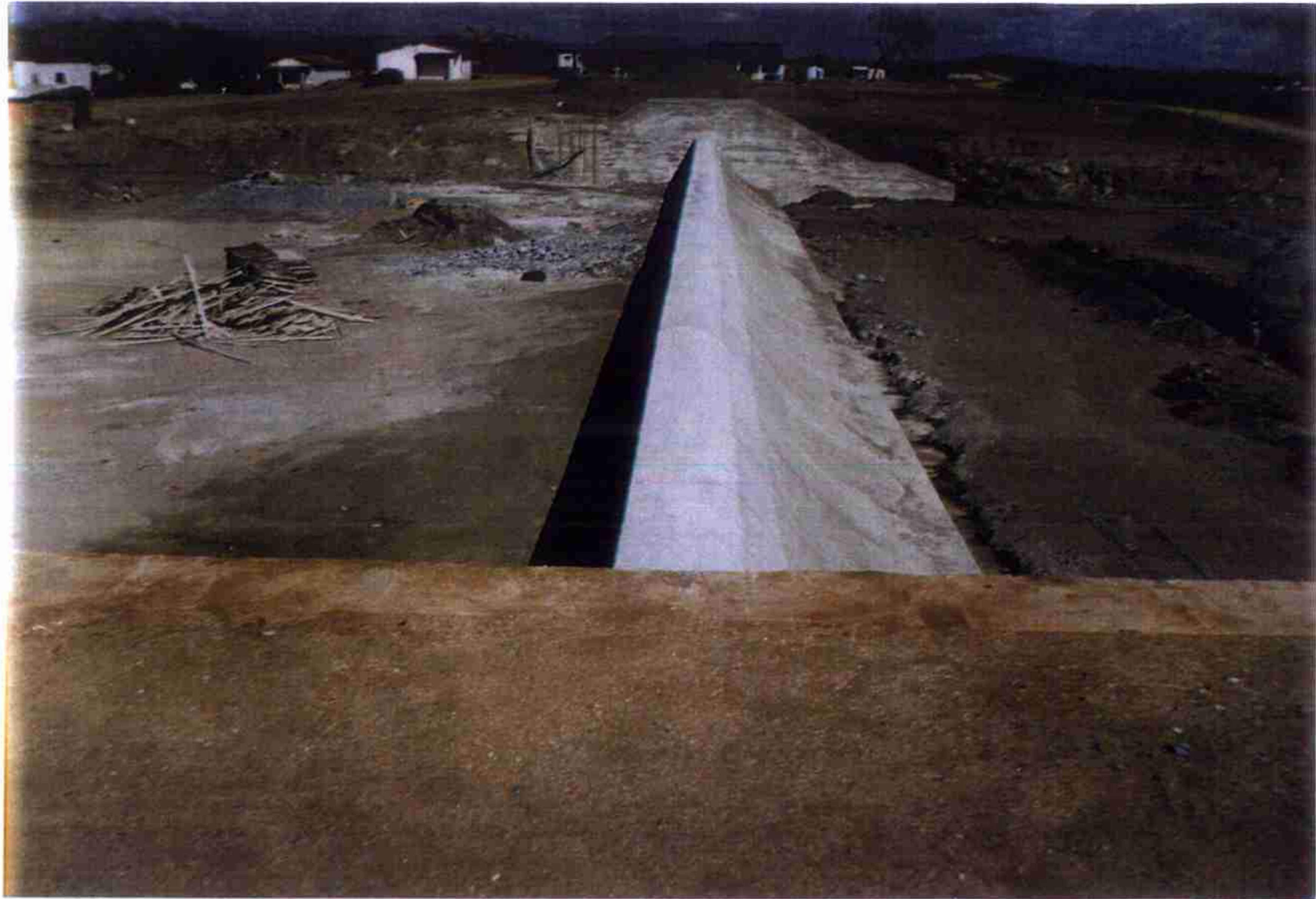
Vista Geral do PERFIL CREAGER concluído, entre o Muro Direito (estaca 33) e Muro Esquerdo (estaca 38) do Sangradouro.
