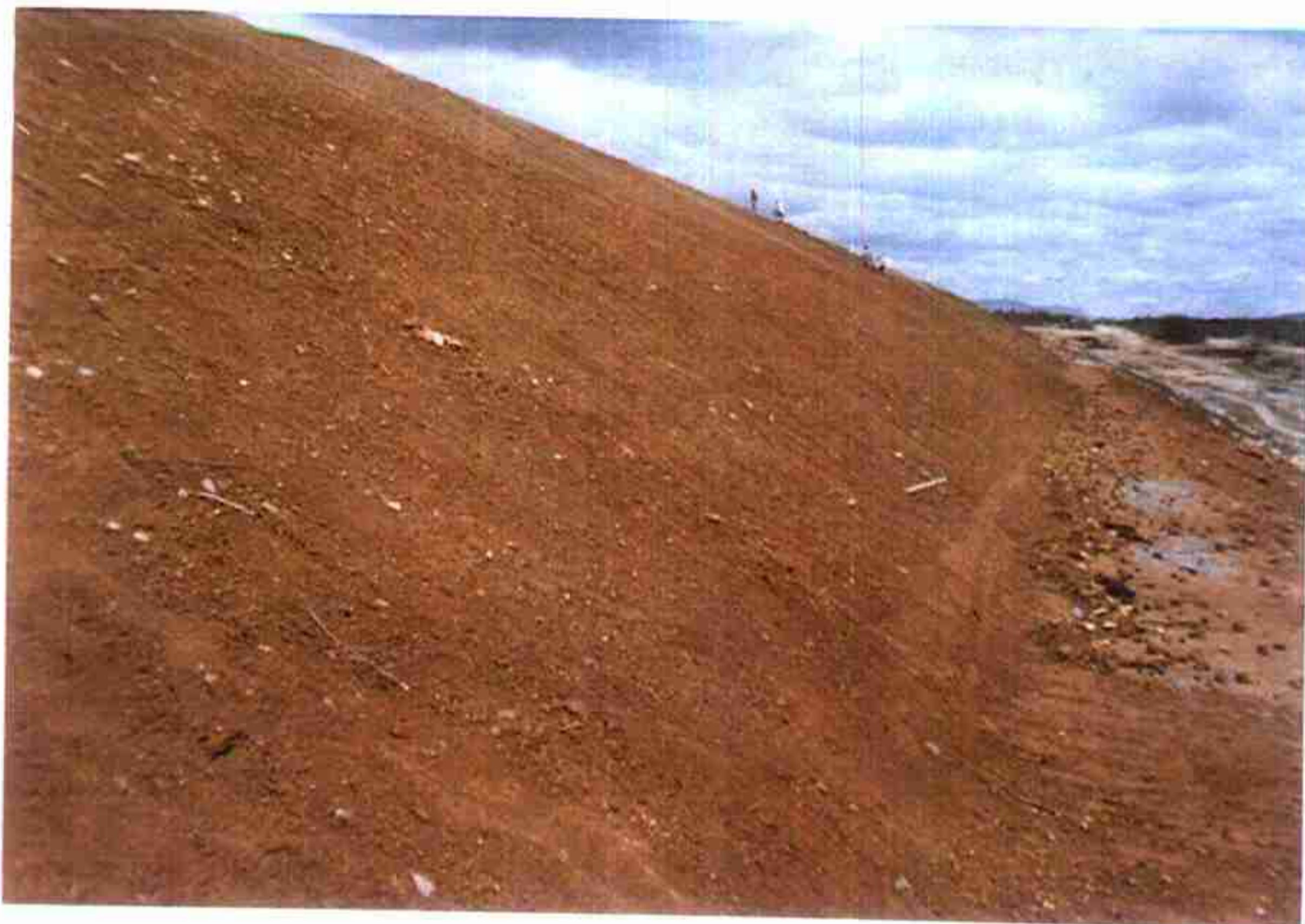
Vista do Talude Jusante em fase preparatória de acabamento para receber proteção de brita.
