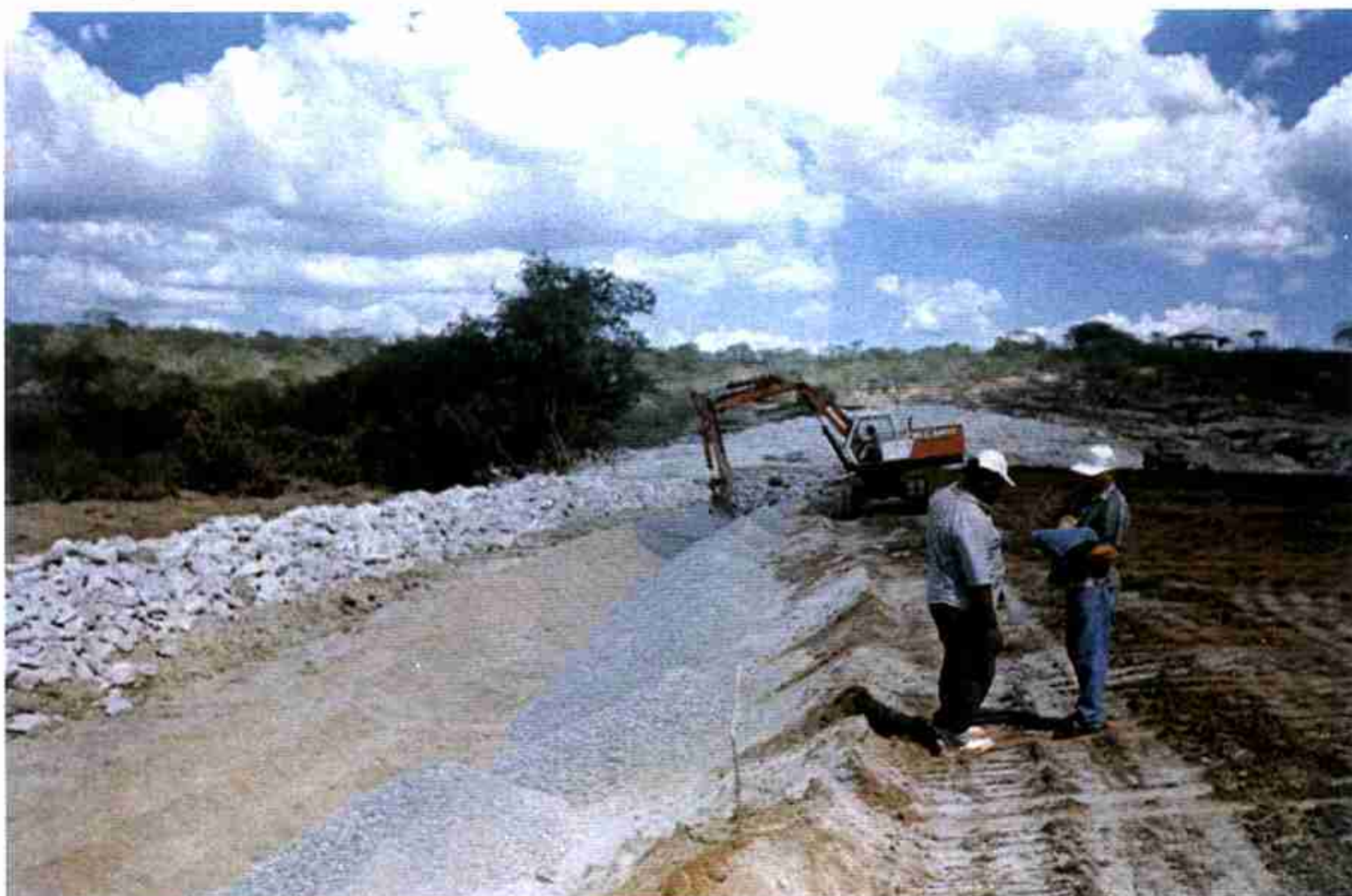
Detalhe da execução do "Rock-Fill" à jusante onde mostra detalhe da transição fina e grossa.
