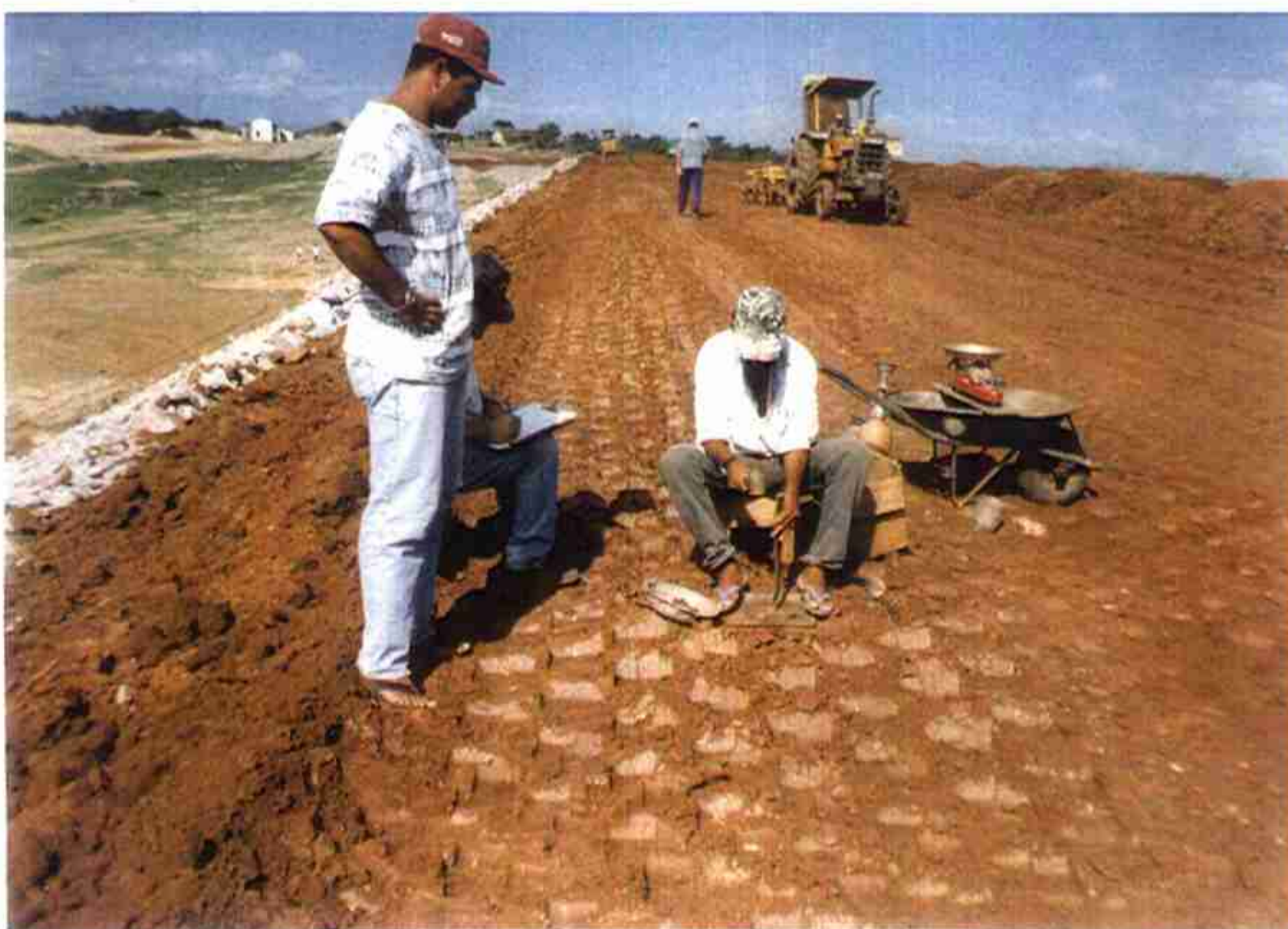
Vista da equipe de laboratório executando furo para determinação do grau de compactação, densidade "in situ".
