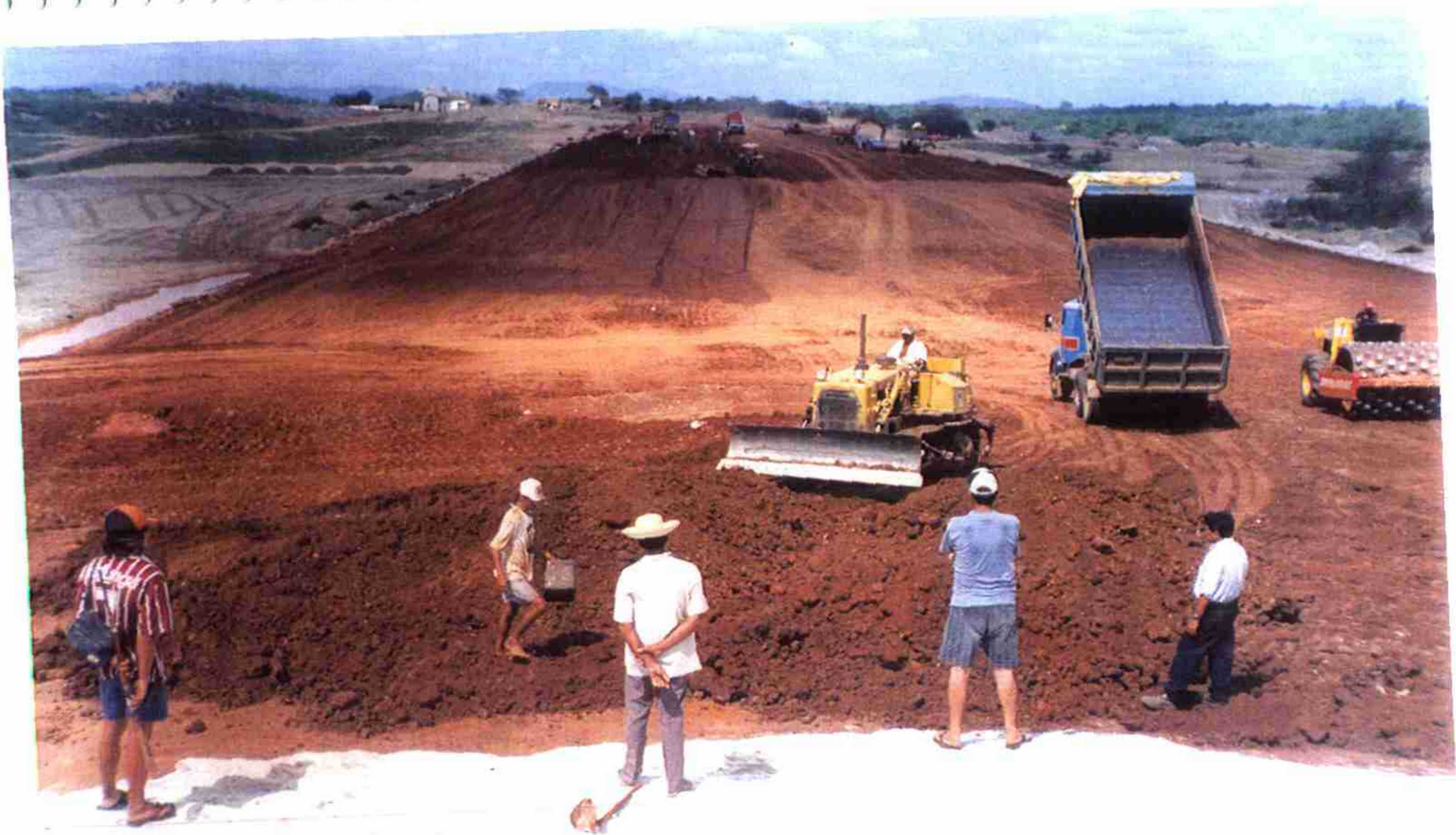
Vista geral do maciço sílico argiloso, com avanço na Ombreira direita e à esquerda tapete impermeável.
