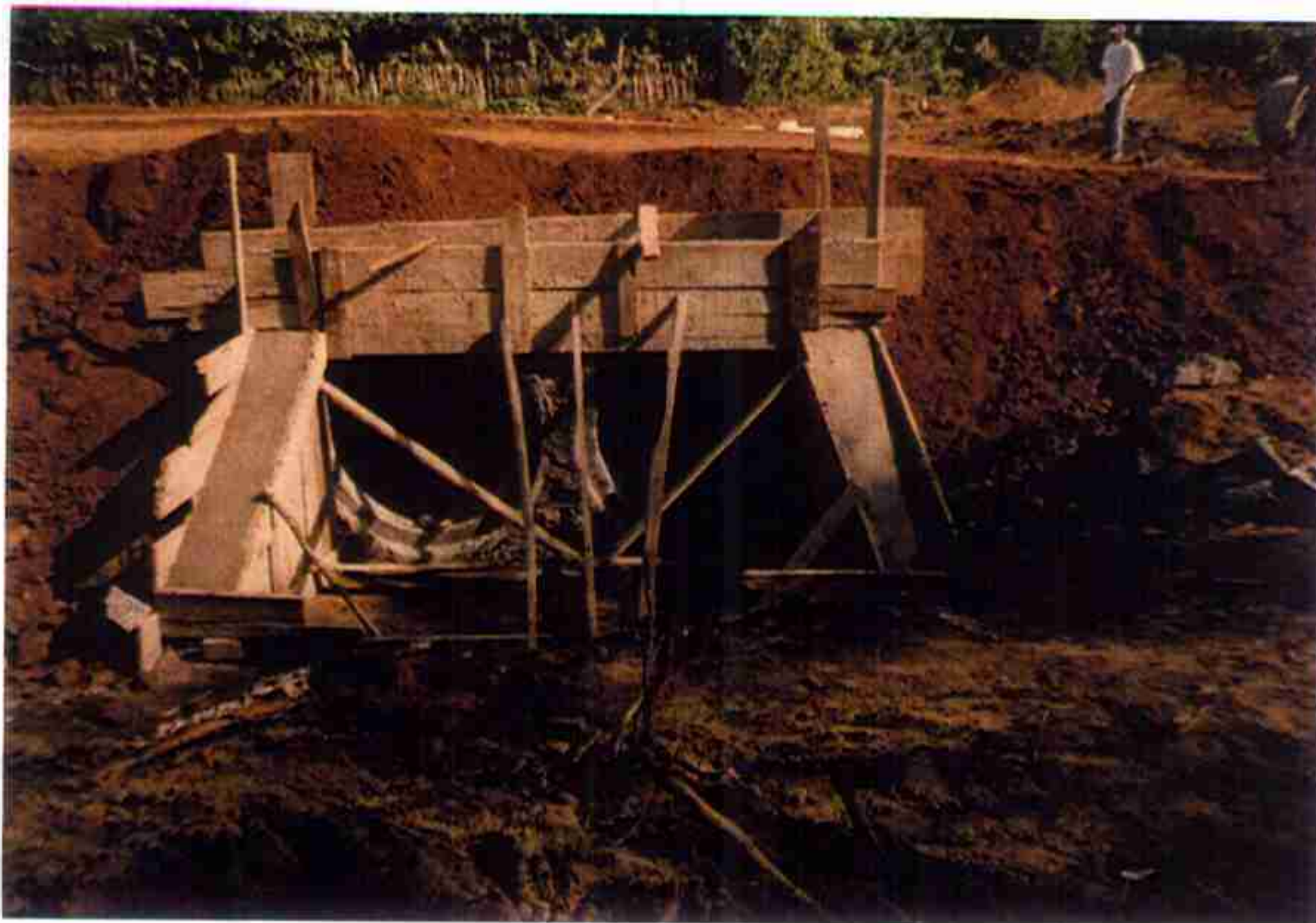
Vista da boca do BDTC Ø 0,80m, estaca 50+15,00m da Estrada de Acesso à Barragem.
