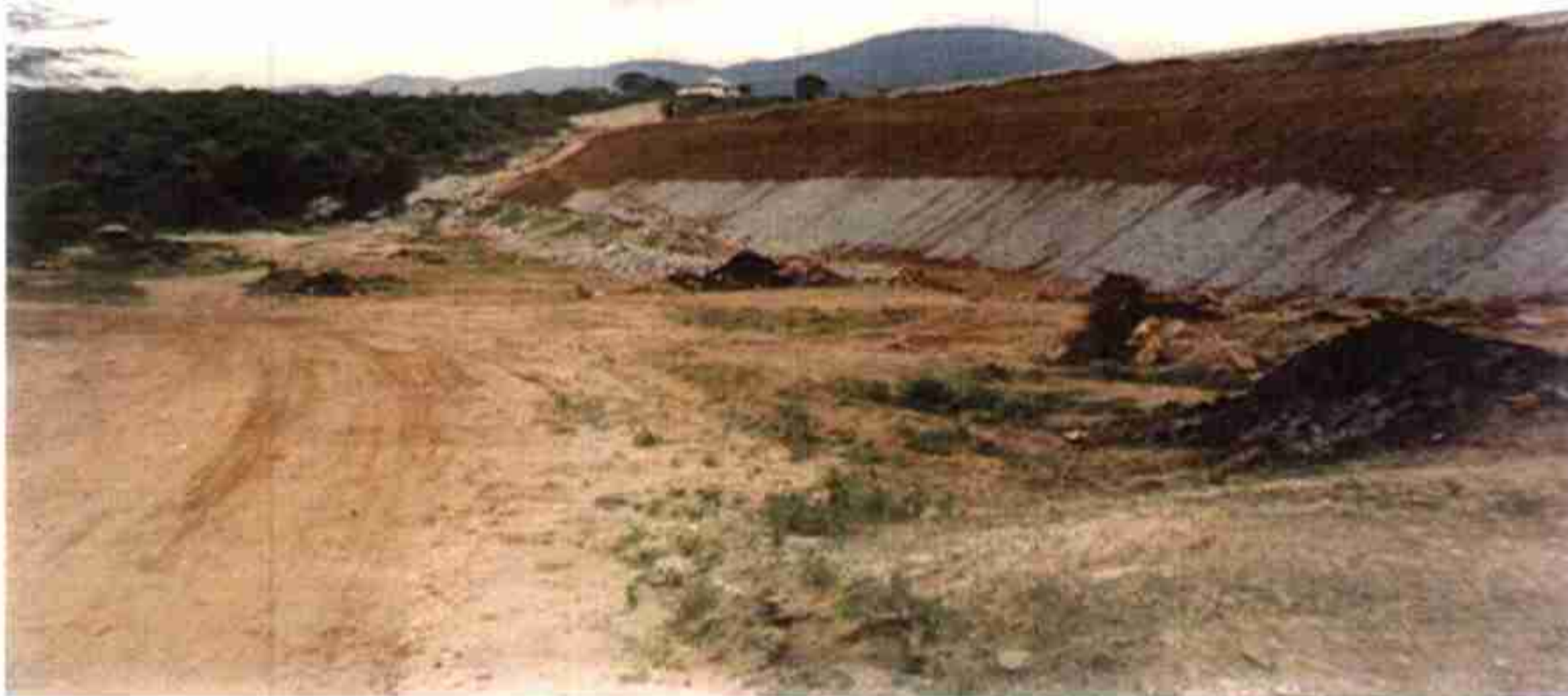
Vista do talude jusante com área já revestida com brita graduada e área acabada aguardando revestimento.
