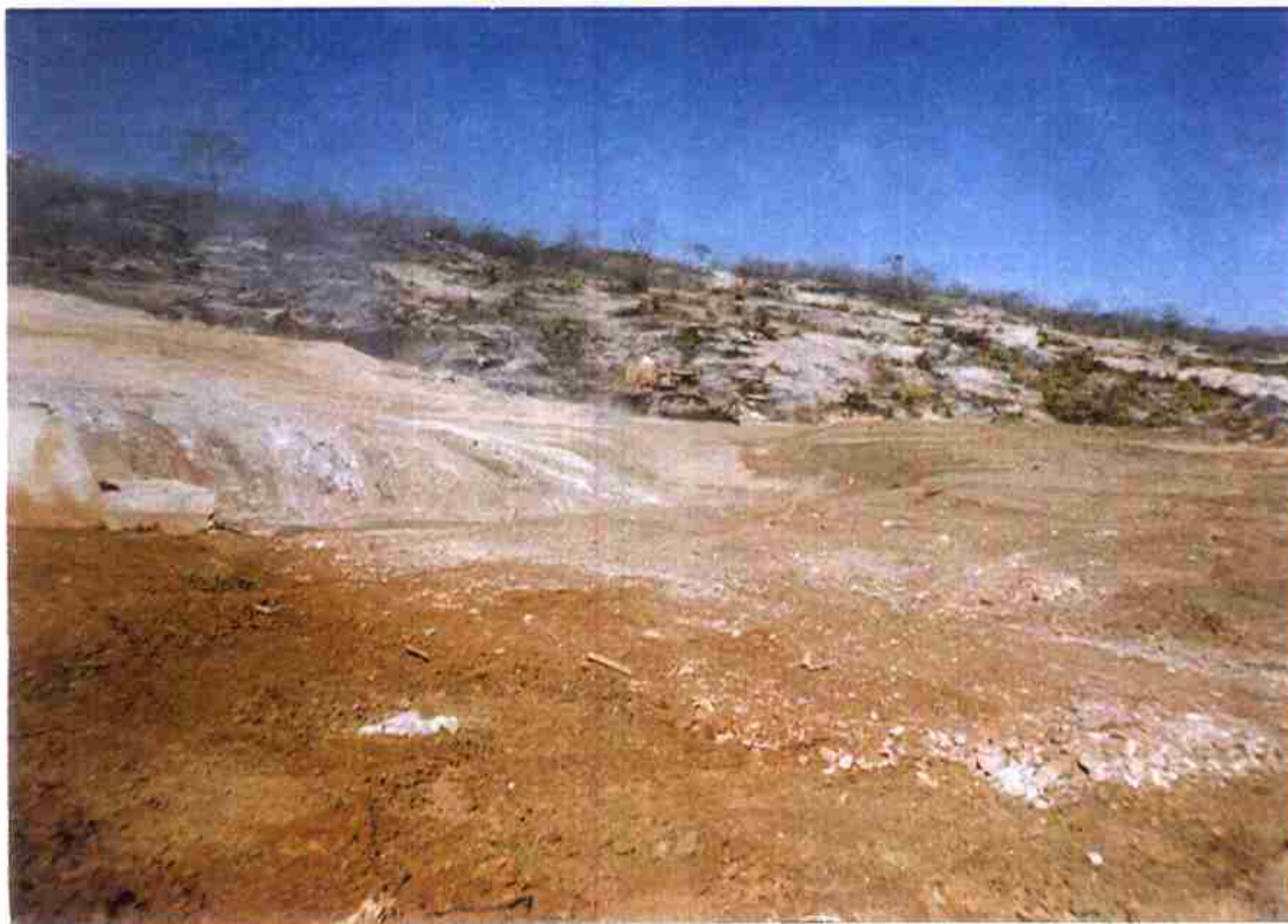
Vista do Canal de Aproximação da Tomada D'água a nível de Porão (cota 149,9.)
