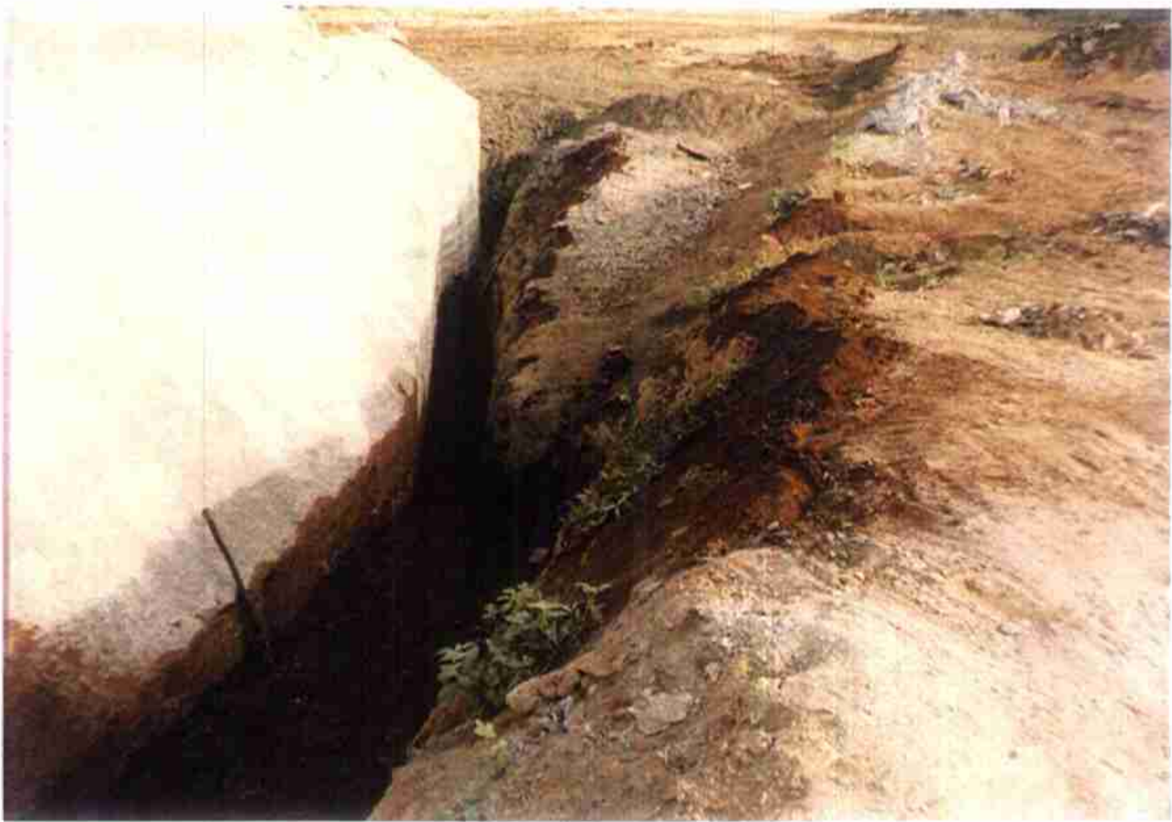
Vista do pé do muro direito do Sangradouro em fase de reaterro – Lado jusante.
