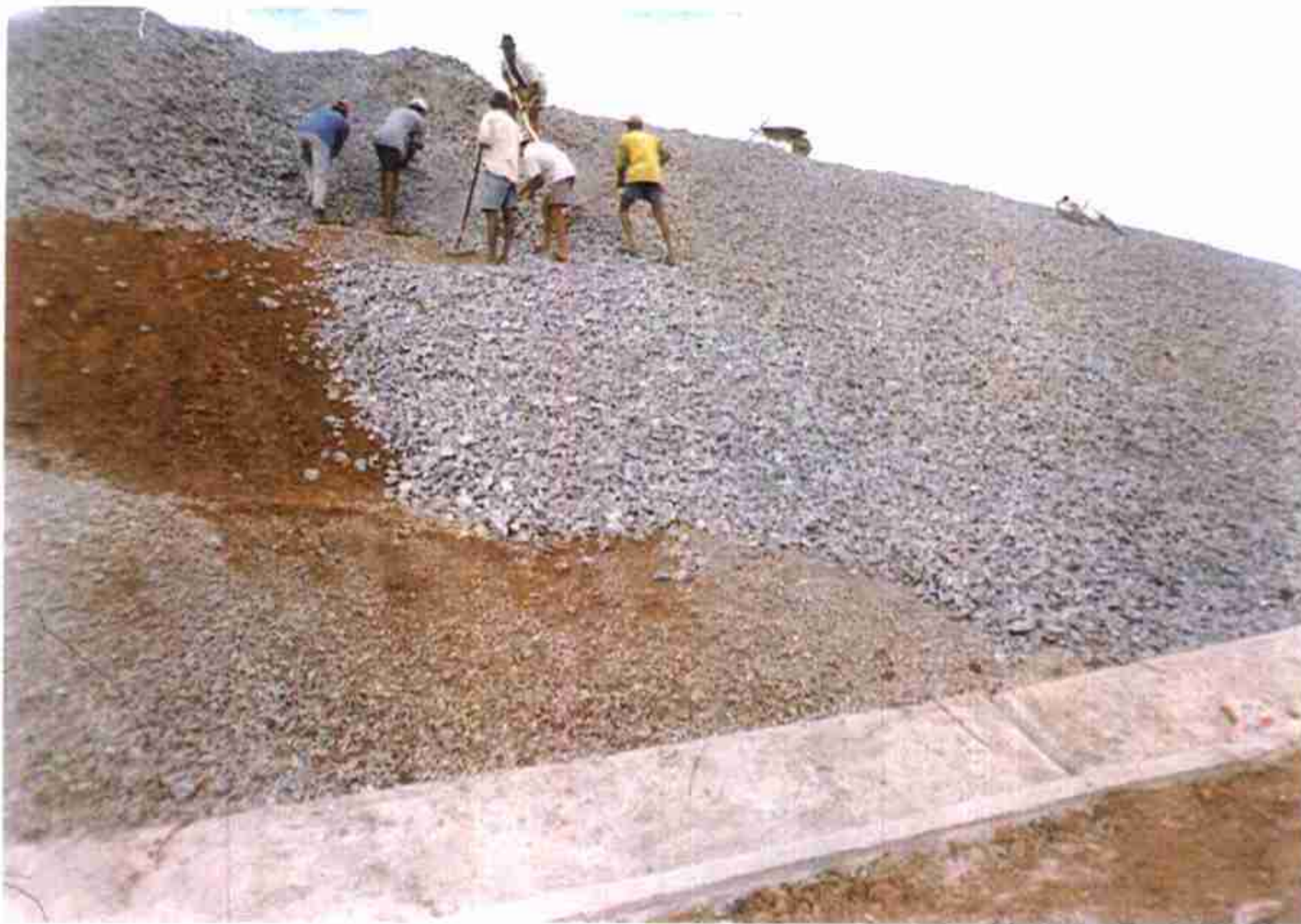
Vista do Revestimento Talude Jusante acima da cota 155 e detalhe da Sarjeta Coletora Ombreira Esquerda.
