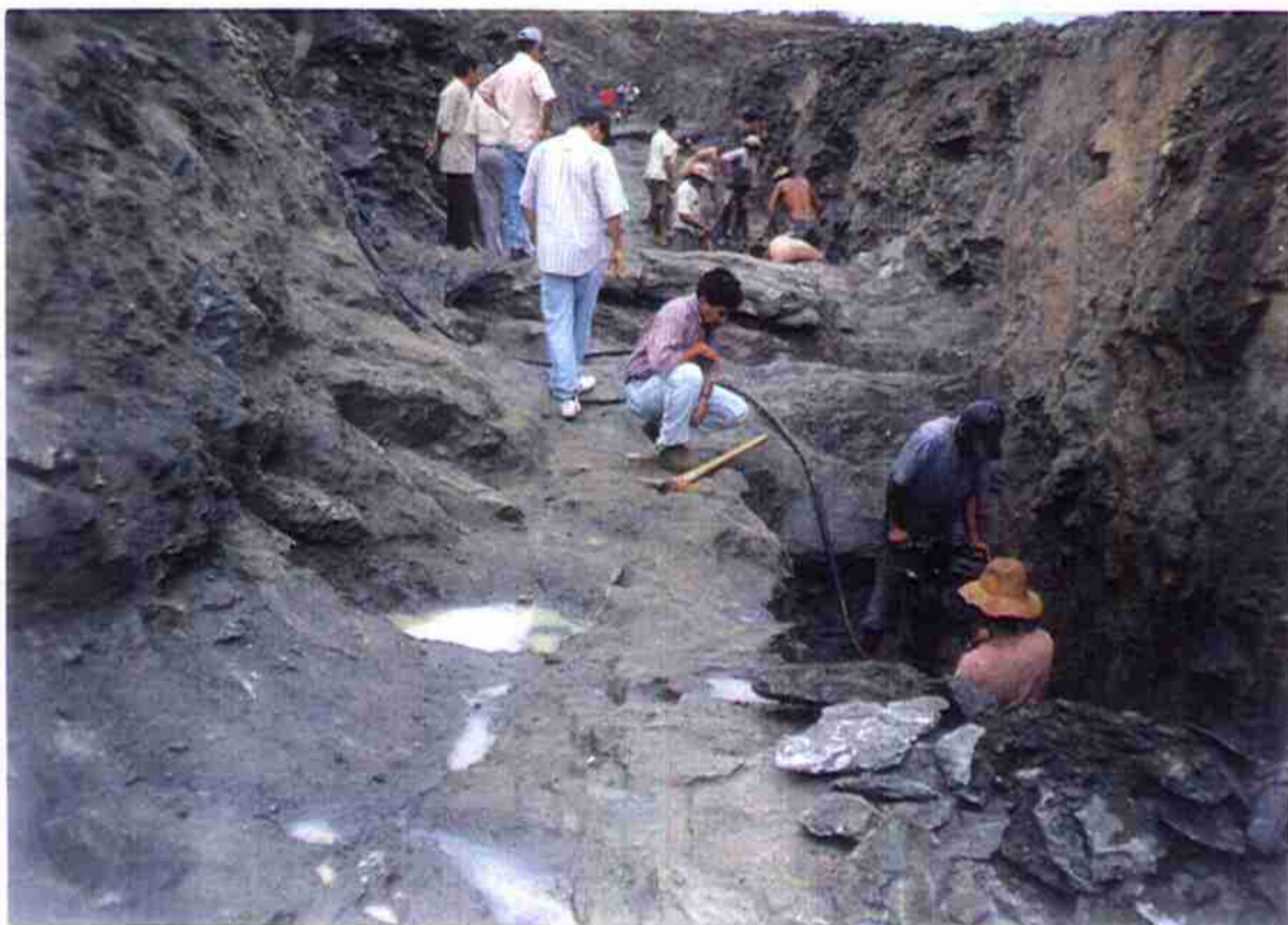
Detalhe de aprofundamento da escavação a jusante para implantação do PERFIL CREAGER.
