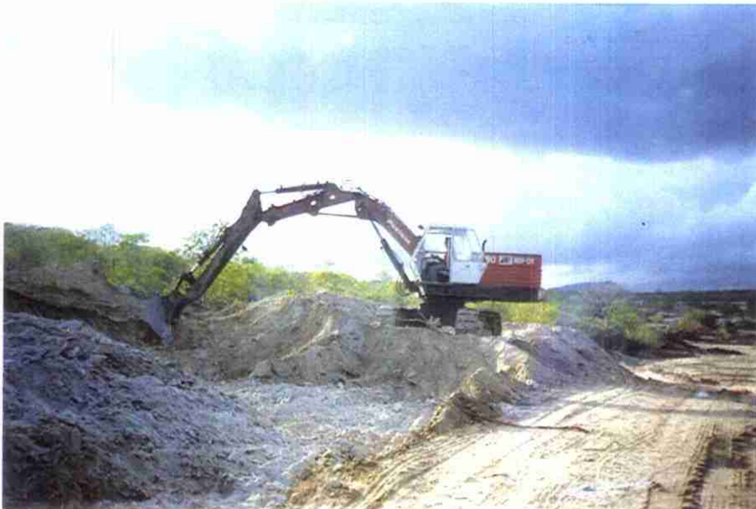
Vista de máquina Poclain LC-80 executando preparo da fundação na ombreira direita.
