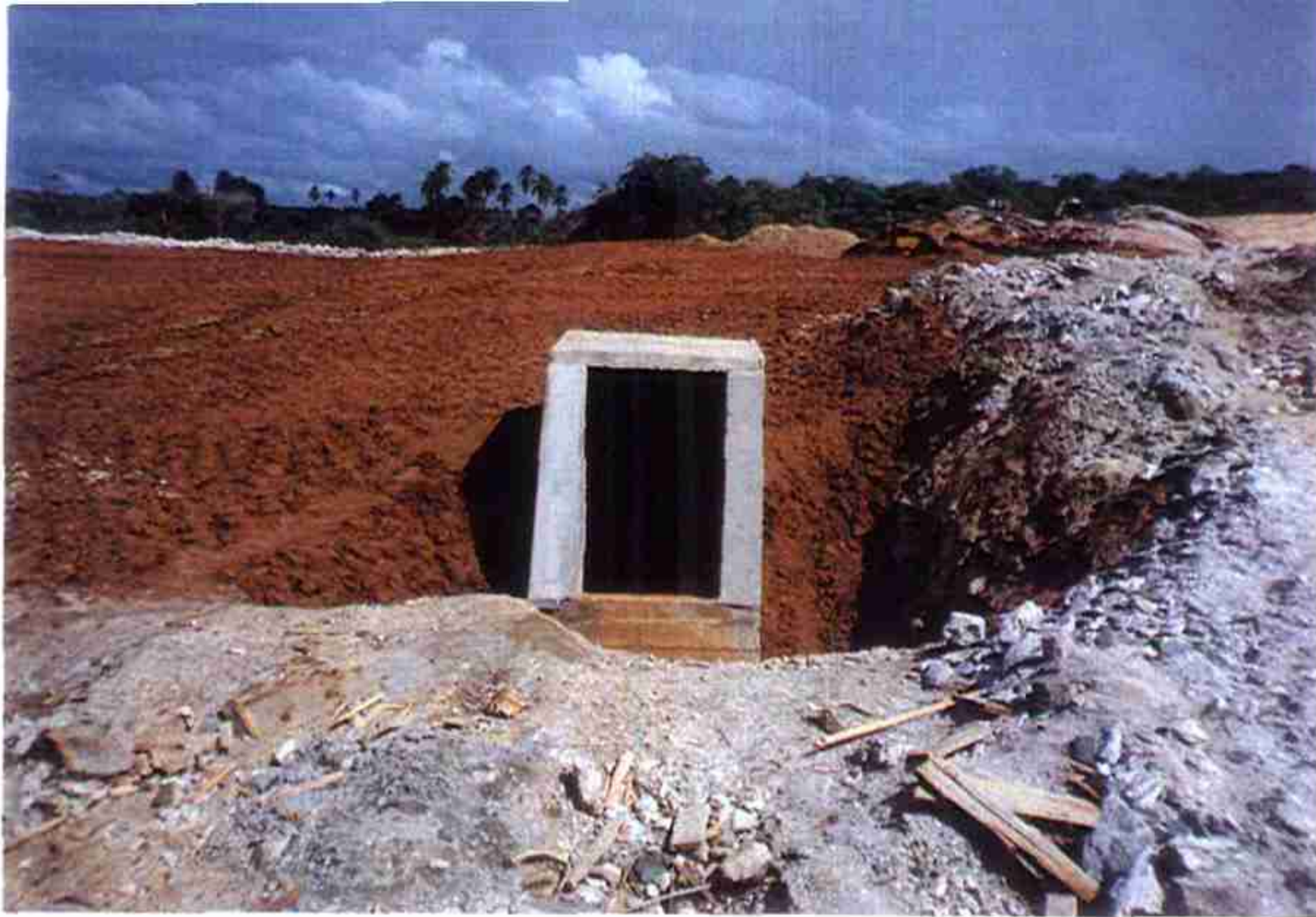
Vista caixa montante da Tomada D'água.
