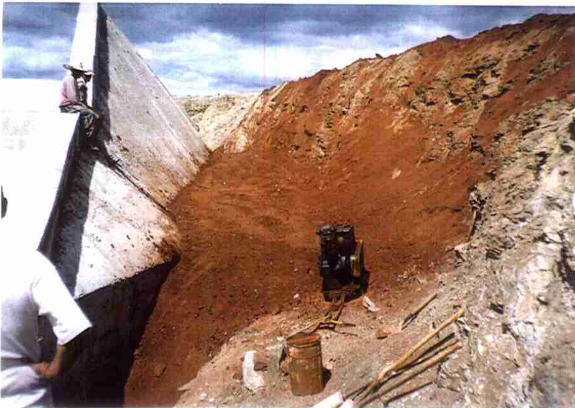
Vista de fase do Reaterro no pé do Muro Esquerdo, subindo na Ombreira.
