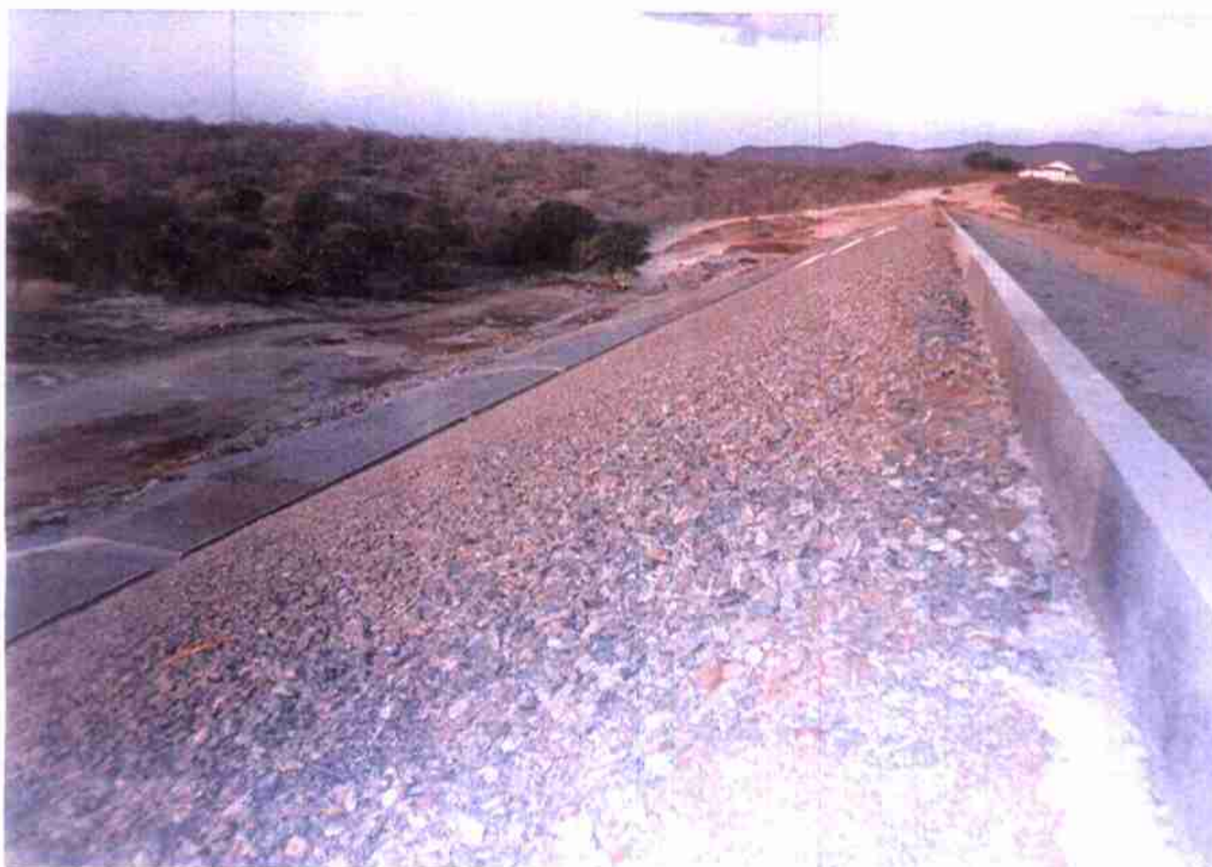
Vista do Revestimento Talude Jusante, com meio-fio na crista - cota 165,100 e Calha Coletora em "U" na cota 155,000 e Descidas D'água até o Rock-Fill.
