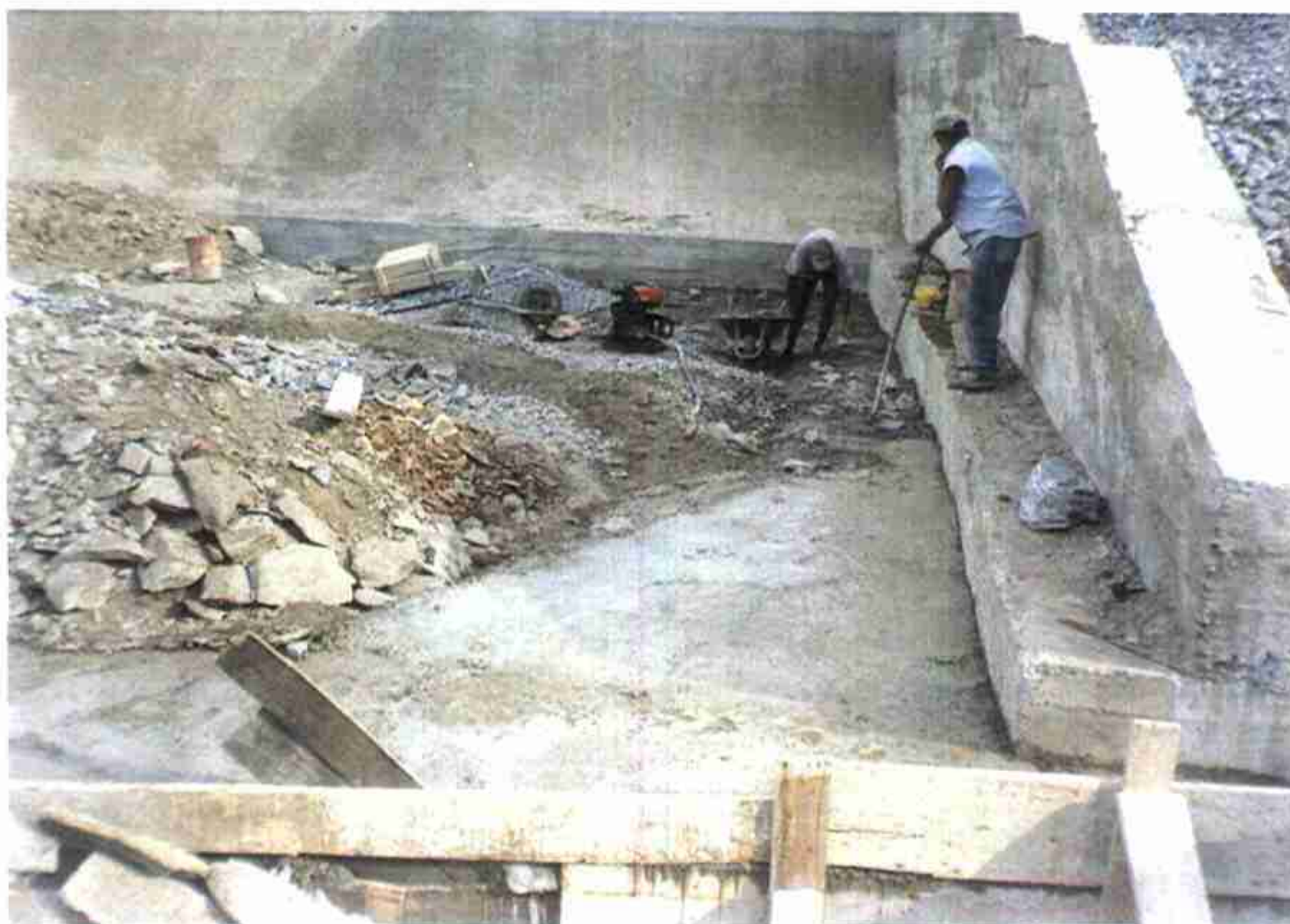
Vista da concretagem da cota 157,700 a 158,700 no sopé jusante do Muro Esquerdo.
