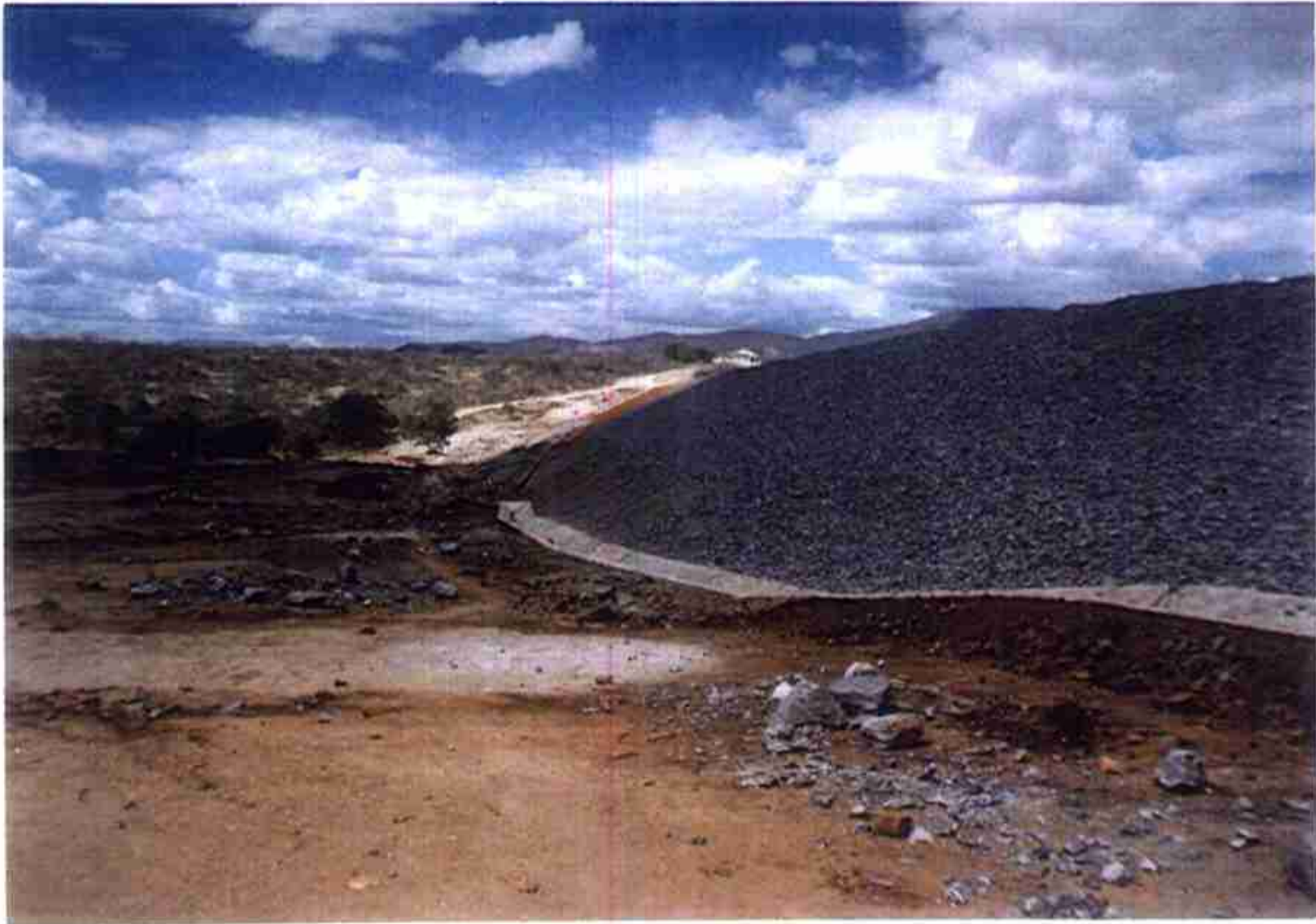
Vista do talude Jusante Revestido com brita de 1 a 3" e no pé, Calha Coletora de Ombreira.
