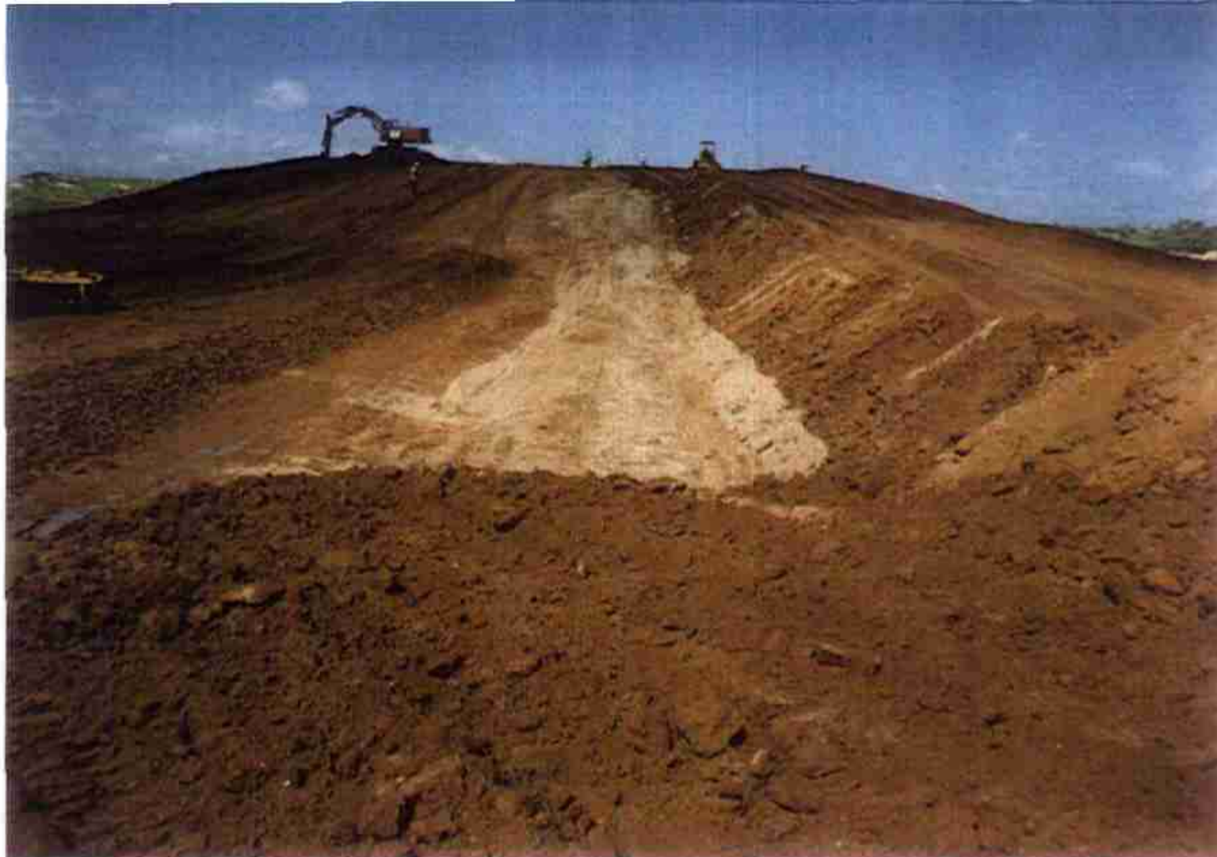
Vista de dreno vertical preenchido com areia, em fase de fechamento após adensamento da areia. Est. 5 a est. 13.
