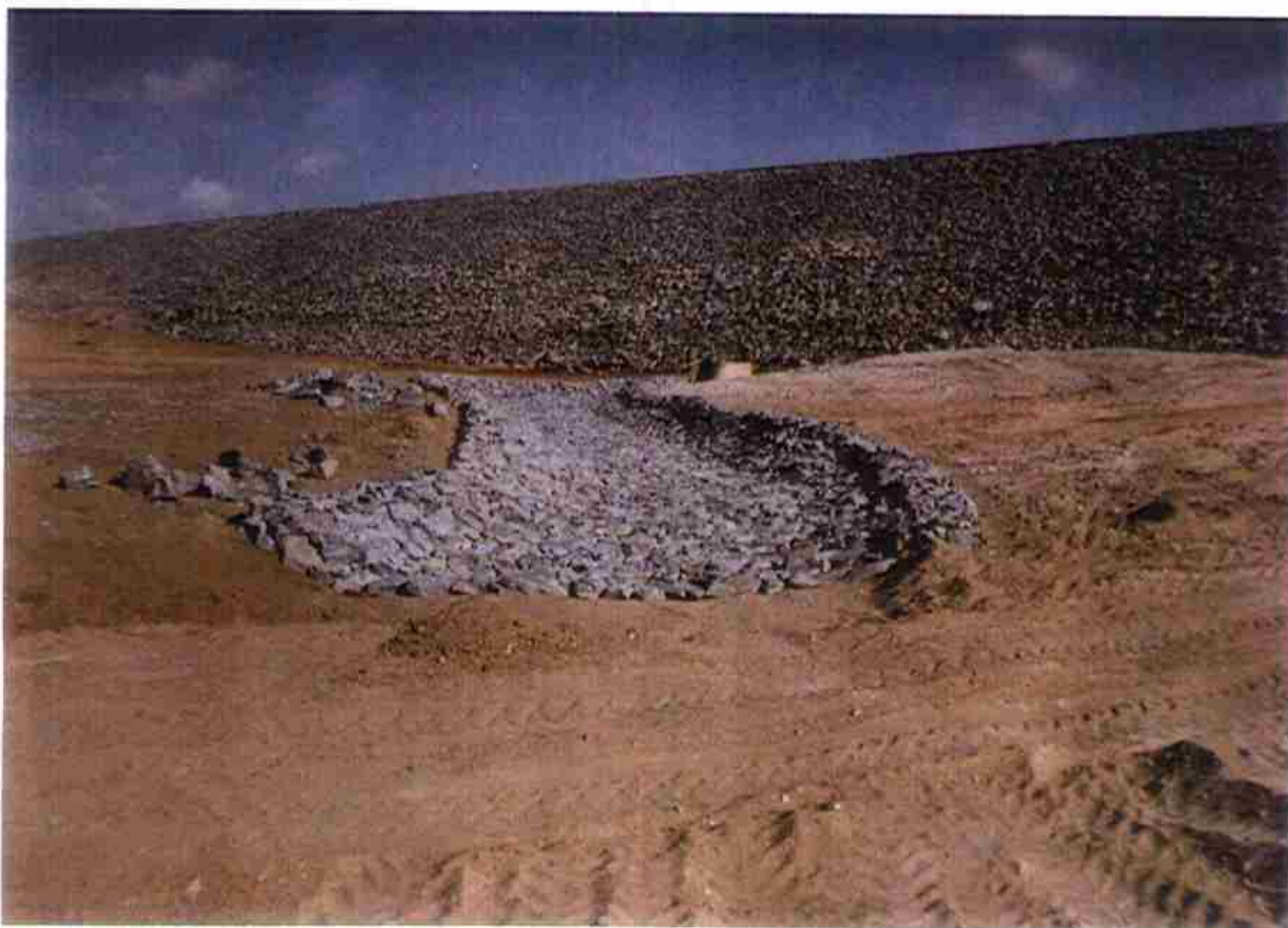
Vista do Canal de Aproximação para Tomada D'água, na cota de porão 149,900.
