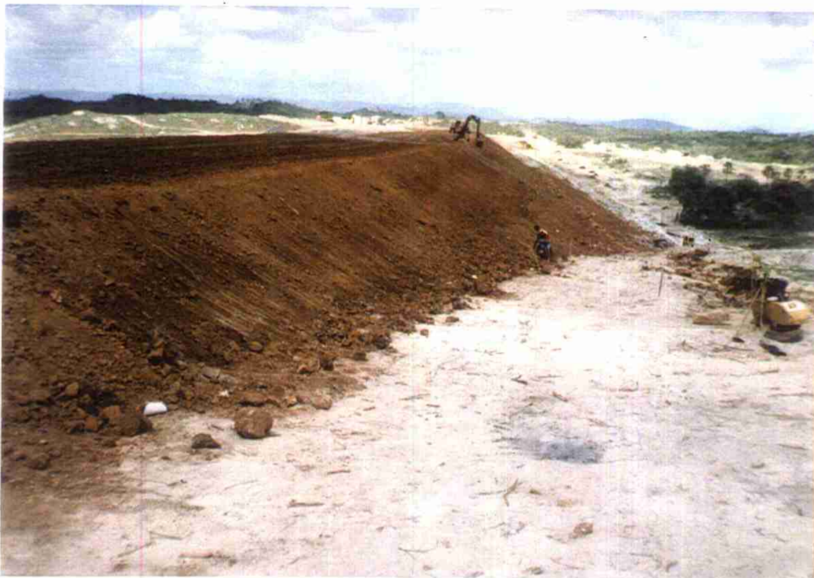
Vista do talude jusante do maciço em fase de acabamento com operação de Retro Escavadeira Poclain LC-80.
