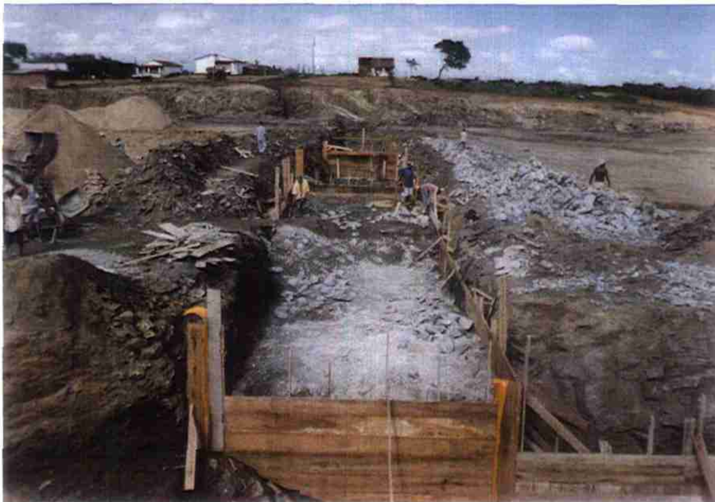
Vista da operação de concretagem da fundação do PERFIL CREAGER com concreto ciclópico (12% de pedra).
