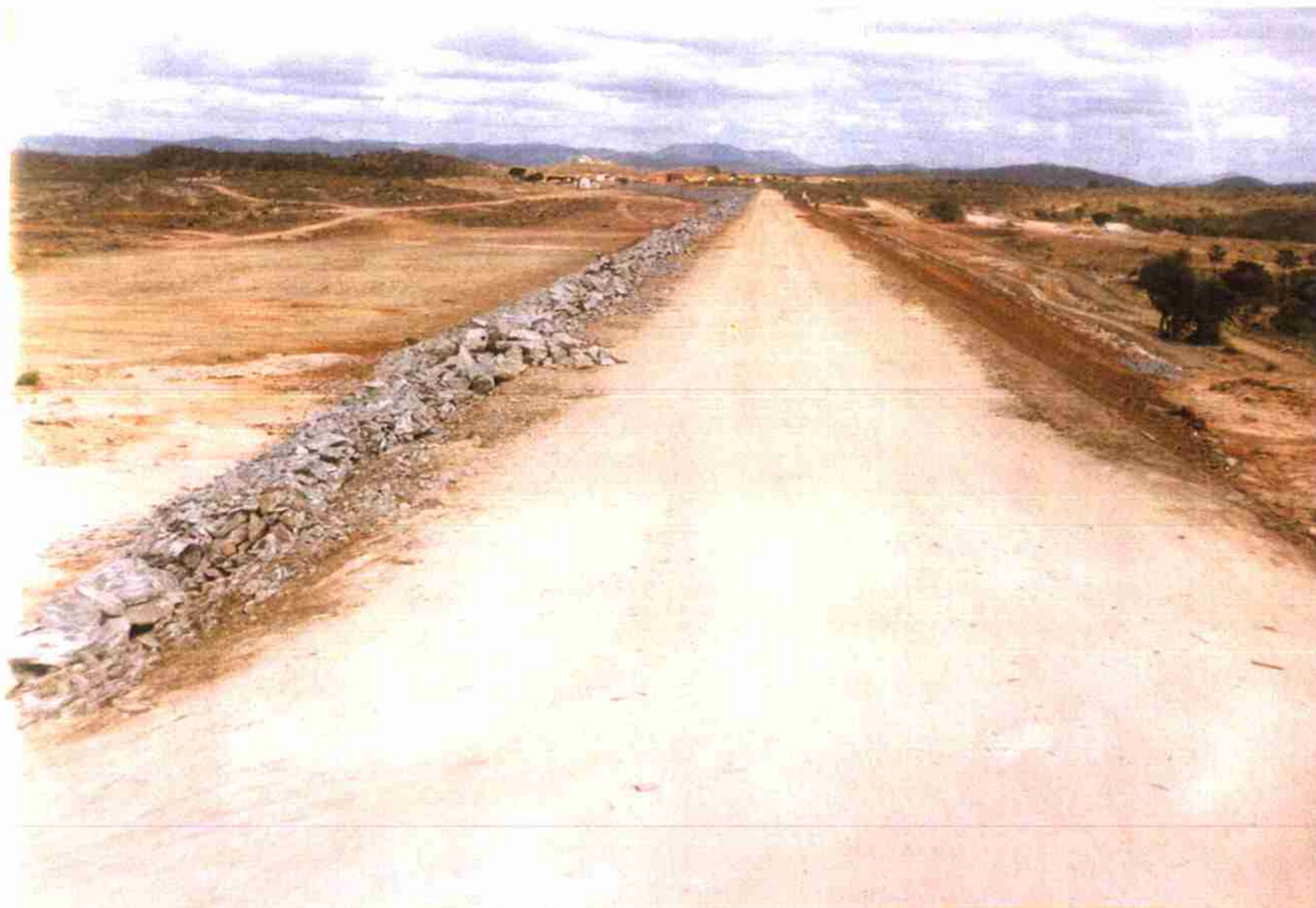
Vista geral da Barragem da estaca "0" a estaca "33" na cota de coroamento 165,100. A esquerda RIP-RAP em execução e a Direita Talude jusante em fase de acabamento para receber proteção de brita.
