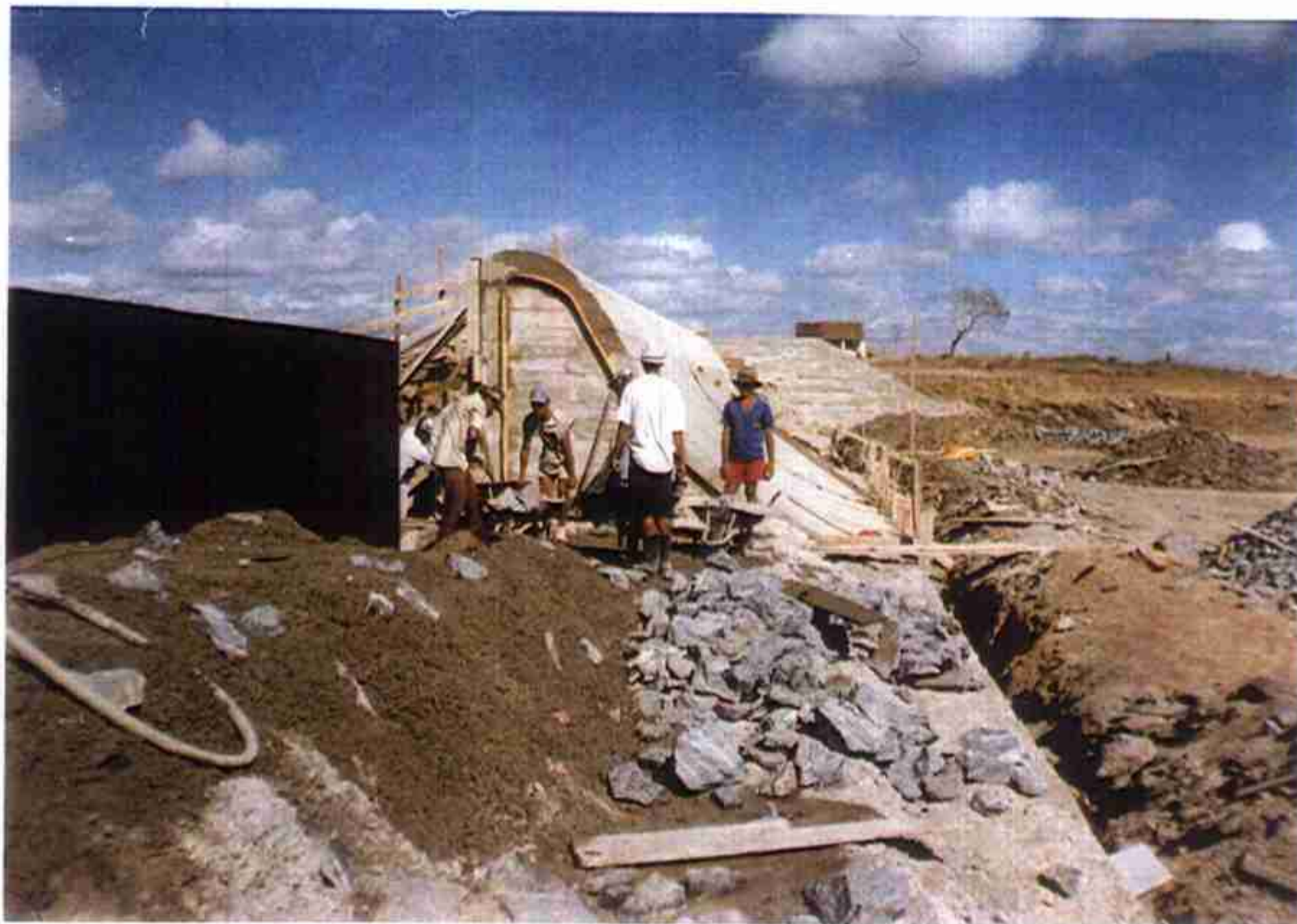
Vista do PERFIL CREAGER do Sangradouro – Bloco 1 em fase de concretagem e Bloco 2 concluído.
