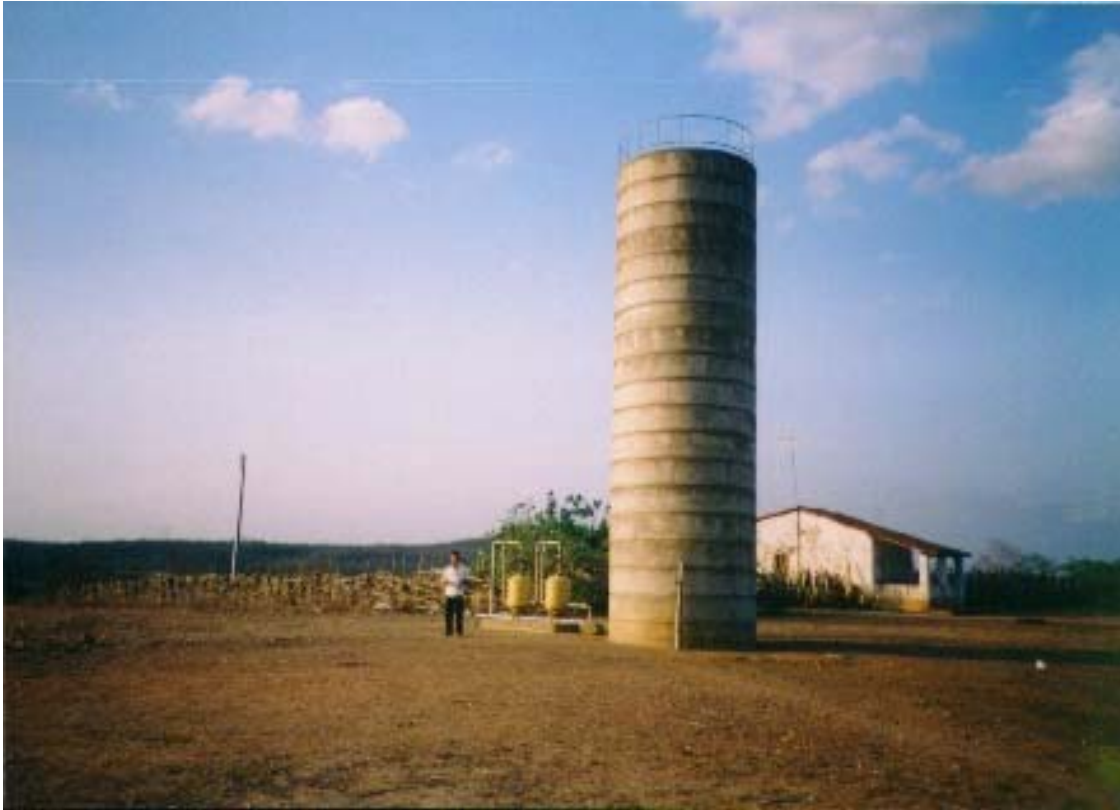
FOTO 17 – Reservatório elevado de São Domingos ( V=60m^3 ) Detalhe: Filtros de Ferro
