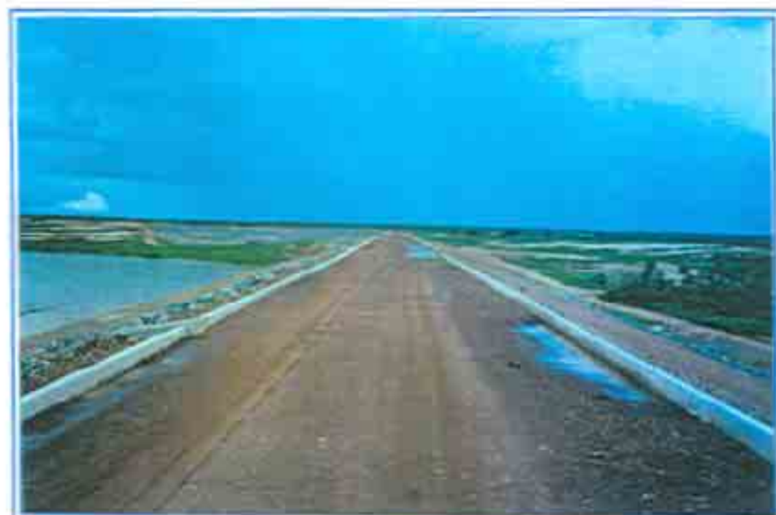
FOTO 18 - VISÃO DE CUMBRAMENTO DE REVESTIMENTO DE PIMENTA NA COTA 49,20 E 49,20 (BAIXA EXCESSIVA) (R/R)
