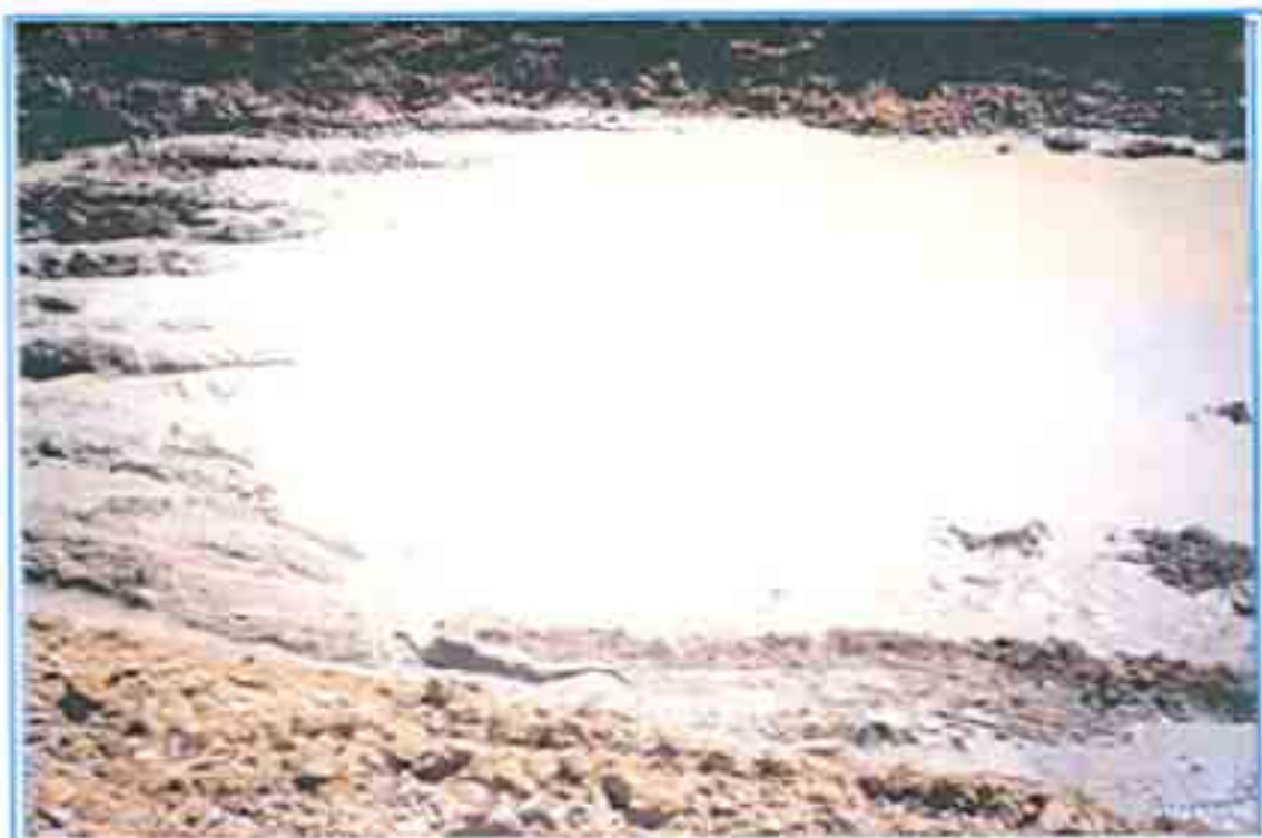
FOTO 03 | DETALHE DE ACUMULAÇÃO DE ÁGUA NA SUPERFÍCIE DA BARRAGEM (ESTADA 01)
