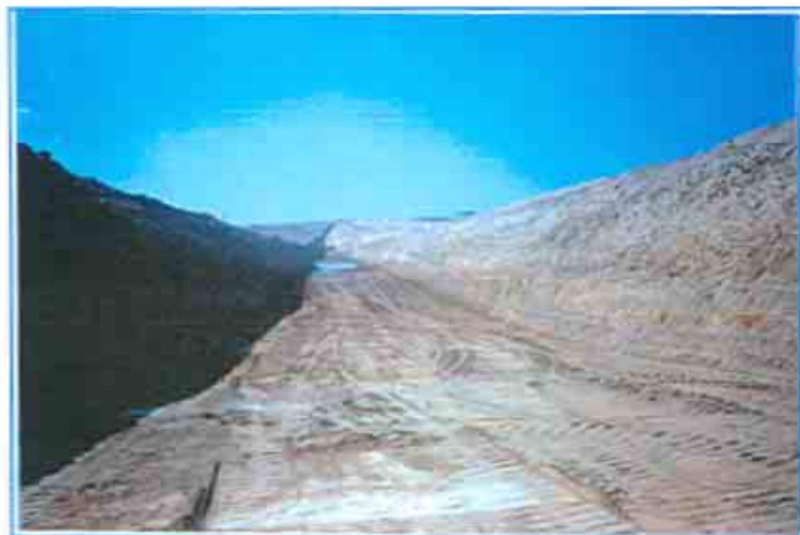
FOTO 04 | VISTA PARCIAL DA CUBA MANTENDO A ESCAVAÇÃO DAS FUNDAÇÕES DA BARRAGEM (ESTADA 01)
