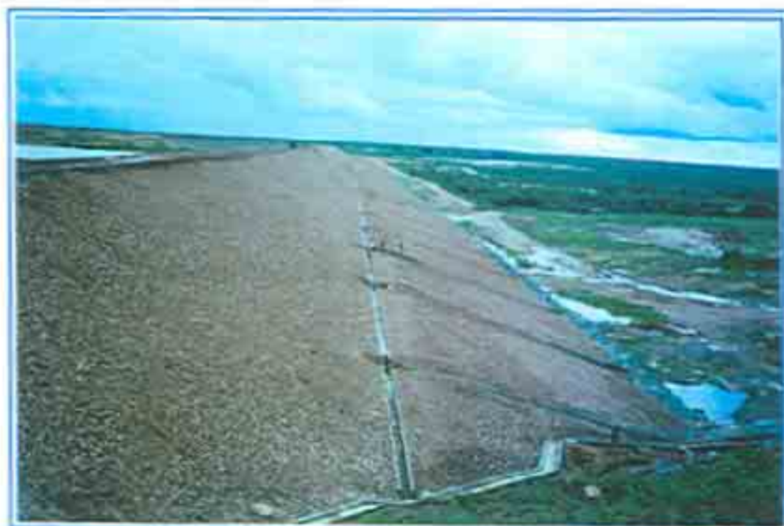
FOTO 20 PANORAMA DE UM CONTINTIVO DE DRENAGEM CALHEIAS E DRENEMAS EFETUA DA CARRIÇADA.
