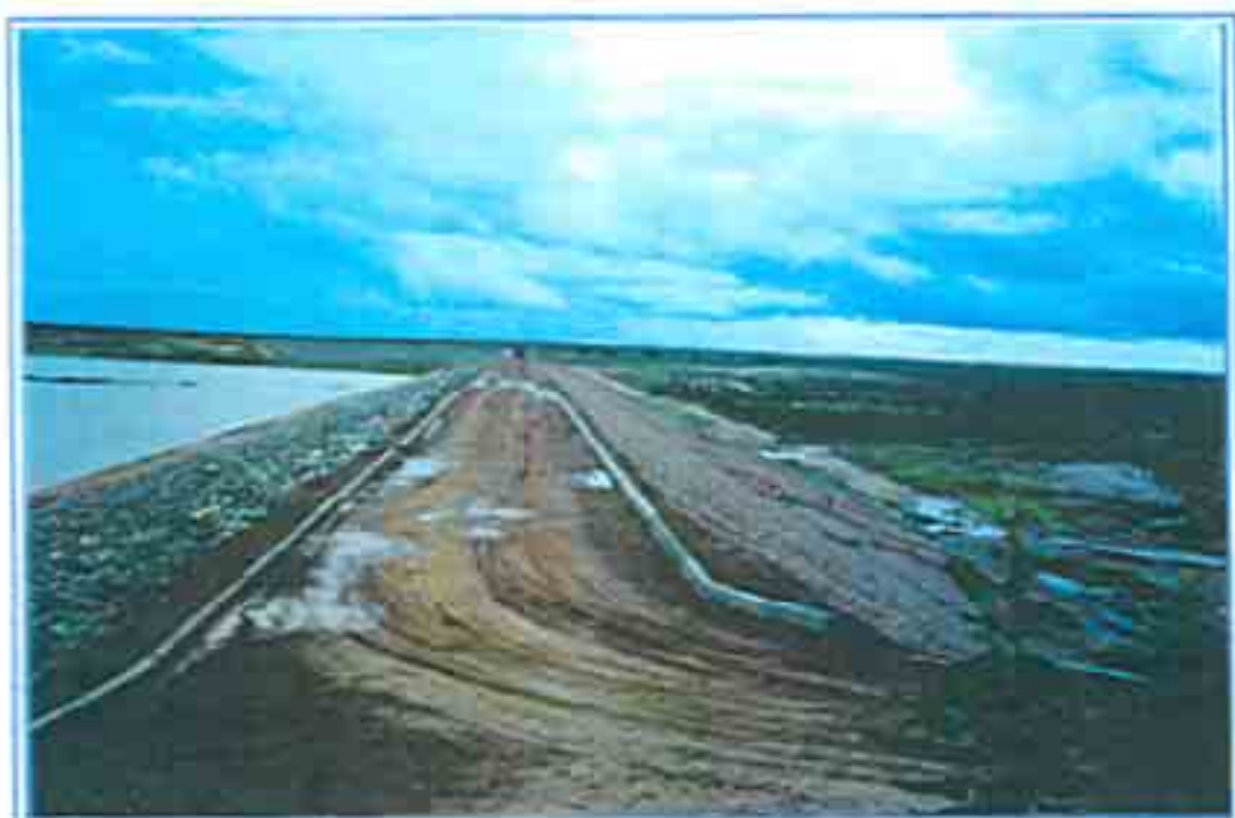
FOTO 17 - VISÃO DE CUMBRAMENTO DE REVESTIMENTO DE PIMENTA NA COTA 49,20 E 49,20 (BAIXA EXCESSIVA) (R/R)
