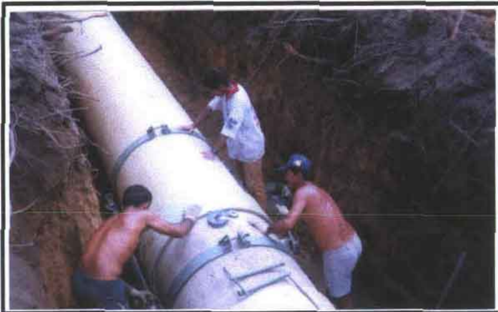
Foto 3 – Assentamento dos tubos através de tirfor (talha guincho) conectado a abraçadeiras interligadas por correntes.
