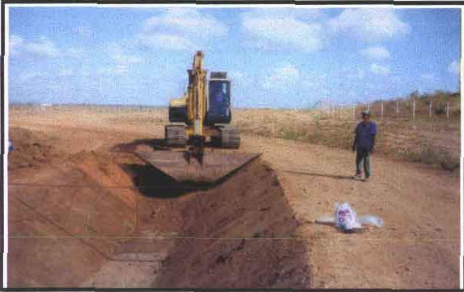
Foto 7 – Detalhe da escavação controlada da seção do canal para execução do revestimento de concreto ( l= 5,0 cm) sobre manta de polietileno ( l= 1,00 cm).
