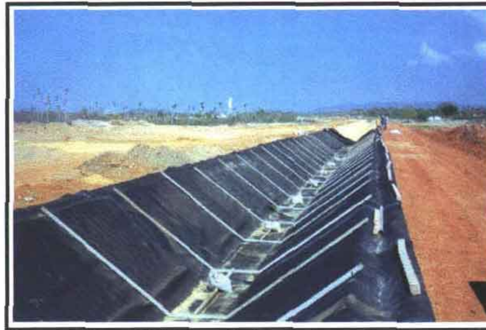
Foto 2 – Manta PEAD texturizada de 1,0 mm de espessura, que constitui parte do revestimento e é aplicada sequencialmente após a regularização.
