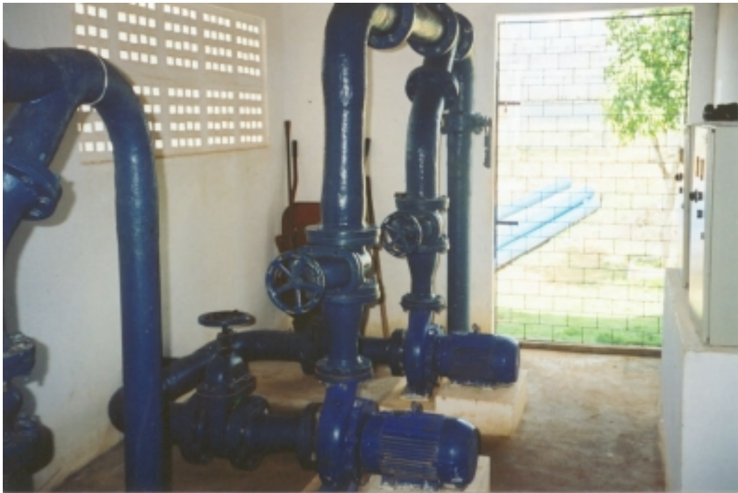
FOTO 3 - Bombeamento para lavagem de filtros
