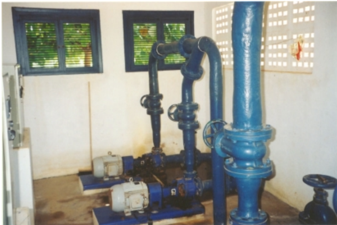
FOTO 4 - Bombeamento para reservatório elevado de Alto Santo
