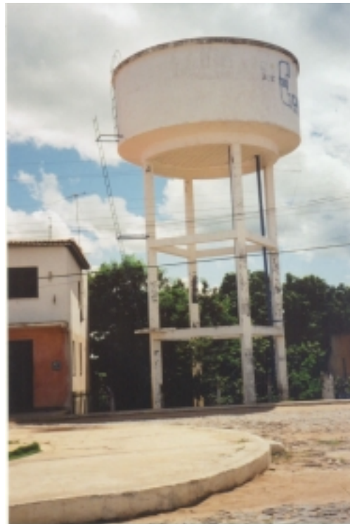
FOTO 6 - Detalhe do Reservatório elevado da CAGECE de 120 m 3
