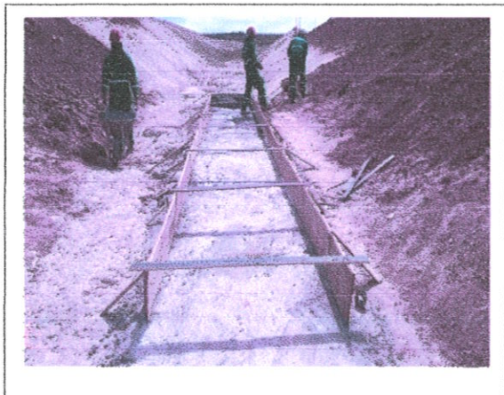
FOTO 07 – Execução da forma do concreto da regularização da galeria da tomada d'água;
