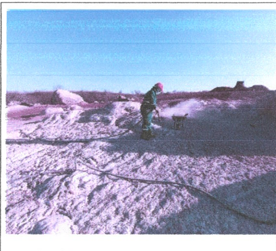
FOTO 03 – Tratamento da fundação em rocha com utilização de jato de ar comprimido e água, estaca 19.
