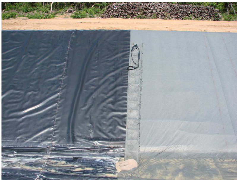
Foto 4.8: Detalhe da Manta de Impermeabilização
