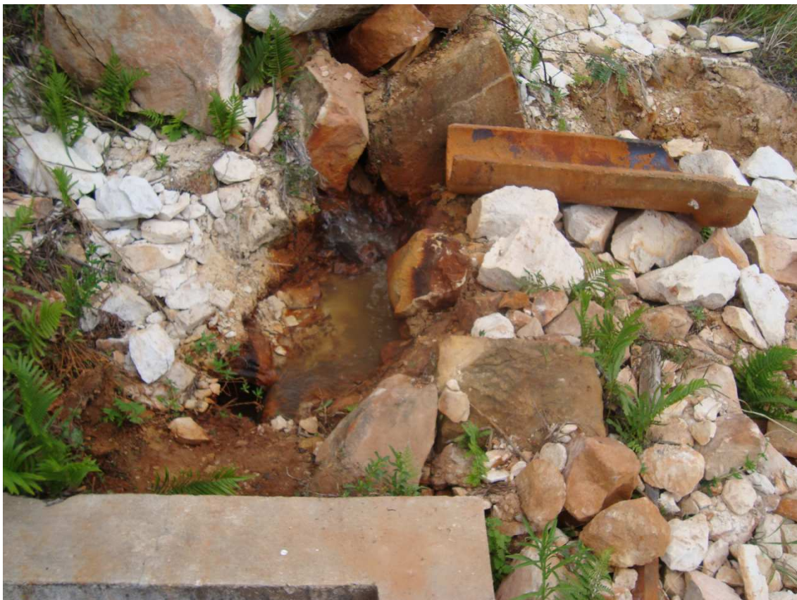
Foto 43 – Revência próxima aos medidores 06 e 07. (08/07/2010)
