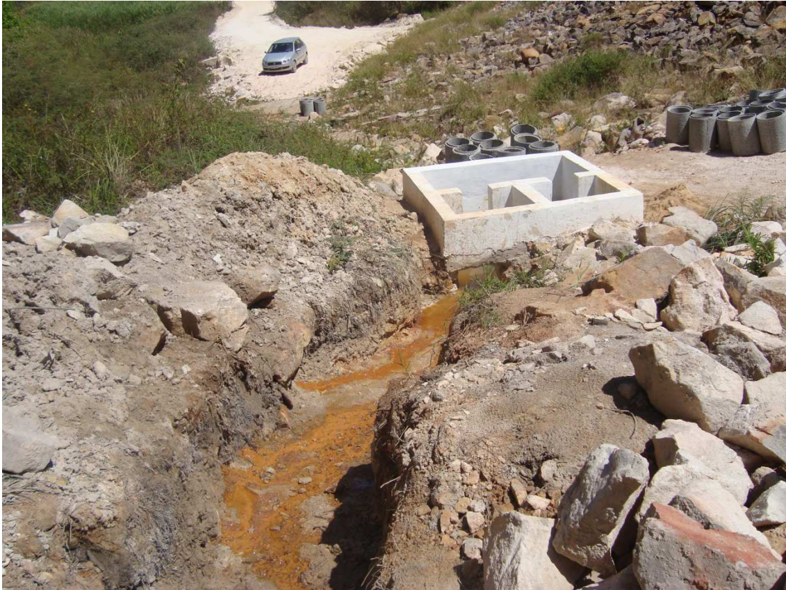
Foto 69 – Medidores de vazão 10 e 11. (17/08/2010)
