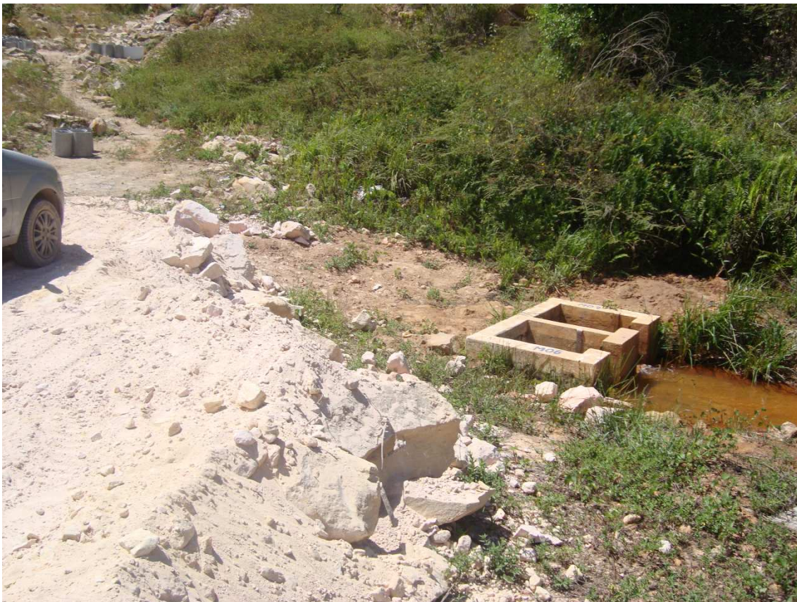
Foto 70 – Medidores de vazão 06 e 07. (17/08/2010)
