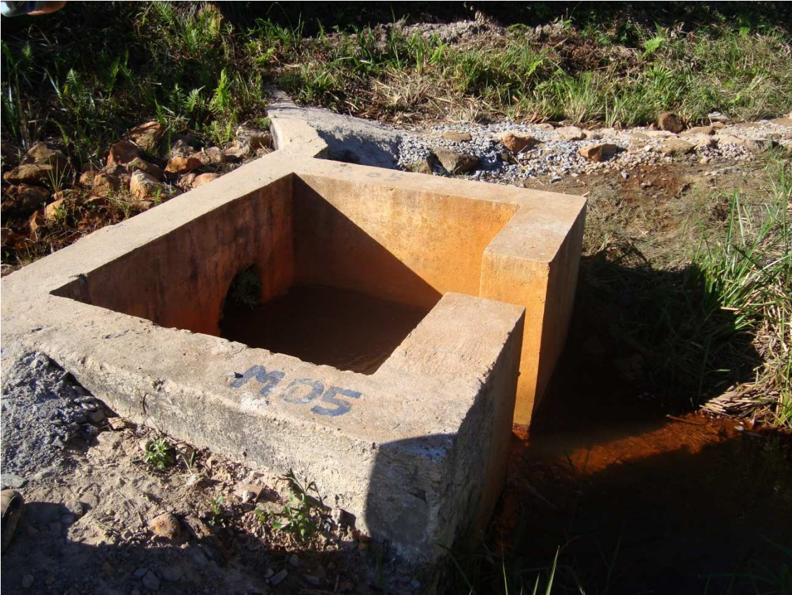
Foto 53 – Medidor de Vazão 05. (30/07/2010)
