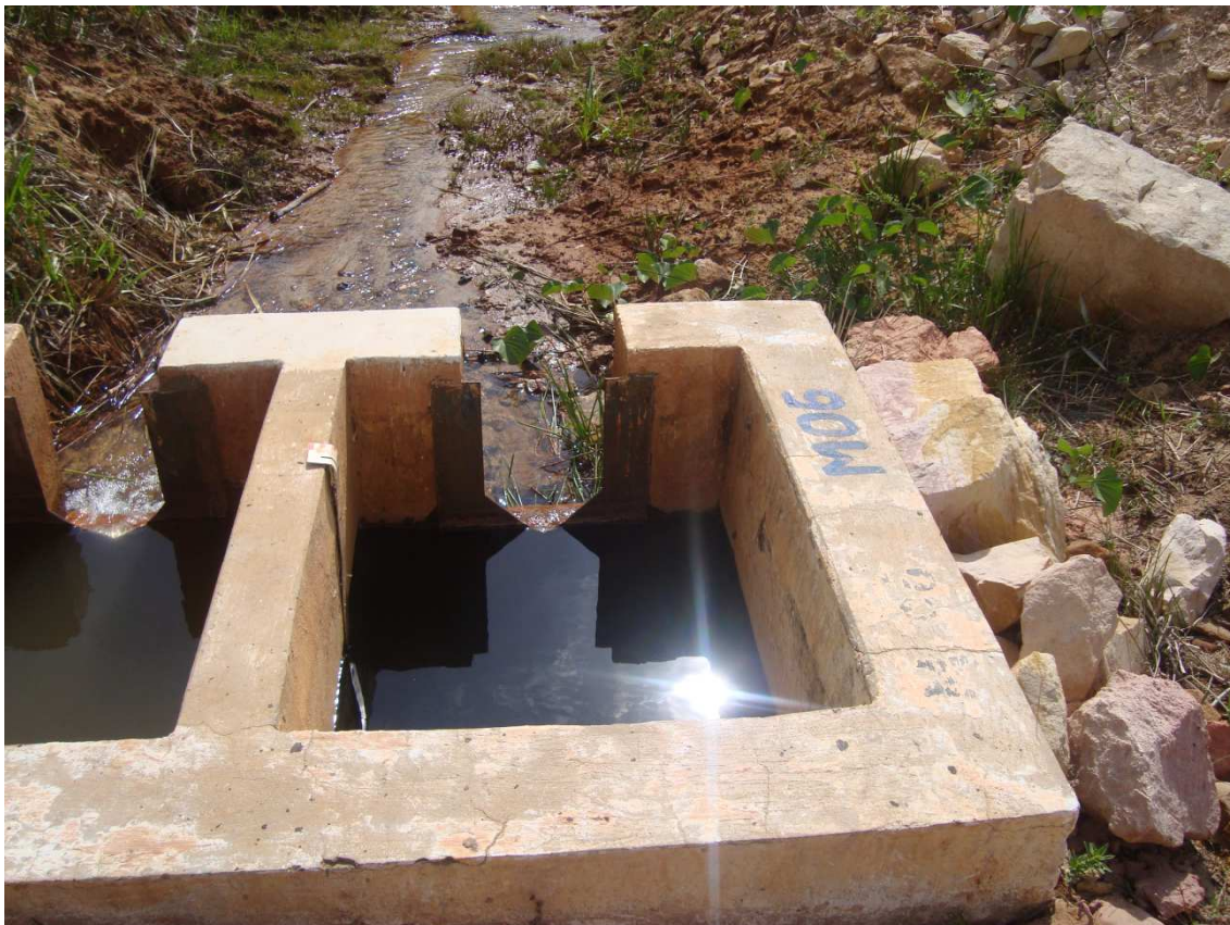
Foto 96 – Medidor de Vazão 06. (28/10/2010)
