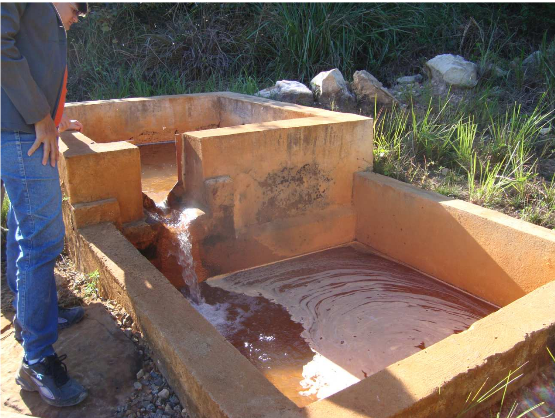
Foto 54 – Medidor de Vazão 04. (30/07/2010)
