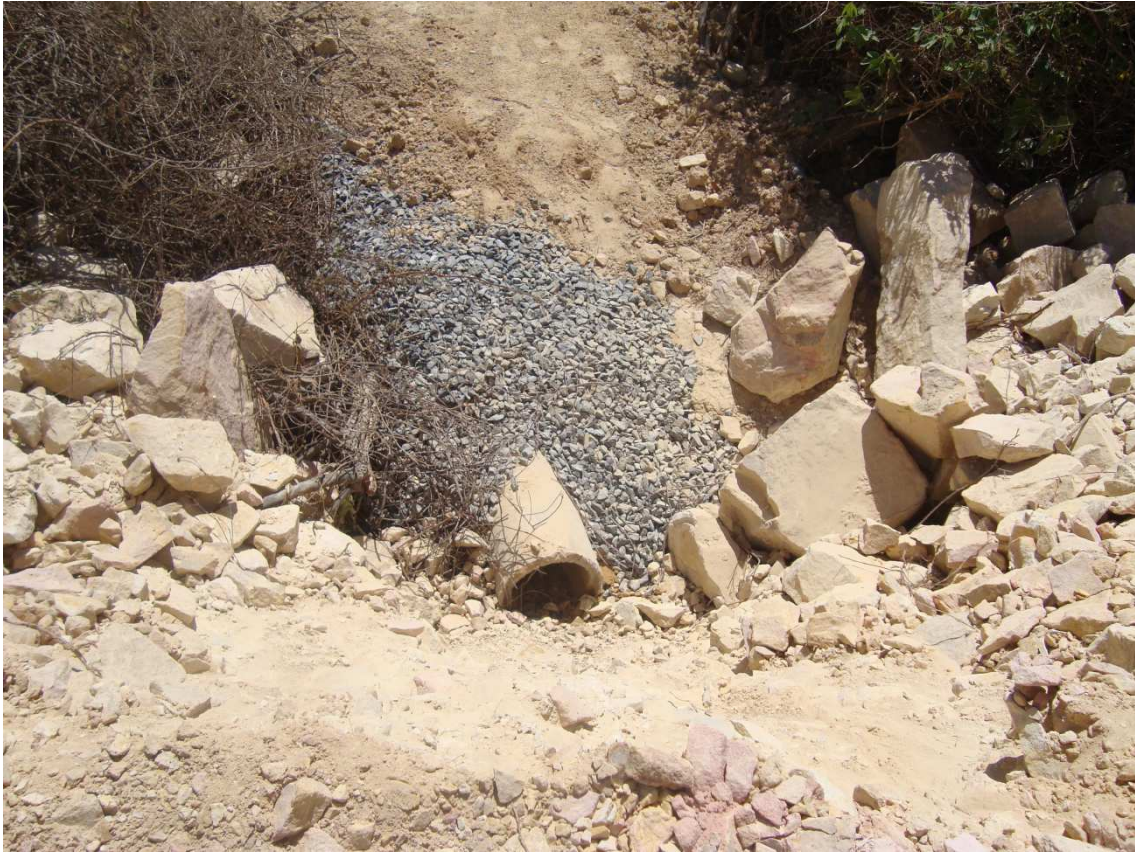
Foto 71 – Dreno coletor proveniente do Medidor de Vazão 12. (17/08/2010)
