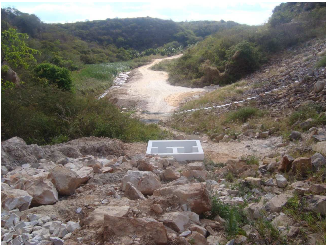
Foto 77 – Medidores de Vazão 10 e 11. (02/09/2010)
