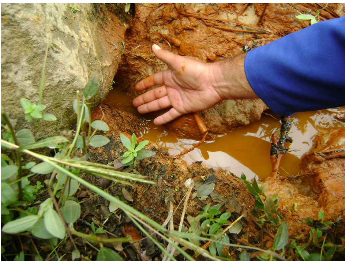
Foto 40 – Revência na ombreira esquerda durante a injeção de asfalto. (24/06/2010)
