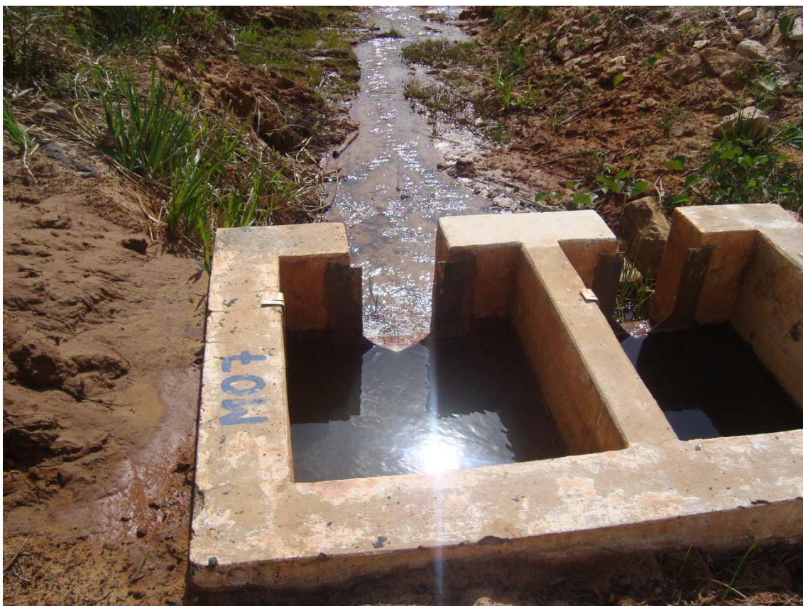
Foto 95 – Medidor de Vazão 07. (28/10/2010)
