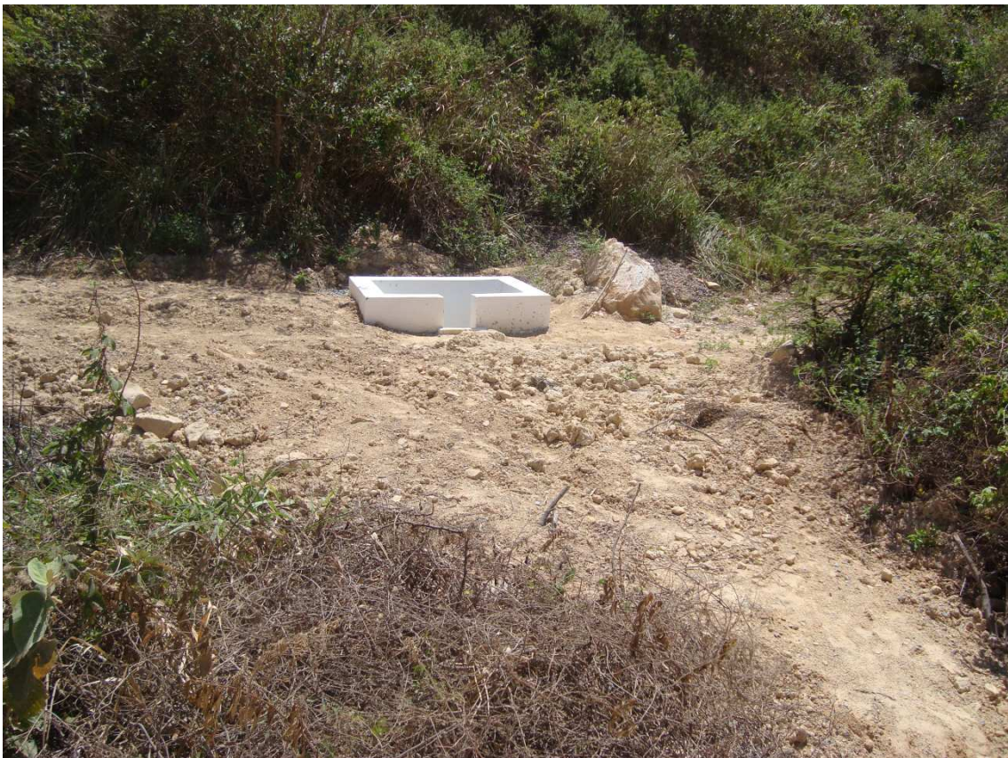
Foto 72 – Medidor de Vazão 12. (17/08/2010)
