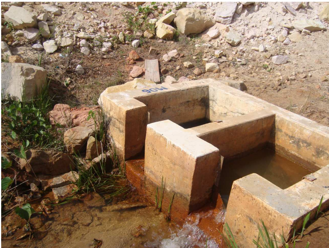
Foto 97 – Medidores de Vazão 06 e 07. (28/10/2010)
