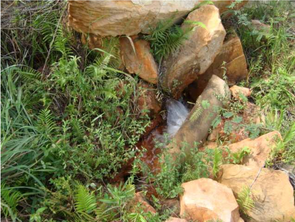
Foto 19 – Revência localizada na meia encosta da ombreira esquerda. (13/05/2010)
