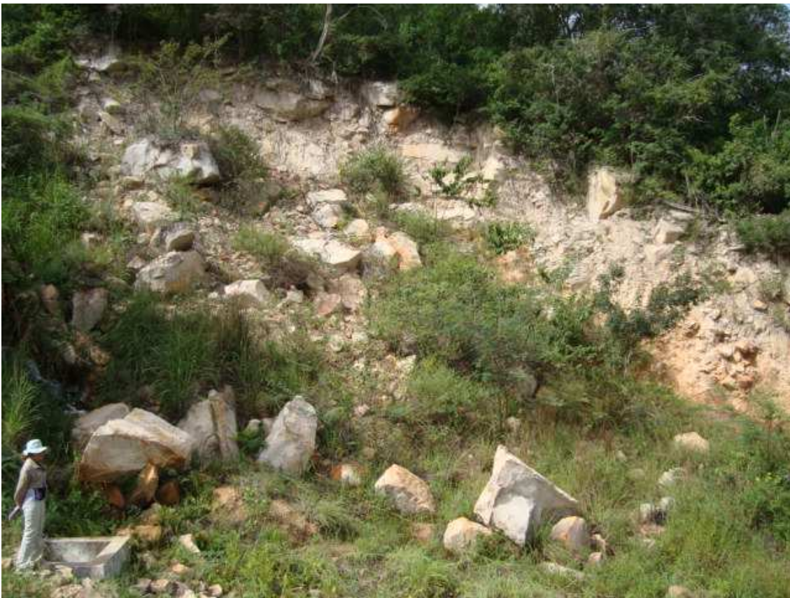
Foto 20 – Erosão na ombreira esquerda . (13/05/2010)
