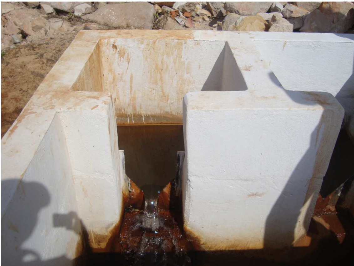
Foto 98 – Medidor de Vazão 10. (28/10/2010)
