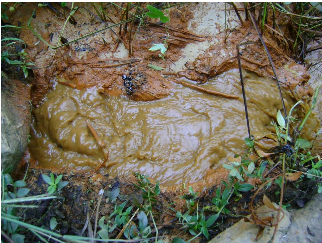
Foto 39 – Revência na ombreira esquerda durante a injeção de asfalto. (24/06/2010)
