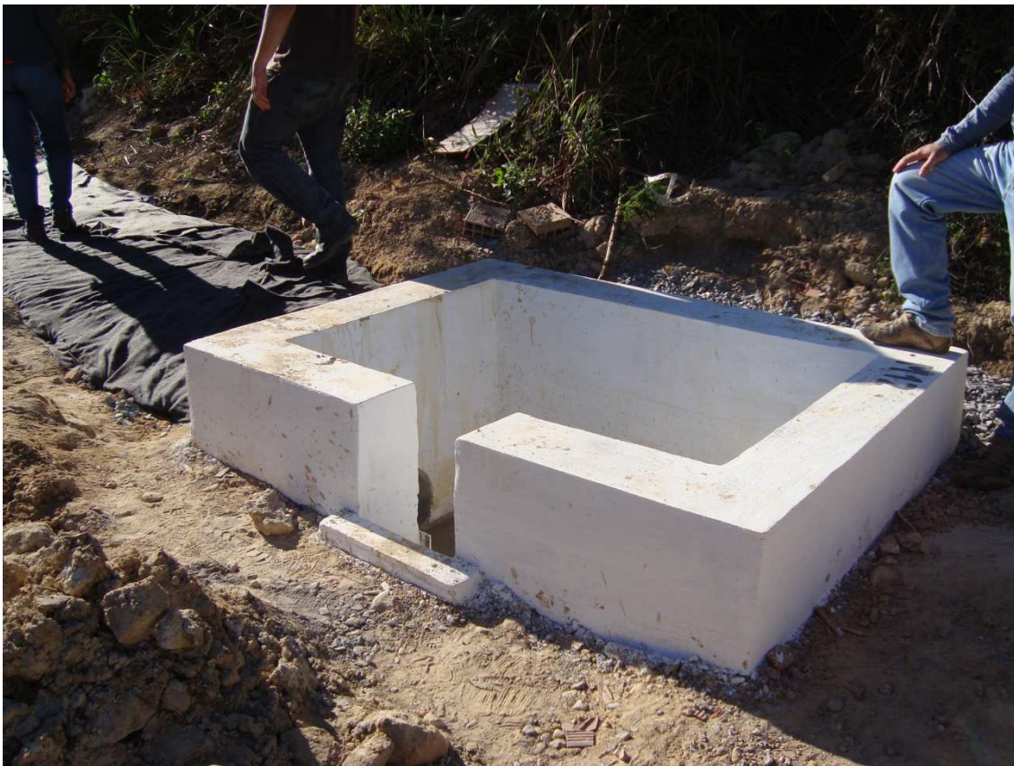
Foto 52 – Medidor de Vazão 12. (30/07/2010)
