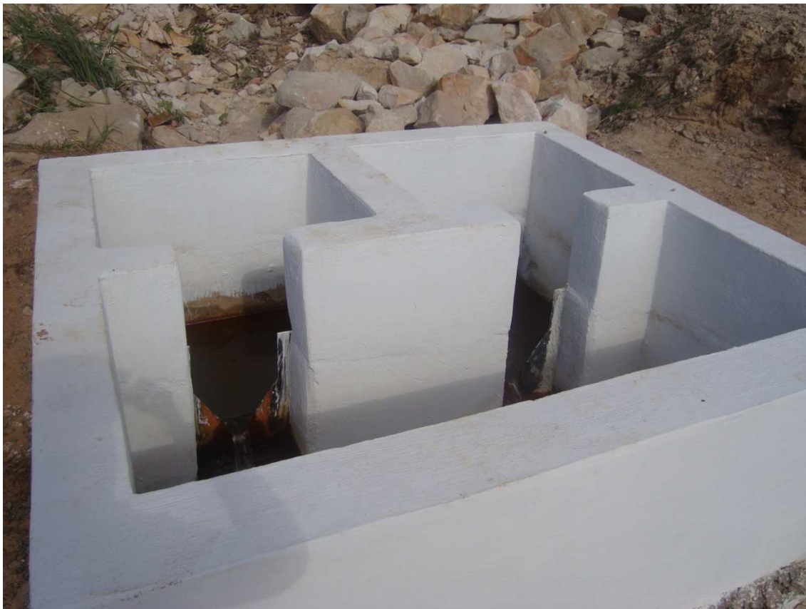
Foto 78 – Medidores de Vazão 10 e 11. (02/09/2010)
