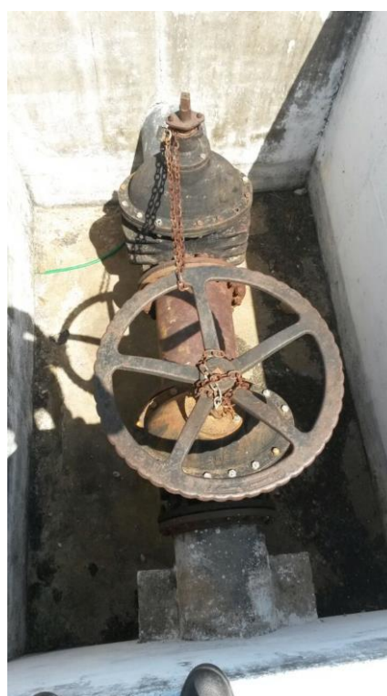
Figura 9 – Registro de manobra da tomada d'água
