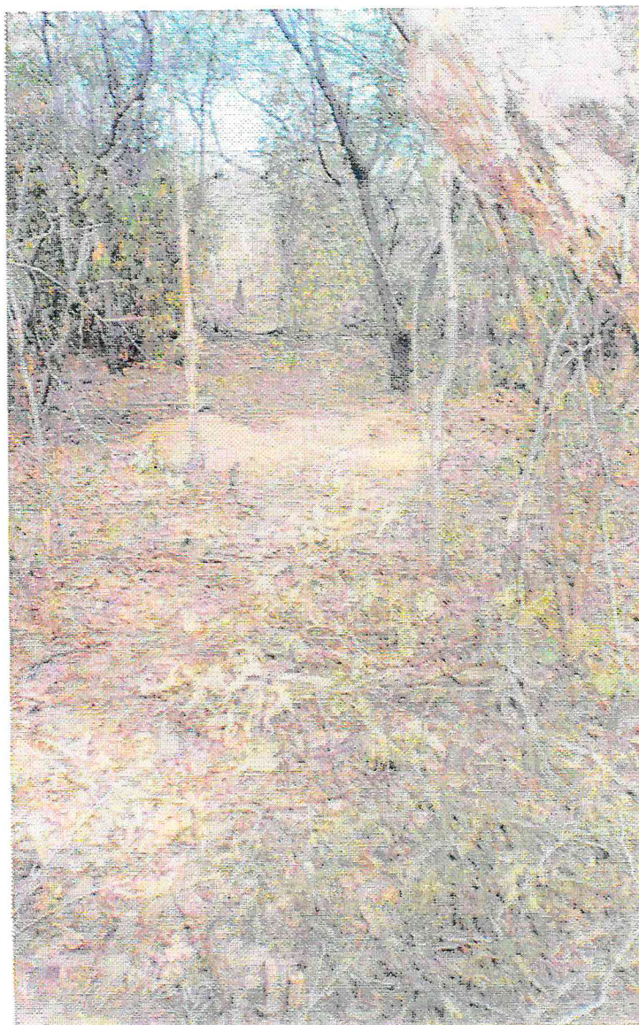
FOTO N° 07 – Vista a partir da ombreira direita da barragem auxiliar, onde nota-se o furo de sondagem SPP-03A, onde escavou-se 1,30m em solo argilo-siltoso.
