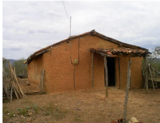
Foto 11 – Habitação de taipa na área da bacia hidráulica do futuro reservatório (E-300.897; N-9.577.488).
