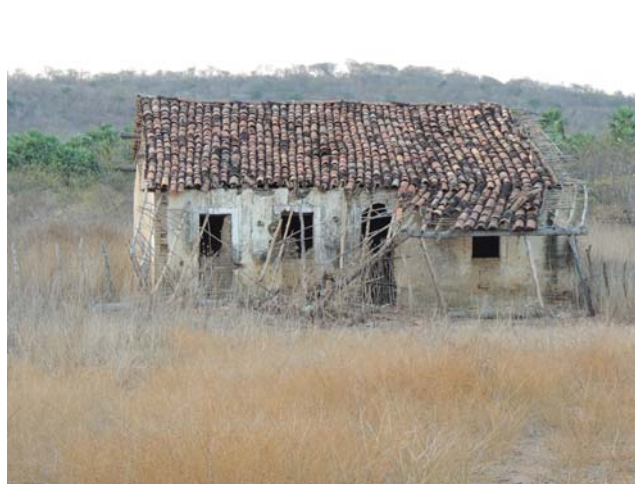
Foto 4.1.4 – Casa de alvenaria de tijolos abandonada e em ruínas. (E=303.923; N=9.680.436)
