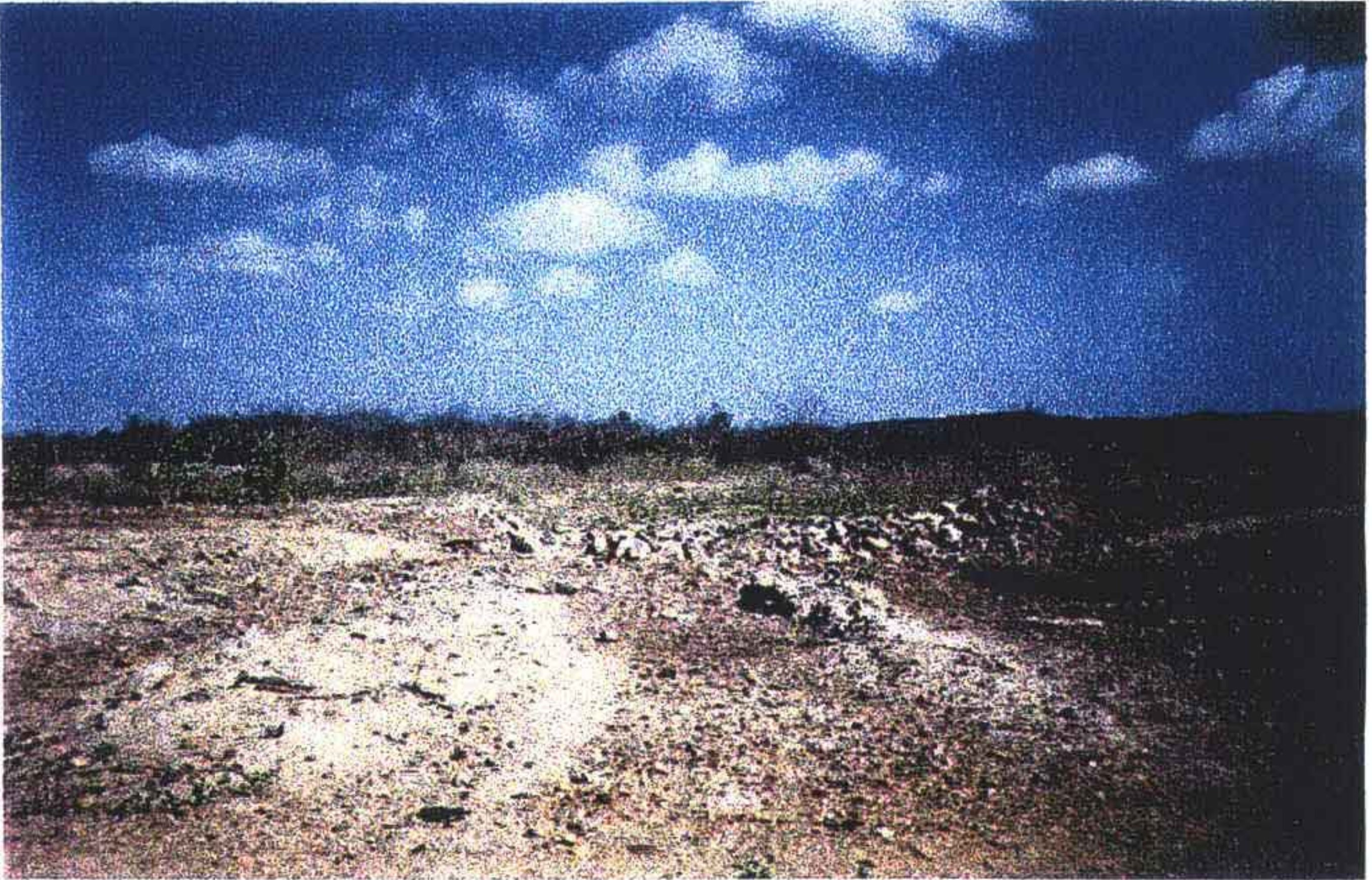
FOTO 03 – TRECHO DA BARRAGEM DIAMANTINO II, ROMPIDO PELAS CHUVAS DO INVERNO DE 1997
