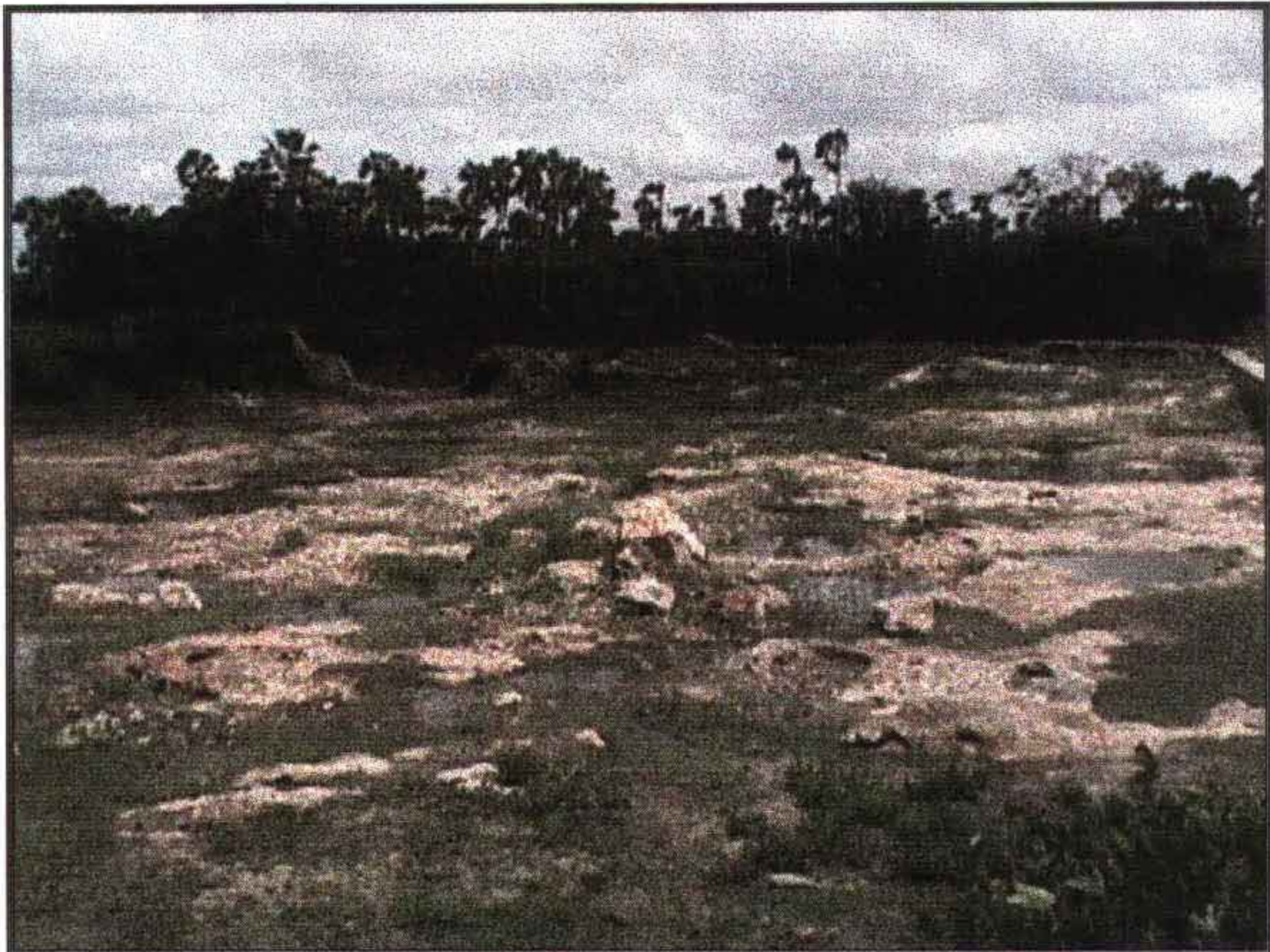
Foto nº 06: Trecho rompido do barramento na margem esquerda do rio, ao fundo.
