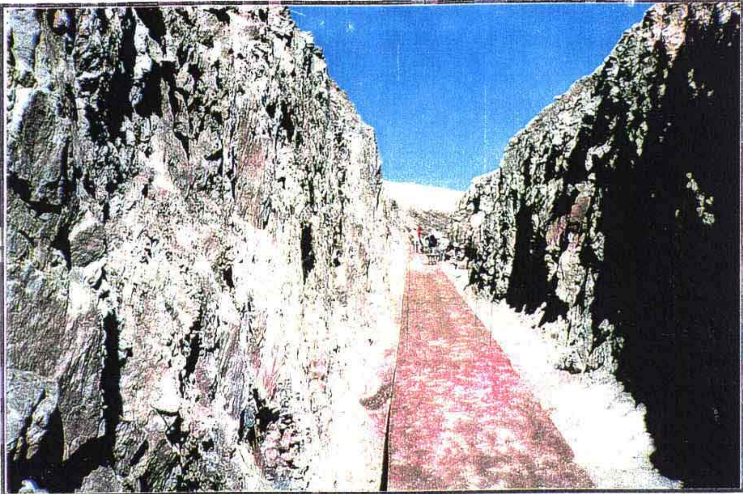
TOMADA D'ÁGUA – CONCRETO DE REGULARIZAÇÃO EXECUTADO, COM CAMADA DE AREIA UMEDECIDA PARA A CURA.
