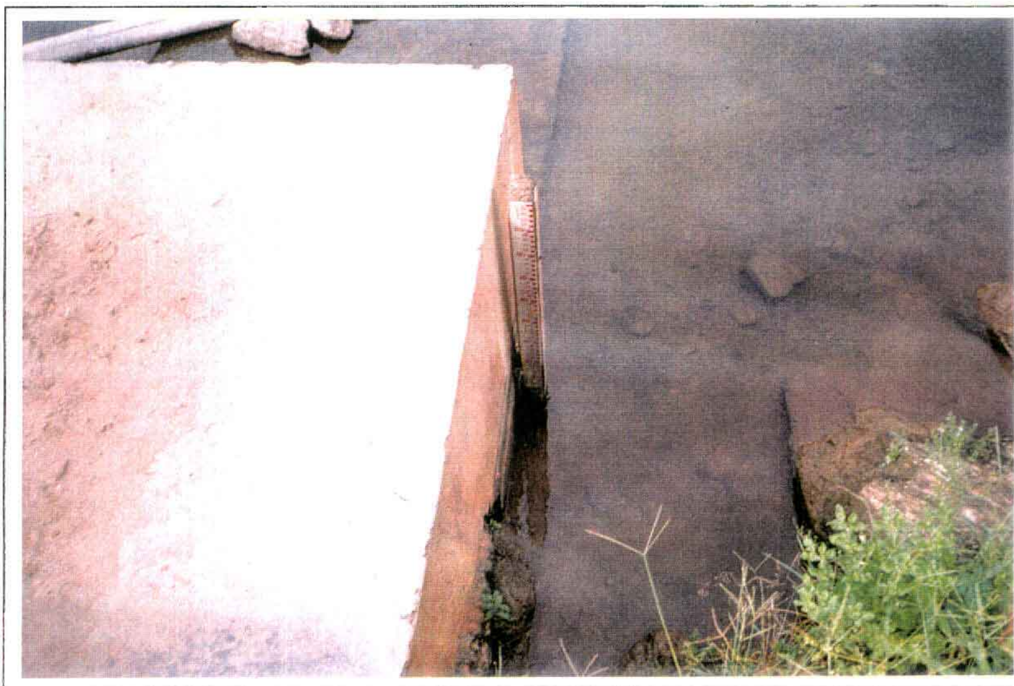
FOTO 75 - ESTAÇÃO FLUVIOMÉTRICA DO AÇUDE CAXITORÉ - CANAL DE FUGA - 2/2 Código: 3556200
