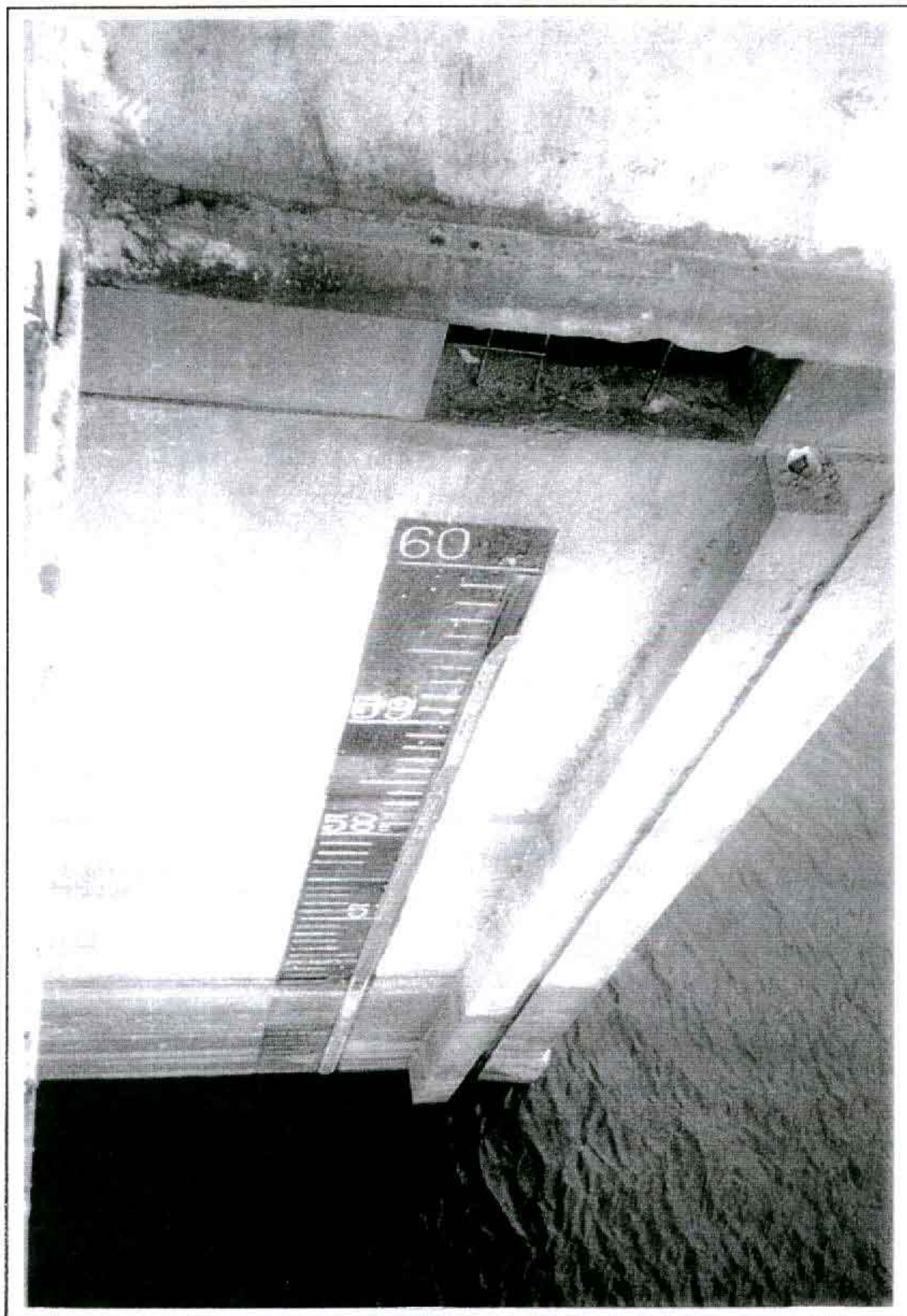
FOTO 67 - ESTAÇÃO LIMNIMÉTRICA DO AÇUDE PEREIRA DE MIRANDA - 2/3
