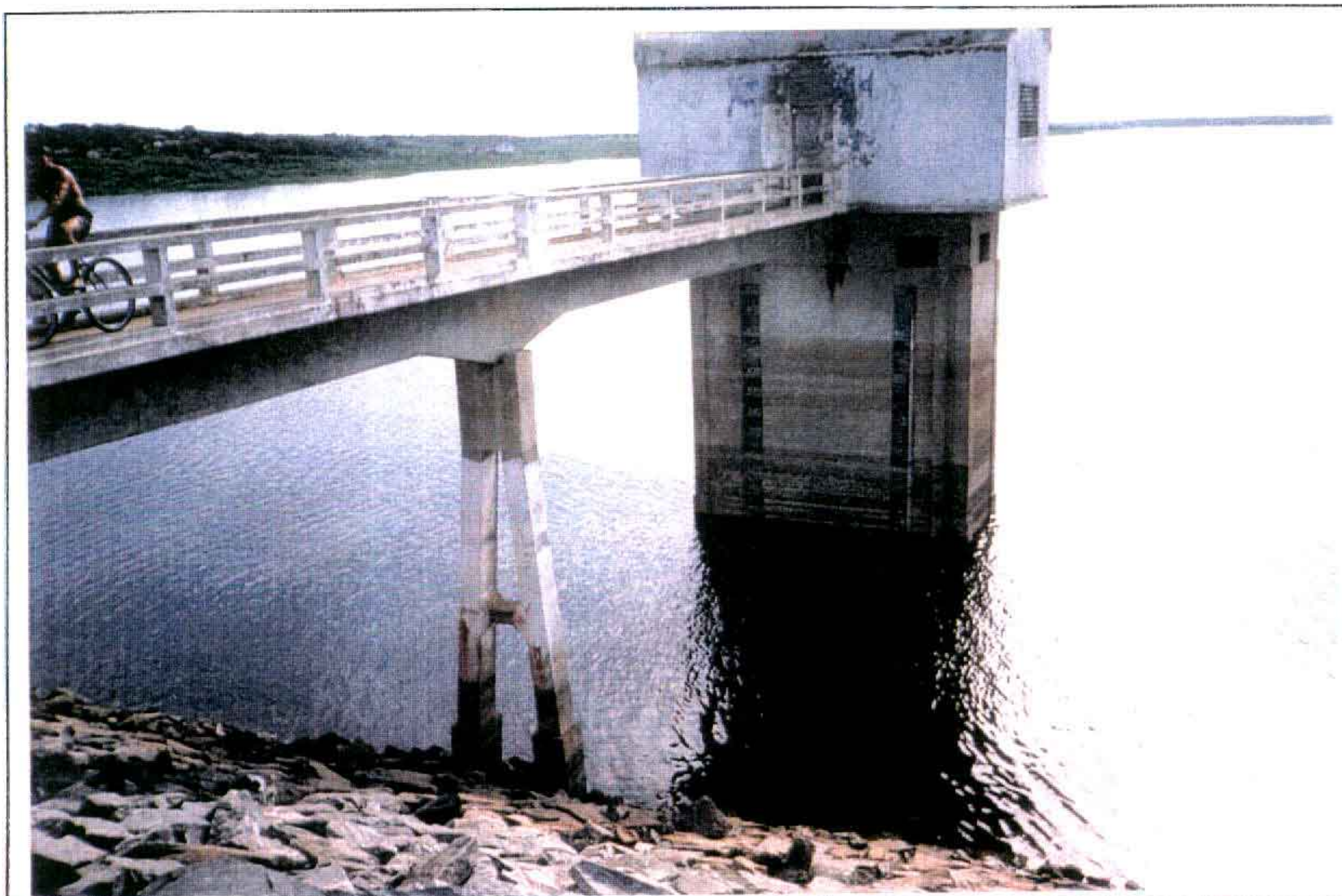
FOTO 68 - ESTAÇÃO LIMNIMÉTRICA DO AÇUDE PEREIRA DE MIRANDA - 3/3
