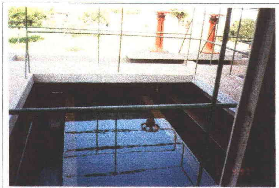
FOTO Nº 9 - DETALHE DE UM DOS FILTROS DA ETA DO MUNICÍPIO DE ICÓ - CE
