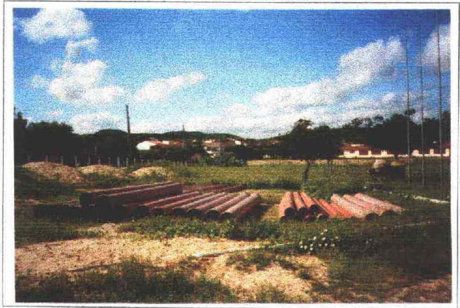
FOTO Nº 11 - LOCAL PARA A INSTALAÇÃO DA NOVA ESTAÇÃO DE TRATAMENTO DE ÁGUA DO MUNICÍPIO DE ICÓ - CE
