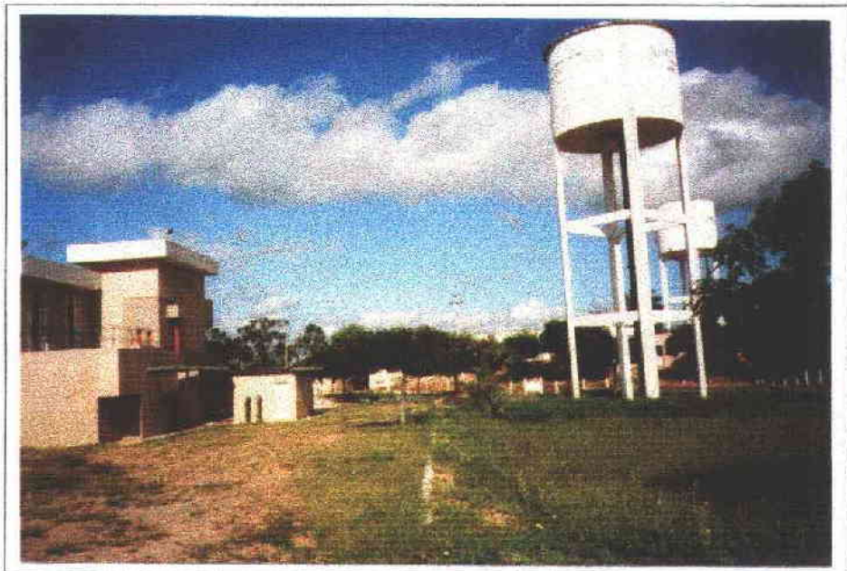
FOTO Nº 8 - ETA E RESERVATÓRIOS ELEVADOS ( EM 1º PLANO RESERVATÓRIO P/ LAV. FILTROS E AO FUNDO RESERVATÓRIO DE ABASTECIMENTO)
