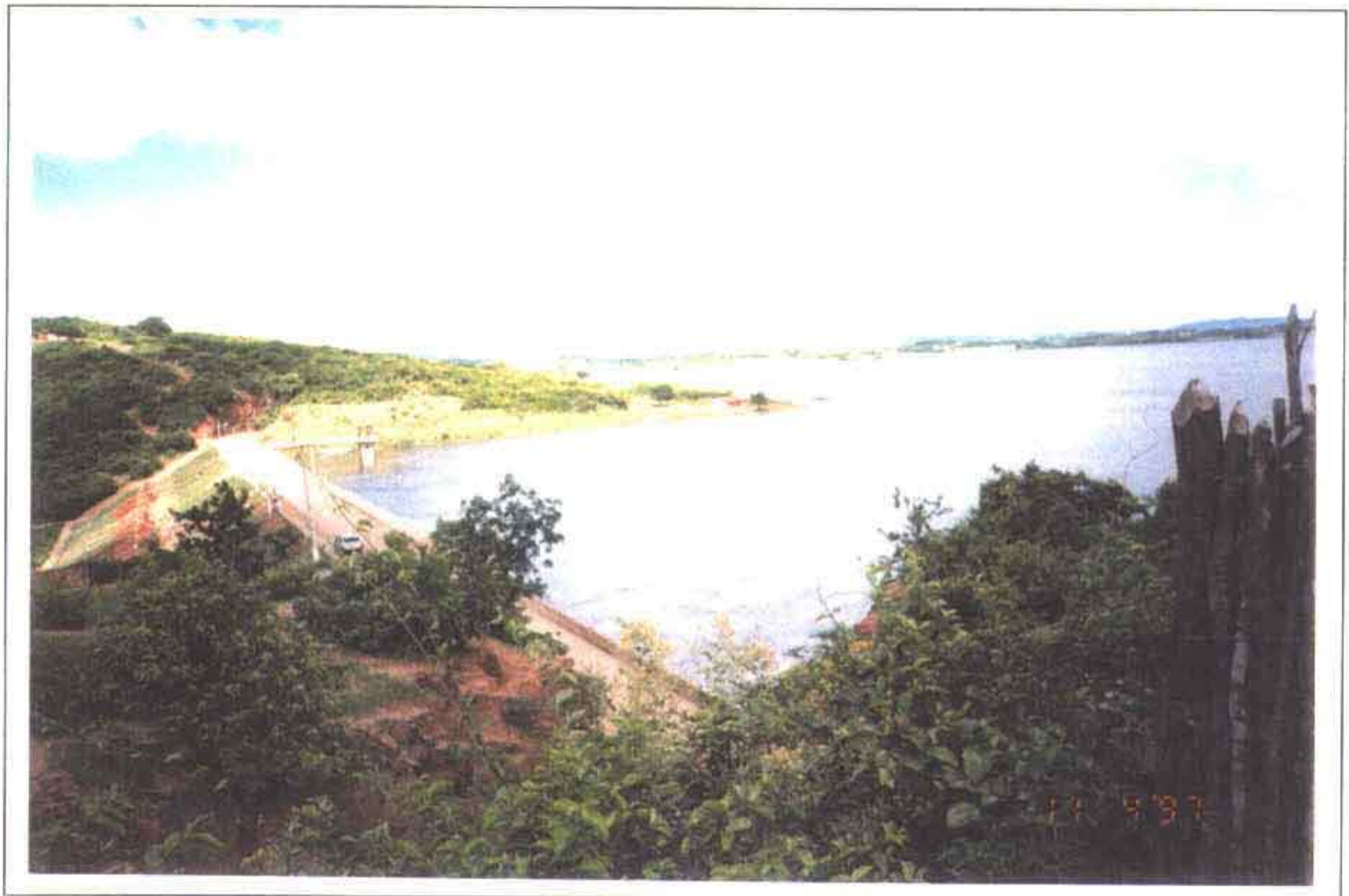
FOTO Nº 2 - VISTA DA BARRAGEM E TALUDE DE JUSANTE DO AÇUDE LIMA CAMPOS - CE
