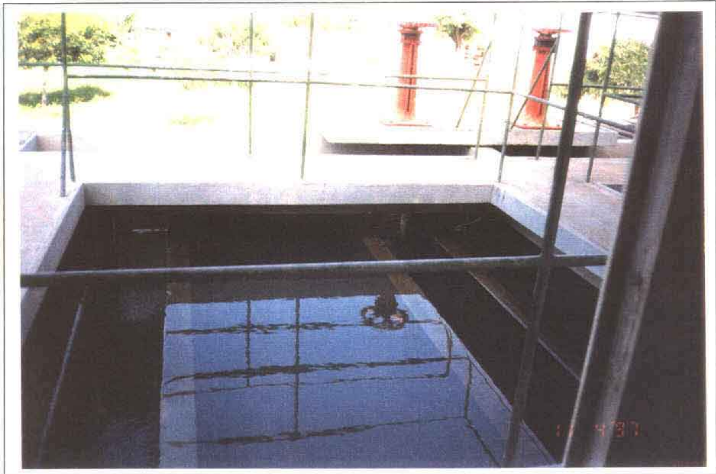
FOTO Nº 9 - DETALHE DE UM DOS FILTROS DA ETA DO MUNICÍPIO DE ICÓ - CE
