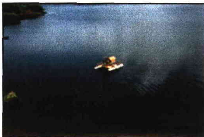
FOTO 02 - ESTAÇÃO ELEVATÓRIA FLUTUANTE DO SISTEMA IPAGUASSÚ - MIRIM / MASSAPÉ, SITUADA DENTRO DO LAGO DO AÇUDE.
