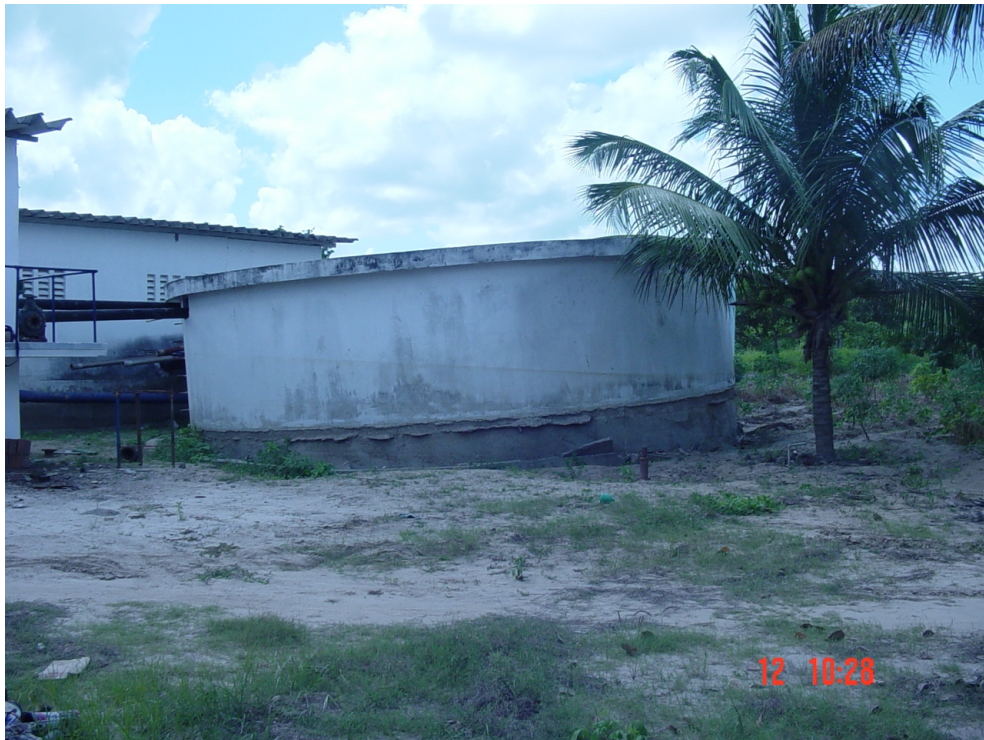
FOTO 5 – Detalhe do reservatório de 200 m 3 tombado em função das cheias ocorridas no local. A linha d'água ainda pode ser percebida.
