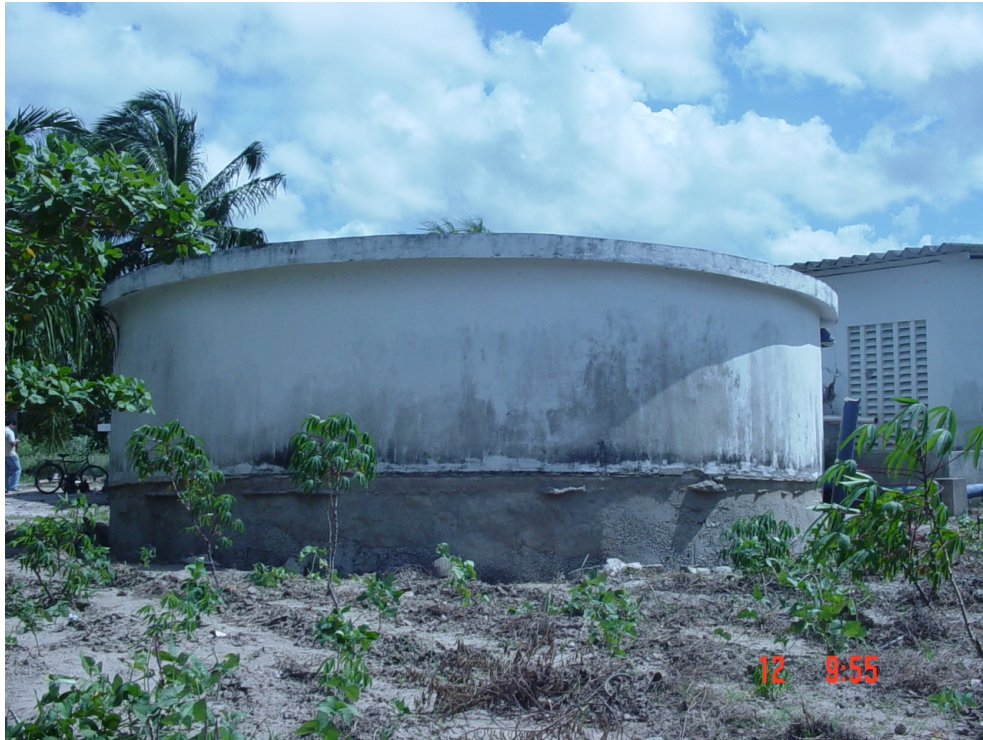
FOTO 13 – Detalhe mostra quanto o RAP foi levantado em função da subpressão exercida em sua fundação.
