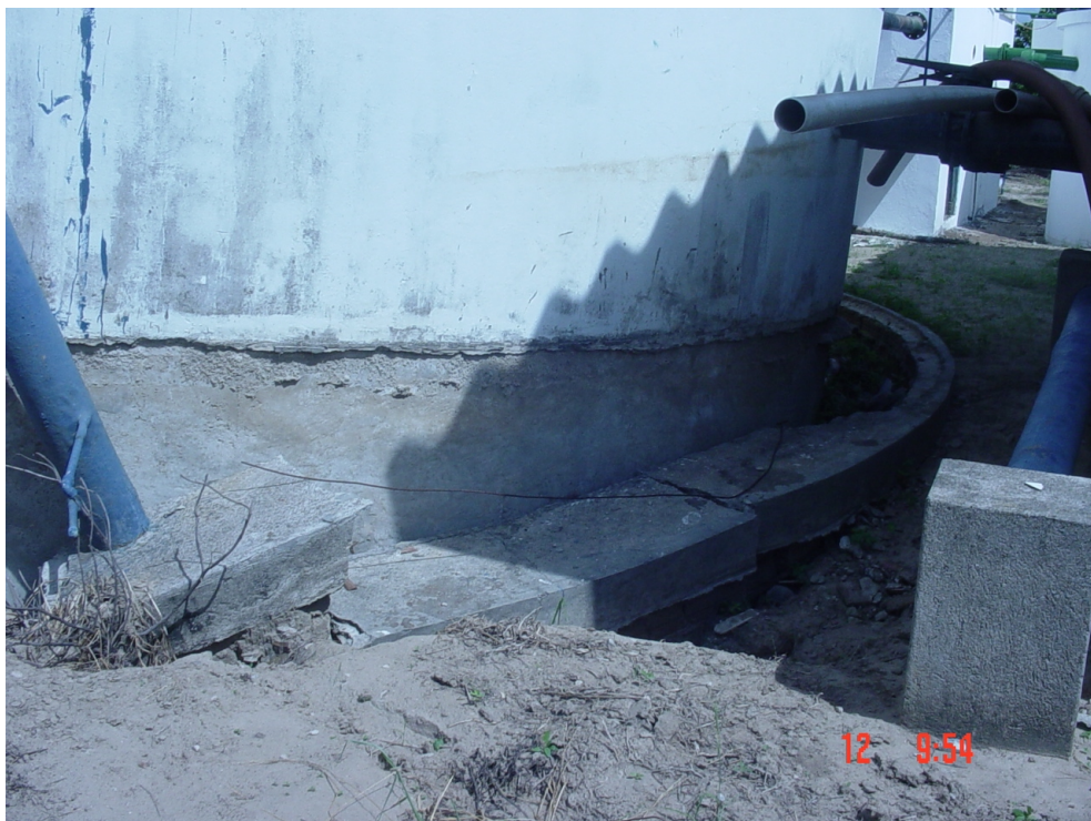
FOTO 14 – Calçada que circunda todo o reservatório totalmente destruída.
