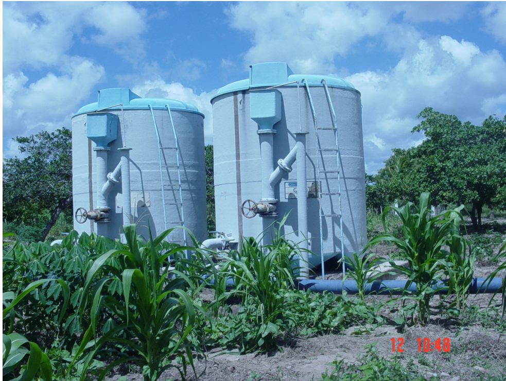
FOTO 17 – Filtro instalados na área da ETA. Poderão ser aproveitados em outro sistema
