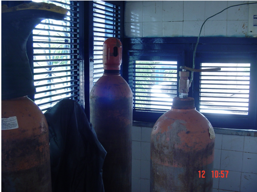
FOTO 15 – Detalhes dos cilindros de cloro utilizados na desinfecção da água bruta do sistema de Amontada.
