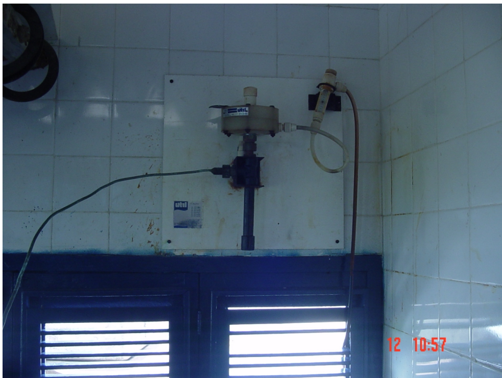
FOTO 16 – Dosador de cloro gasoso
