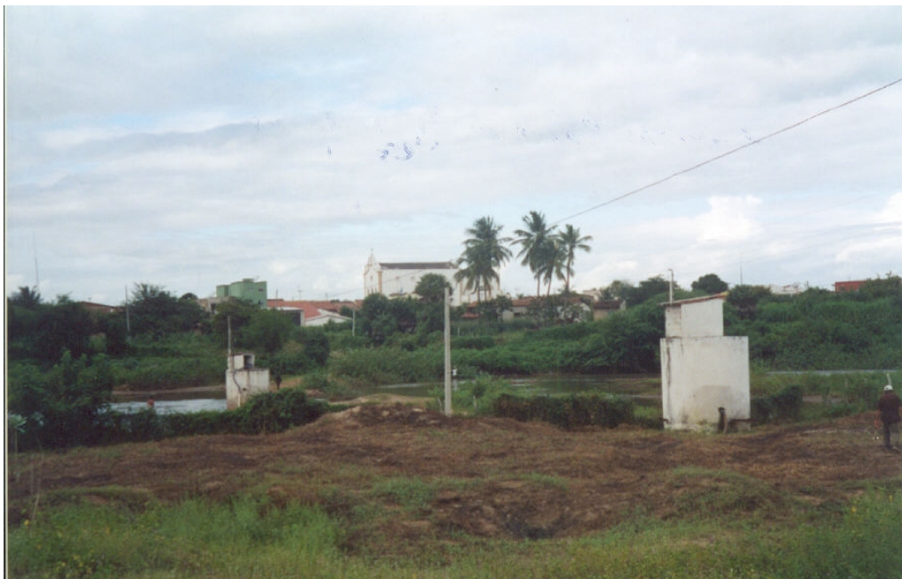
FOTO 4 - SISTEMA EM OPERAÇÃO: Poços amazonas no aluvião do rio Aracatiaçu. Na outra margem a cidade de Amontada
