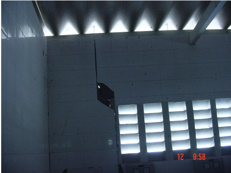
FOTO 11 – Rachaduras na casa de química/casa de bombas.
