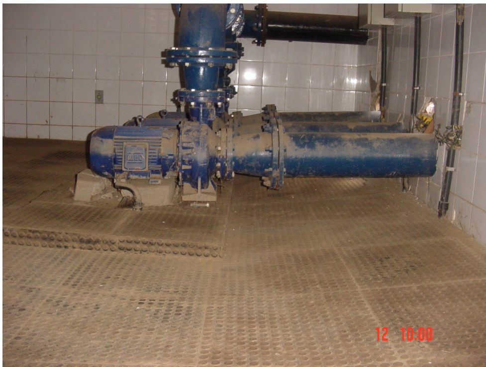
FOTO 10 – Detalhe dos estragos causados pelas cheias. O piso da casa de bombas cedeu, danificando paredes e provocando rachaduras.
