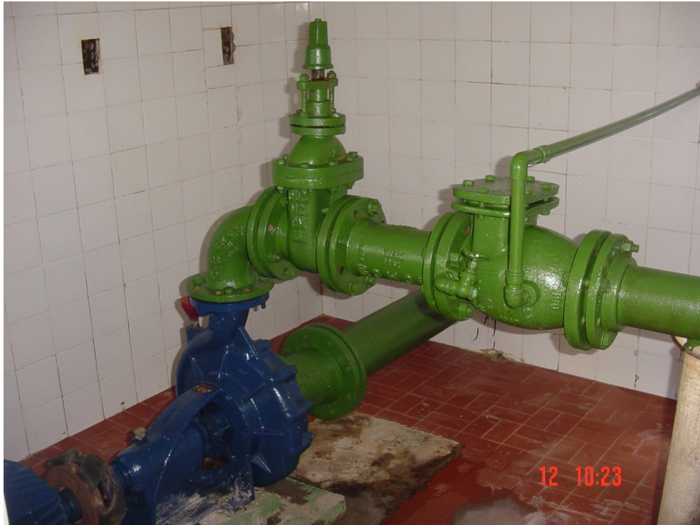
FOTO 7 – Detalhe do CMB responsável pelo recalque de água tratada para o reservatório de Amontada.
