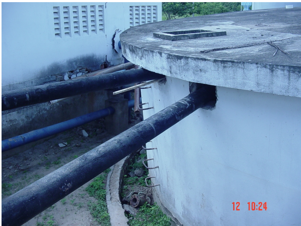
FOTO 6 – Vista dos estragos na casa de química em função do alagamento da área da ETA.
