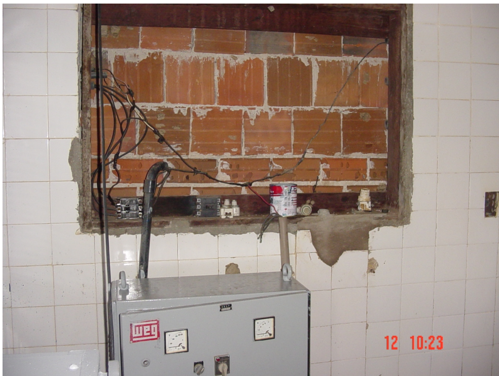
FOTO 8 – Instalações precárias do quadro de comando da estação de bombeamento.
