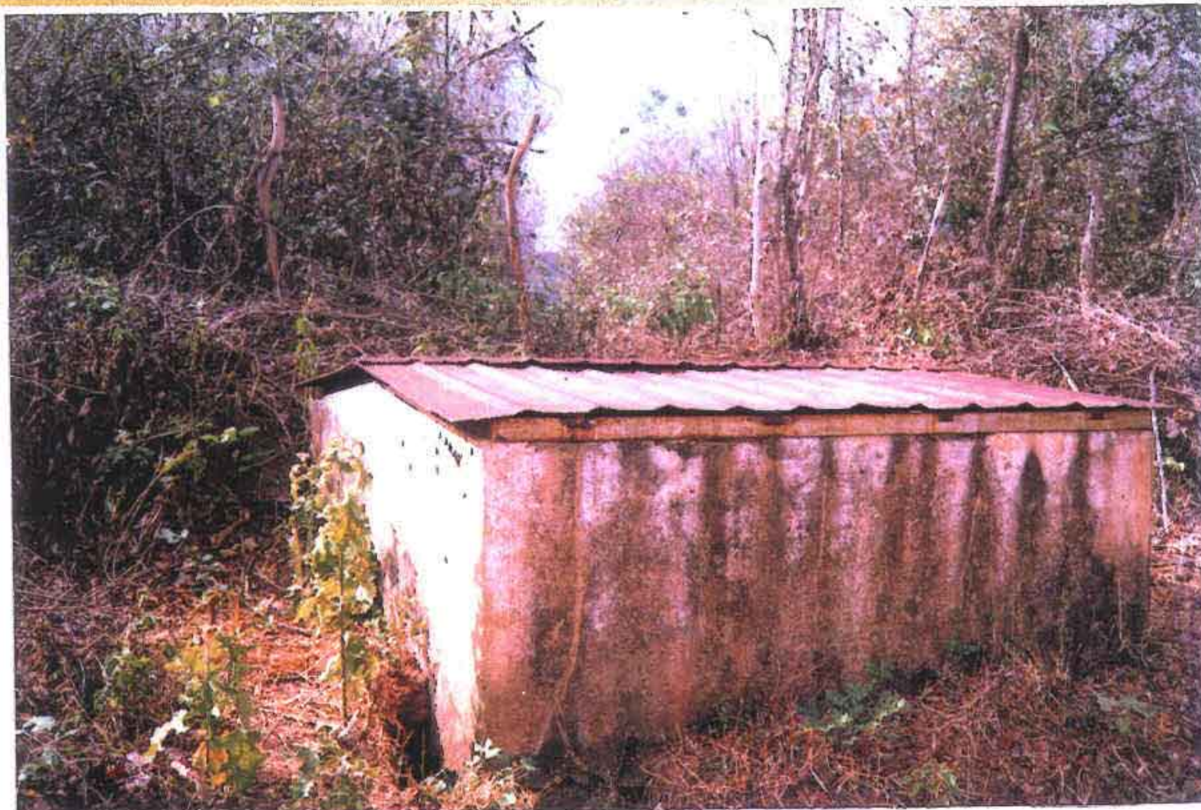
FOTO 1 - CAIXA DE PROTEÇÃO Nº 133 (ESTACA 2259+18,70m) - PONTO DE DERIVAÇÃO DA ADUTORA DE ÁGUA VERDE.
