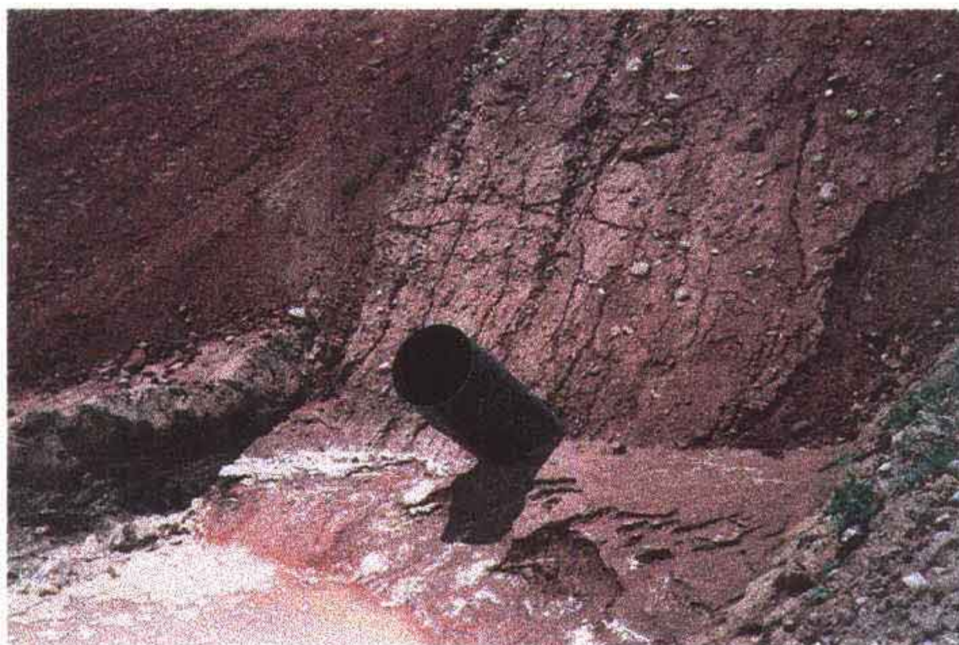
Foto 15 - Extremidade da tubulação quase soterrada a jusante.
