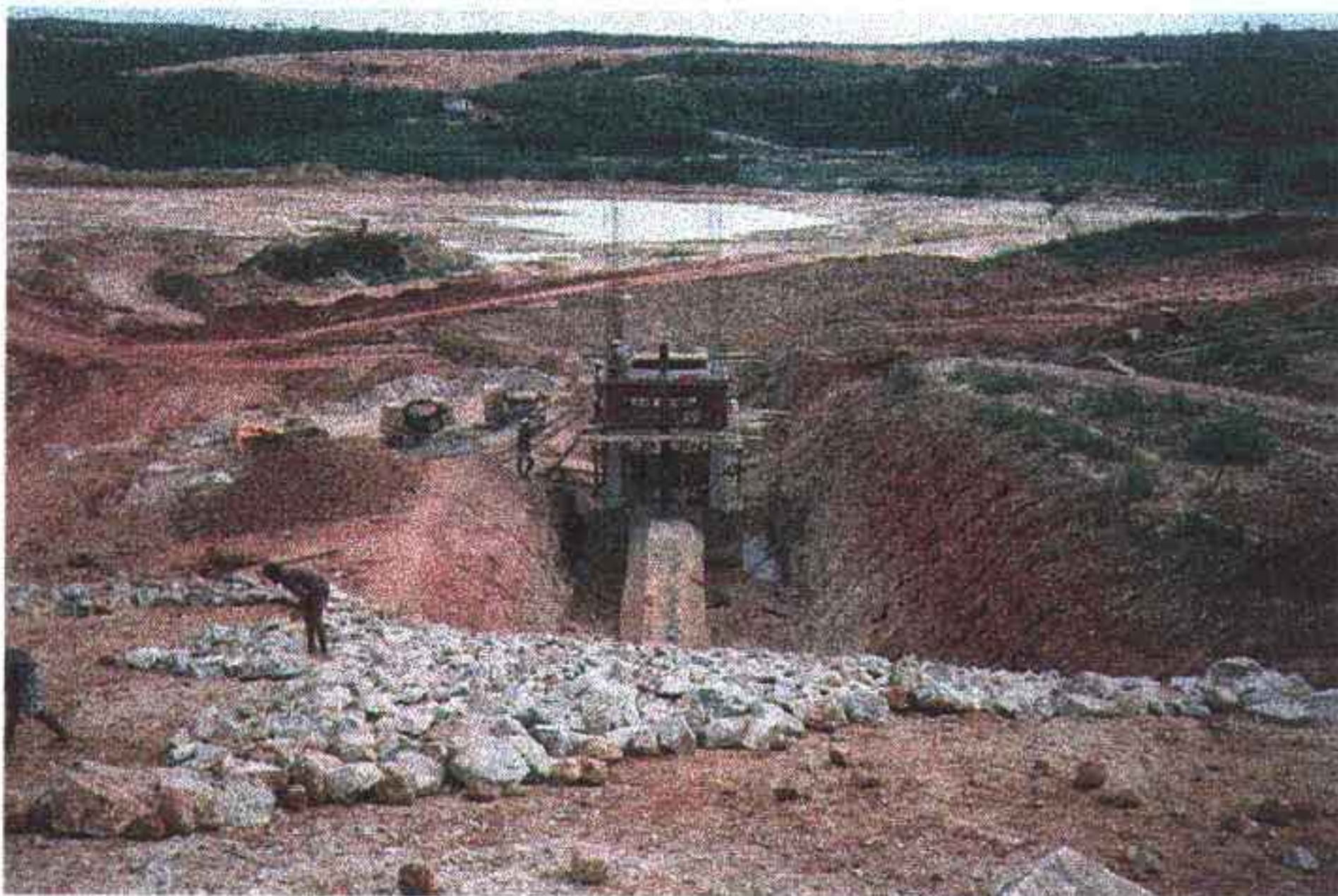
Foto 10 - Vista da estrutura da tomada d'água a montante. Observe o encontro da galeria com a torre e a cava que será preenchida com solo compactado.
