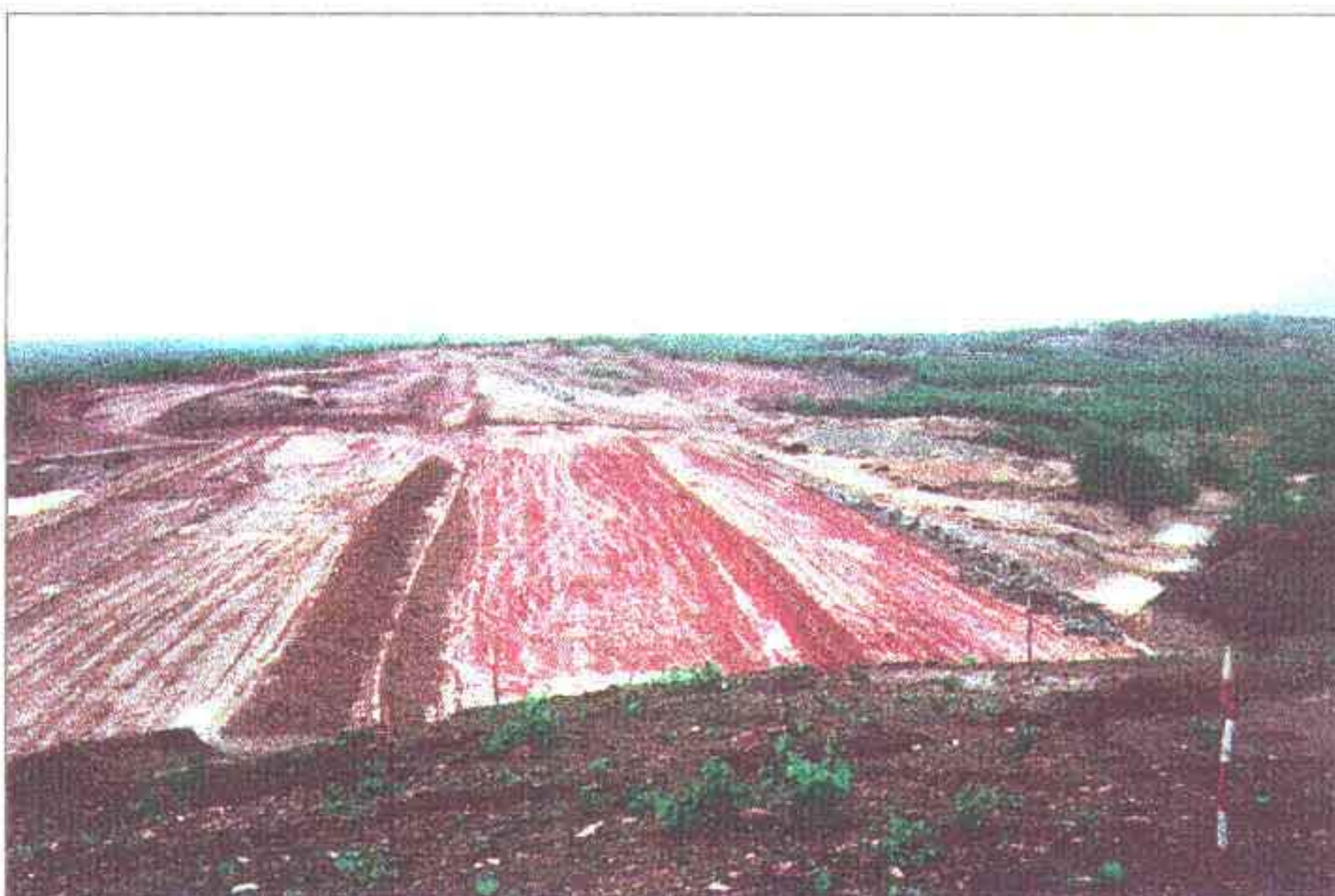
Vista da praça de compactação após chuva. Observe a falta dos equipamentos.
