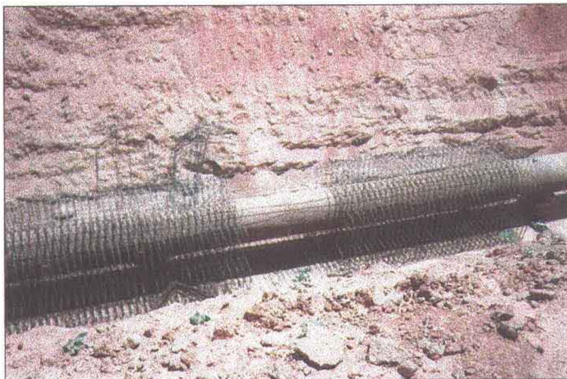
Ferragem de uma seção da galeria em fase de execução. Observe-se a uniformidade do afastamento dos ferros.
