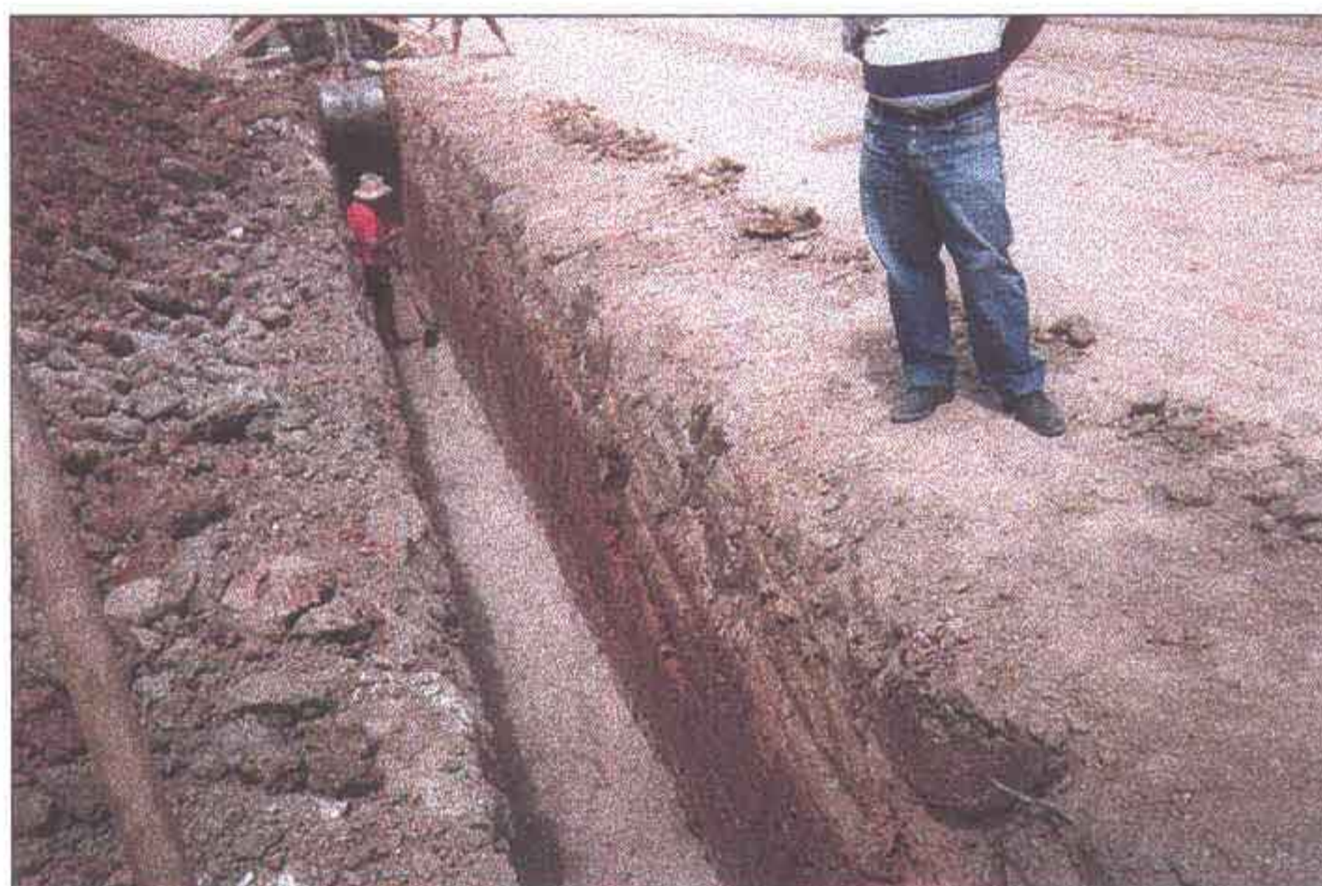
Filtro vertical. Observe-se ao fundo da foto o espalhamento da areia.
