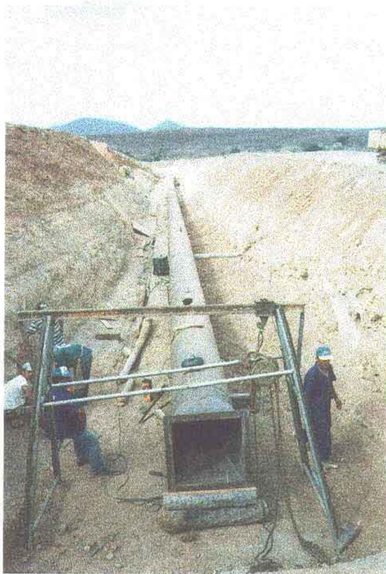
Foto 5 - Tubulação da galeria. Executada em chapas de aço ASTM - Observe-se a transição da seção quadrada para seção circular.
