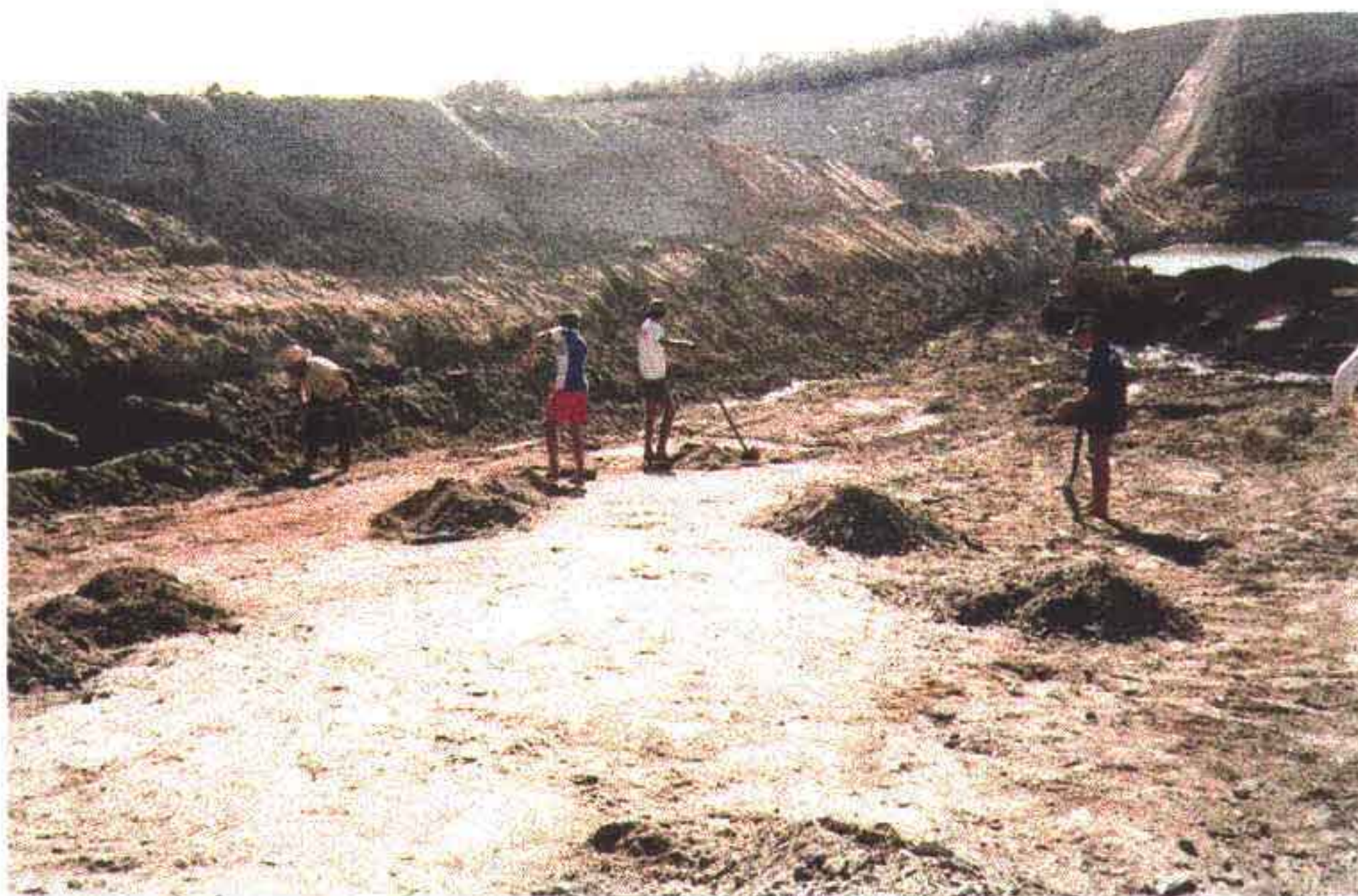
Foto 9 - Limpeza manual do cut-off entre estacas 17 e 19. Lado direito superior vê-se a ombreira direita.
