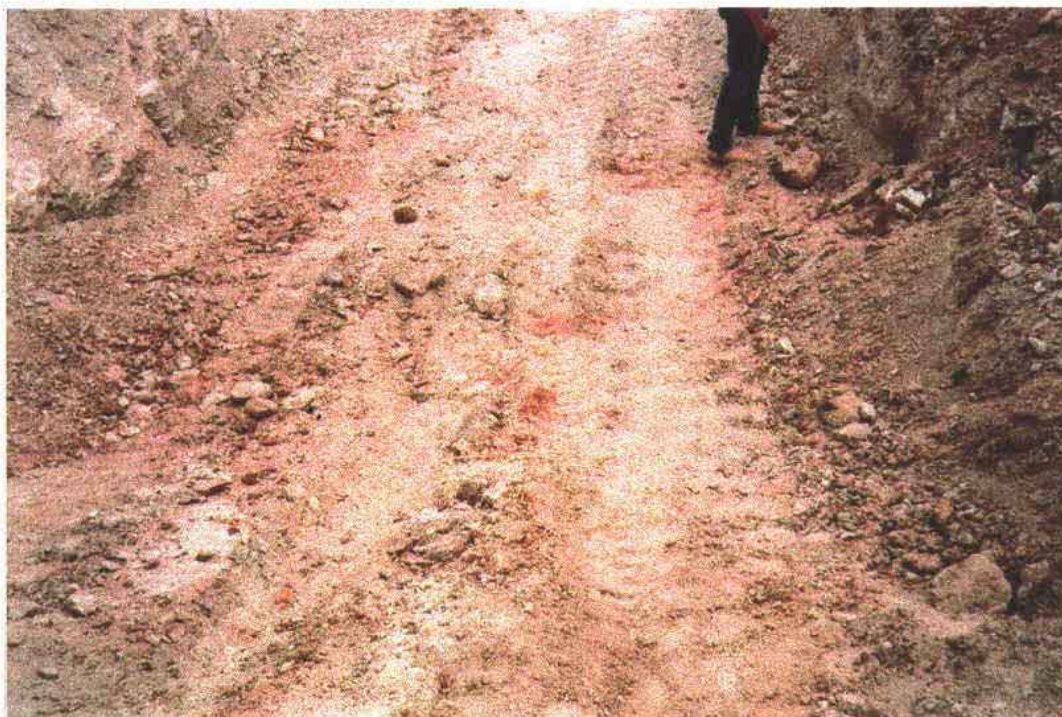
Foto 4 - Local da fundação da torre de controle. Este local será rebaixado para execução do bloco de apoio.
