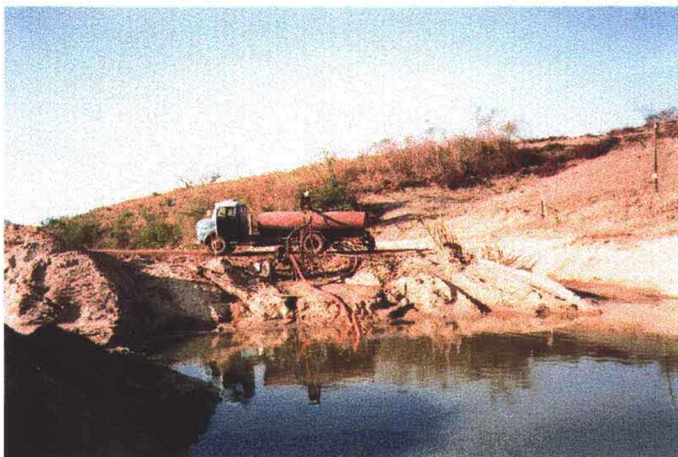
Foto 10 - Bombeamento da água do cut-off entre estacas 19 e 20. A água bombeada é aproveitada na compactação do aterro, pois apresenta ótima qualidade.
