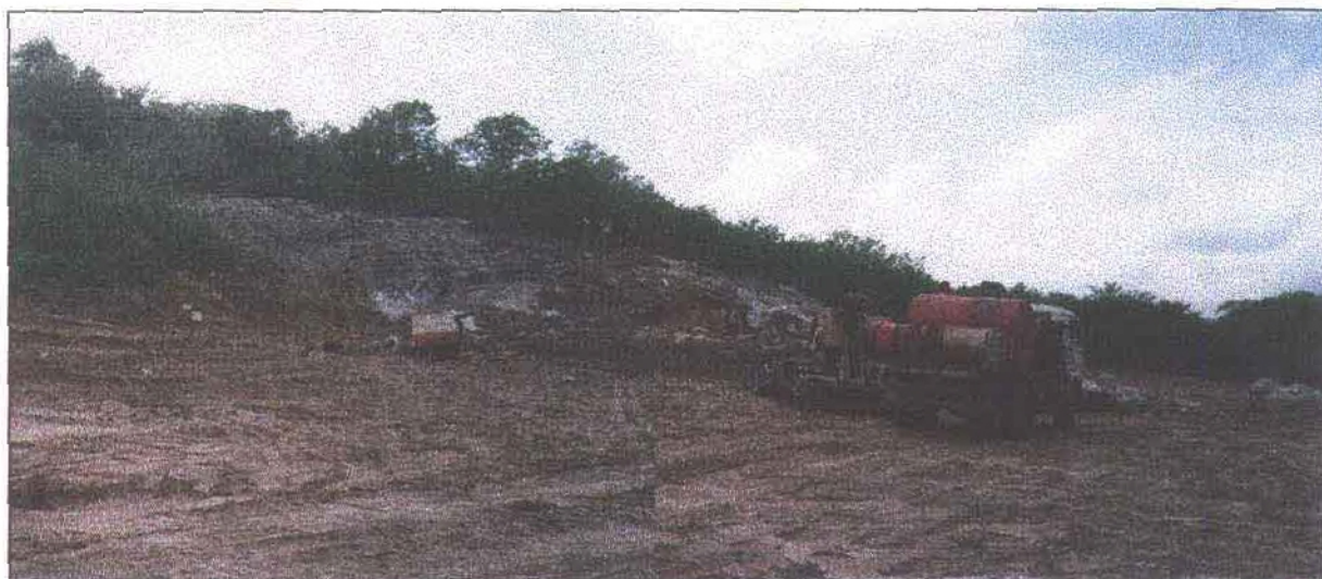
Pedreira N° 03, início de operação de limpeza e preparação de bancada para exploração.
