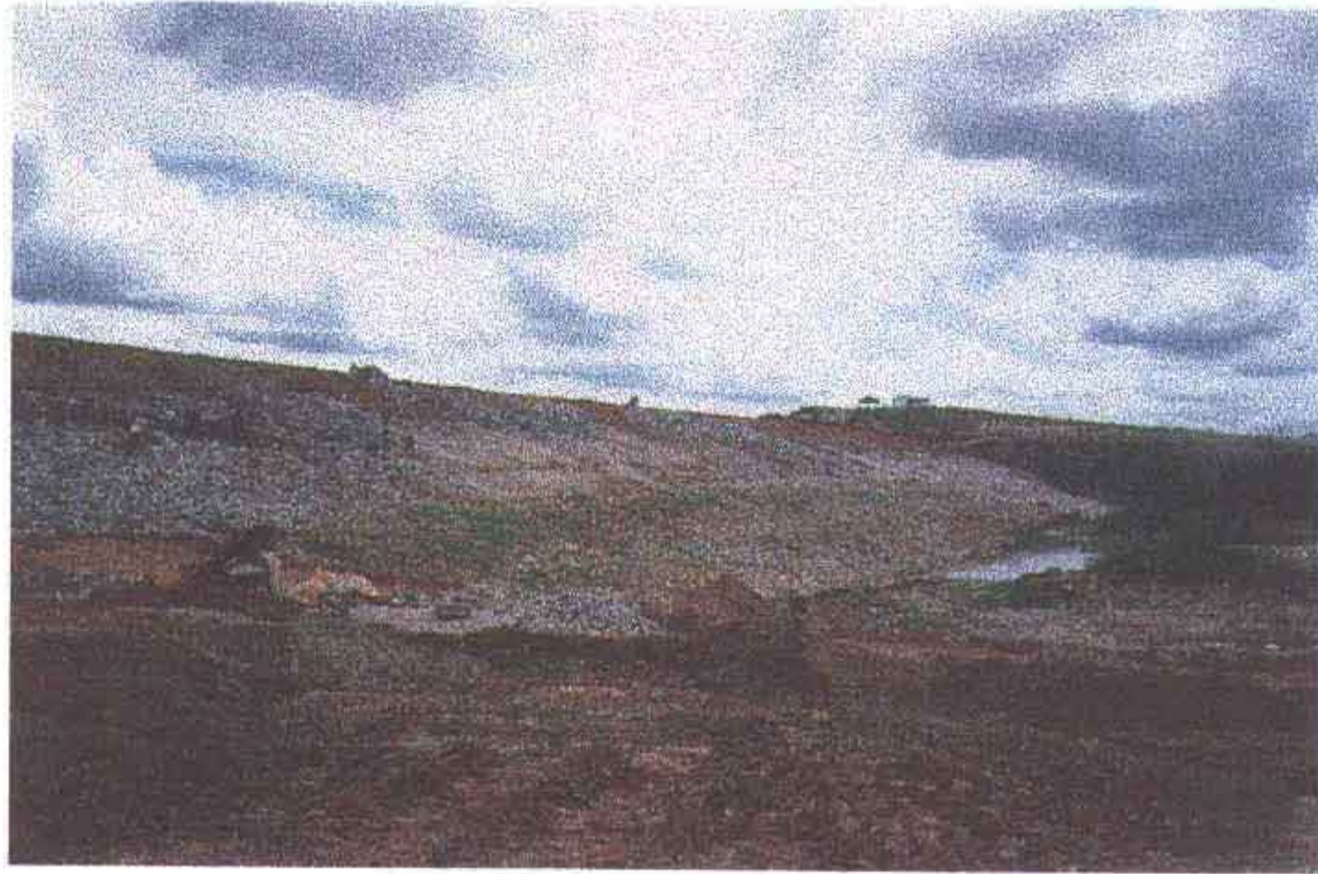
Foto 03 - Aspecto geral do espaldar de montante. Verifique a proteção do talude, onde o trecho mais baixo foi executado com o seixo rolado, enquanto a parte superior já iniciado com bica-corrida. Observe a altura do maciço em relação à execução do "rip-rap".
