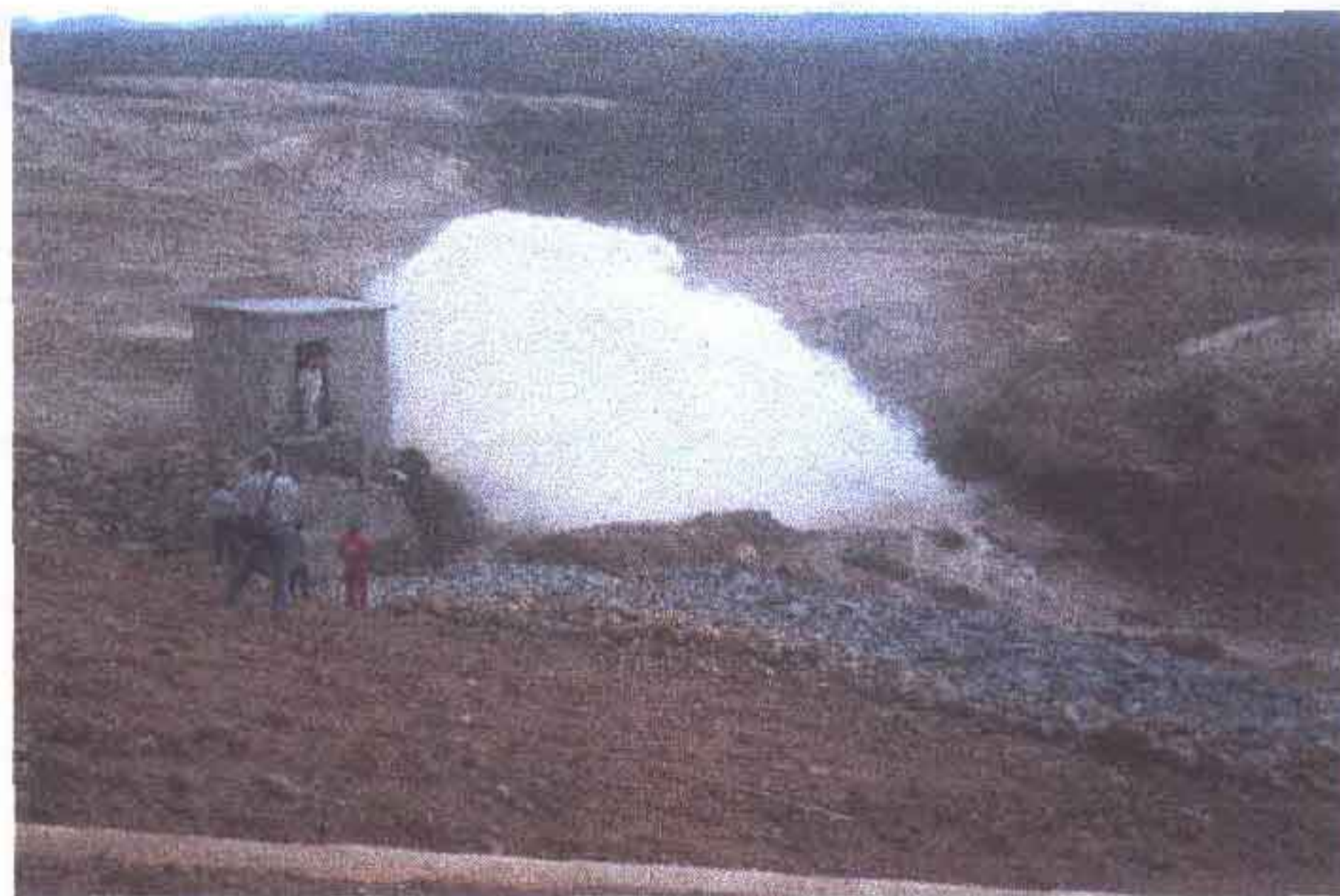
FOTO 10 - Detalhe da casa de comando da válvula dispersora
