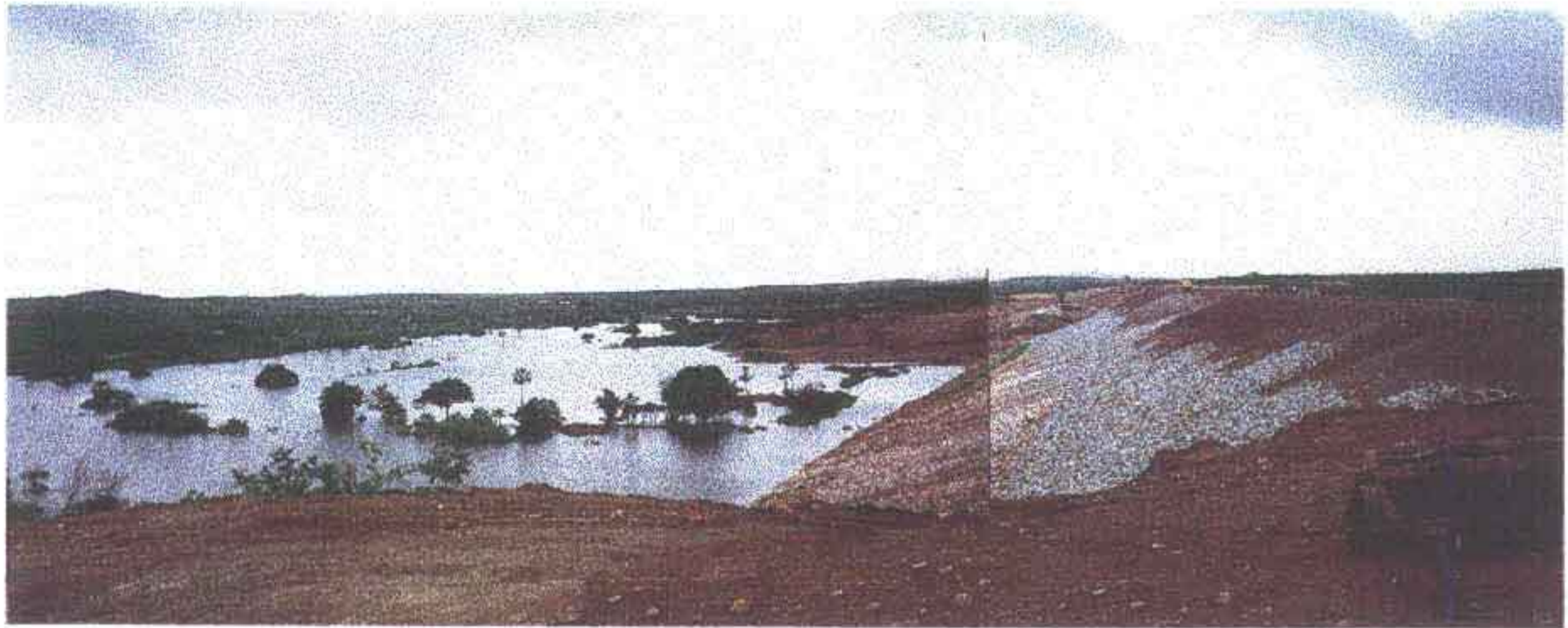
Foto 04 - Aspecto geral do talude de montante, verifique as duas qualidades de rocha empregada no "rip-rap" e a irregularidade na execução do mesmo. Observe ainda a quantidade de água acumulada.
