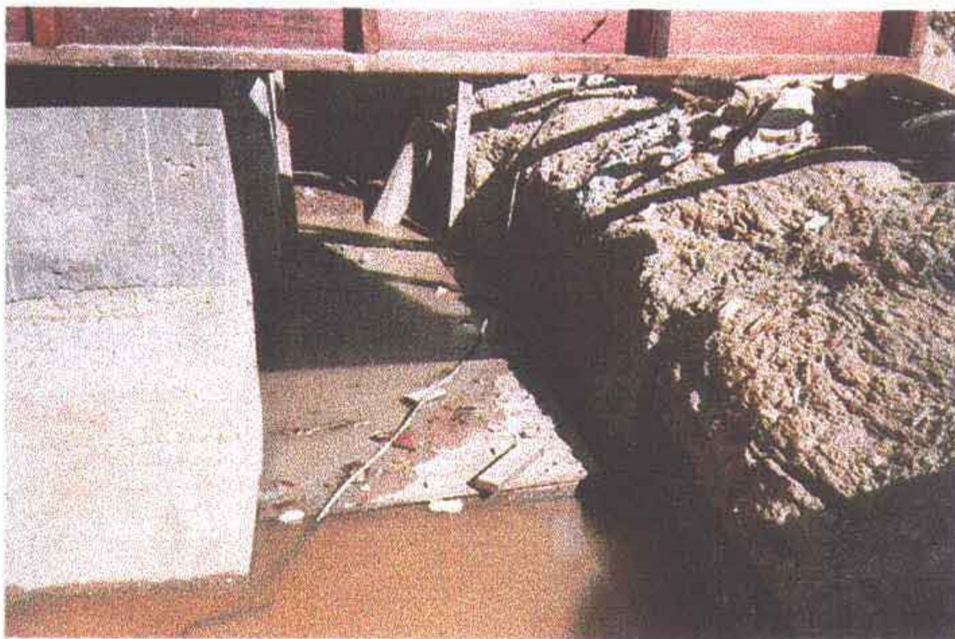
Foto 12 - Vista da entrada da boca da tomada d'água. Verifique o corte em rocha acima da tubulação que deverá ser escavado na cota 135.00.
