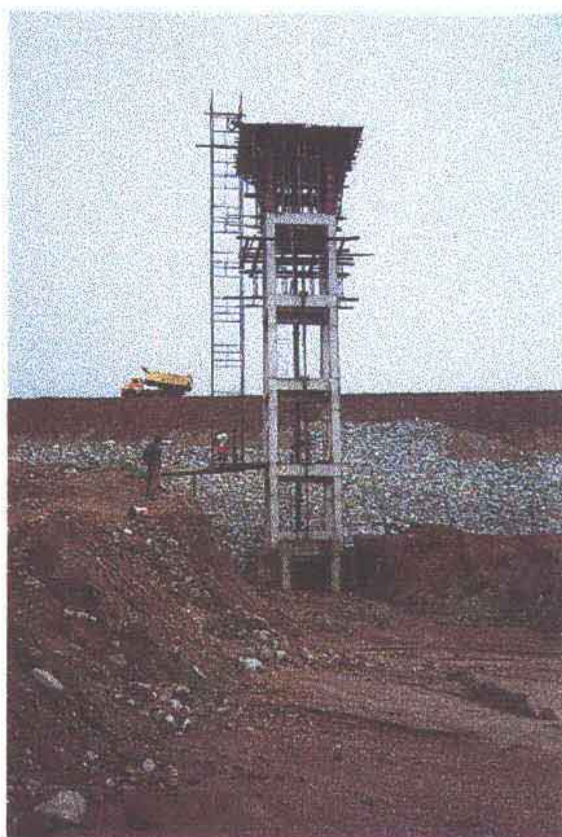
Foto 09 - Torre da tomada d'água, vista de montante. Observe no fundo do canal de aproximação o acúmulo de argila carregado da ombreira por chuvas.
