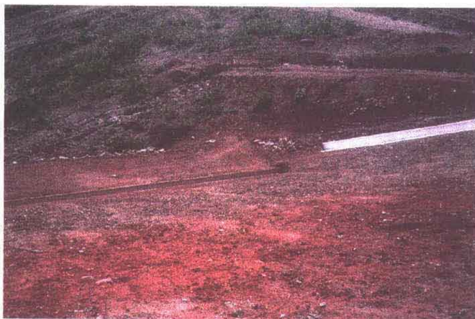
FOTO 6 - Vista da canaleta de ombreira sem ligação para jusante e com a calha longitudinal.
