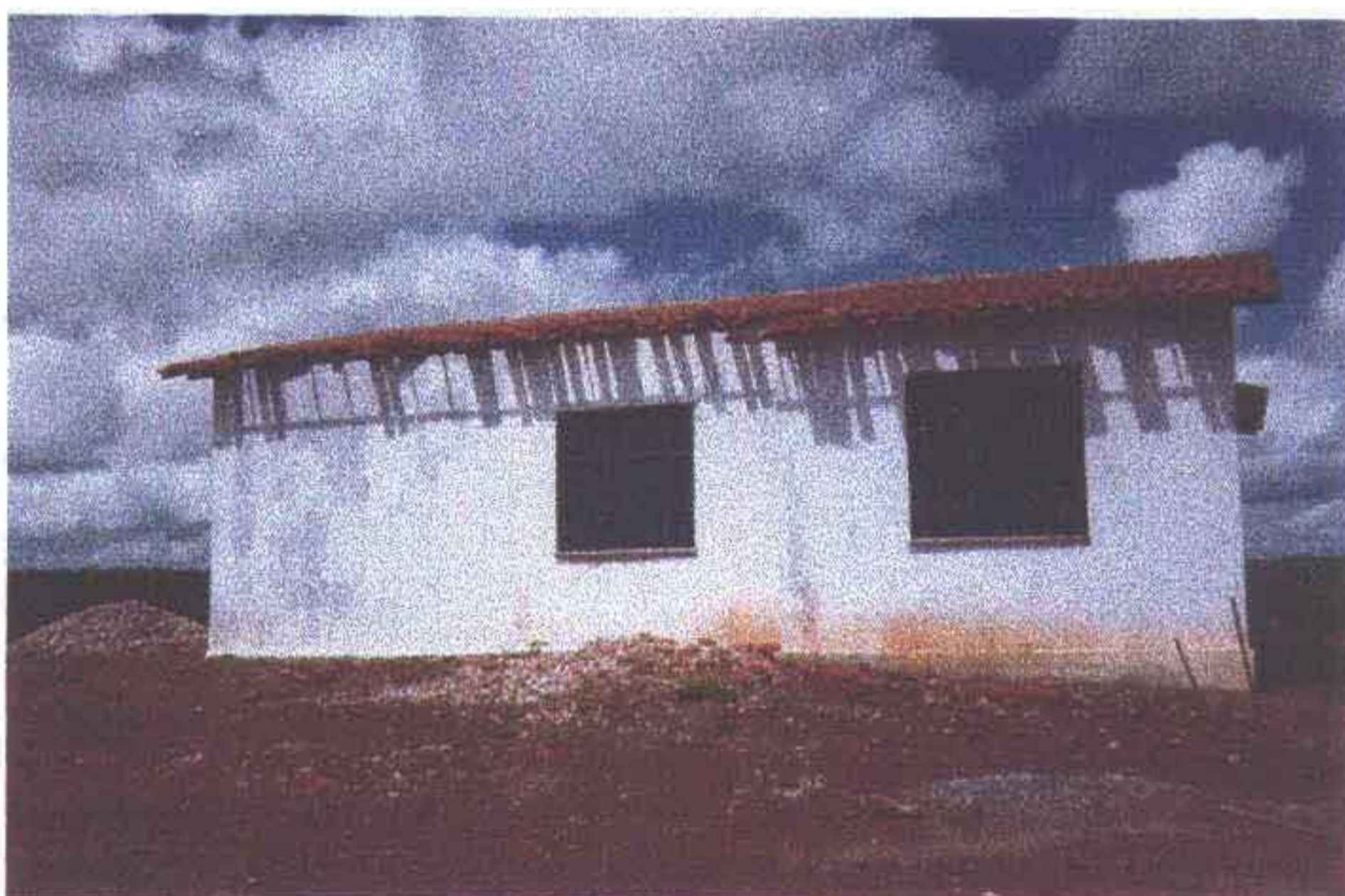
Foto 23 - Deslocamento e quebra do telhado da residência, provocado por ventos, por falta de concretagem das extremidades nos encontros com paredes e cumeeira.
