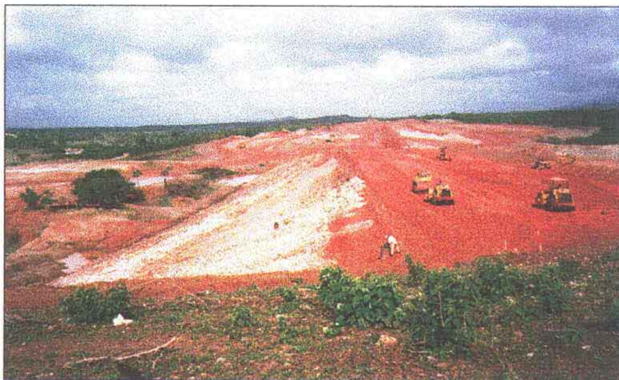
Vista do talude montante. Observar atraso na execução do enrocamento de montante com seixo rolado.
