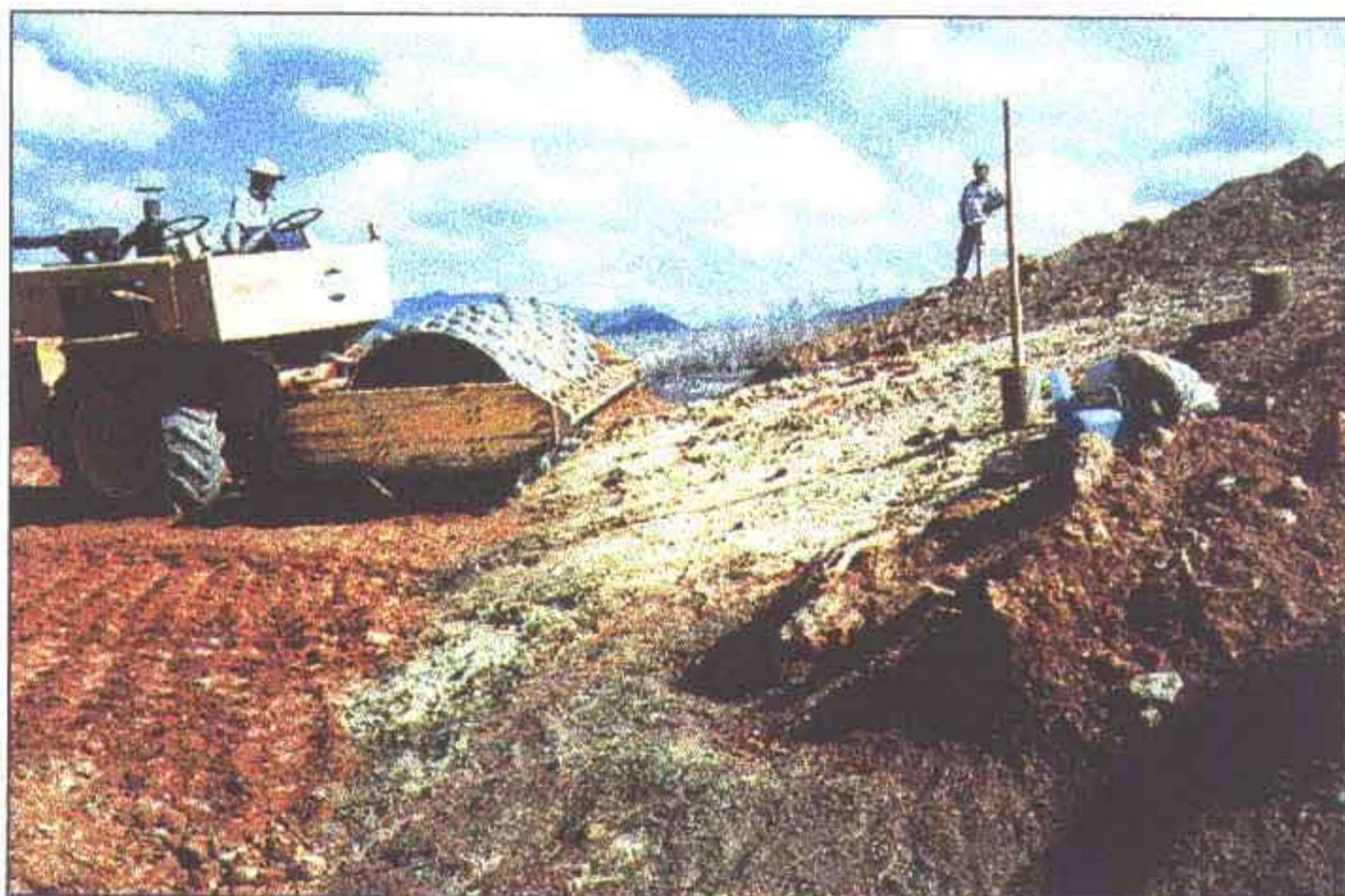
Compactação de camada. Verificar o avanço do rolo compactador no encontro maciço/ombreira.
