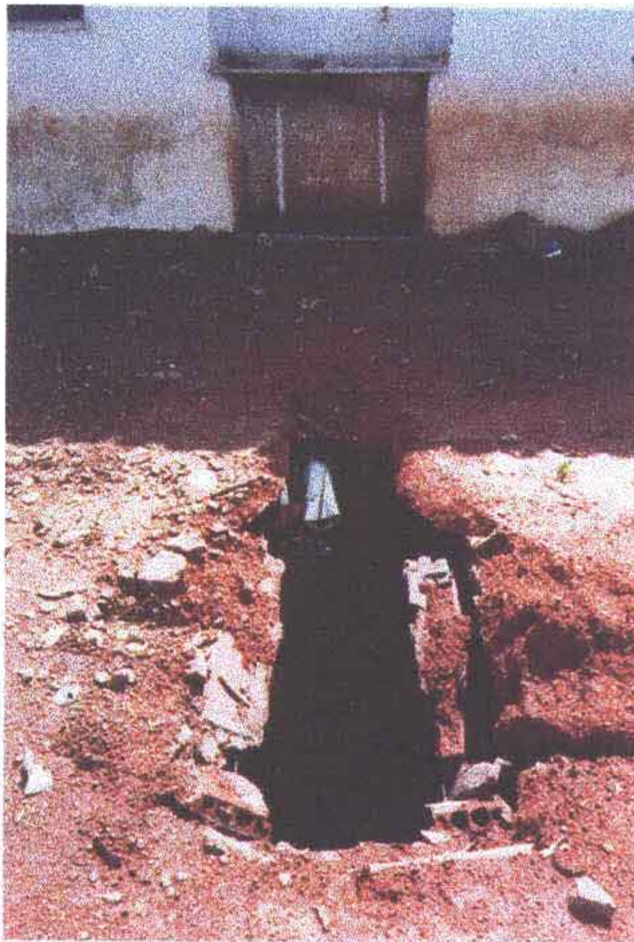
Foto 24 - Fossa da residência destruída, devido a passagem de tratores da construtora.
