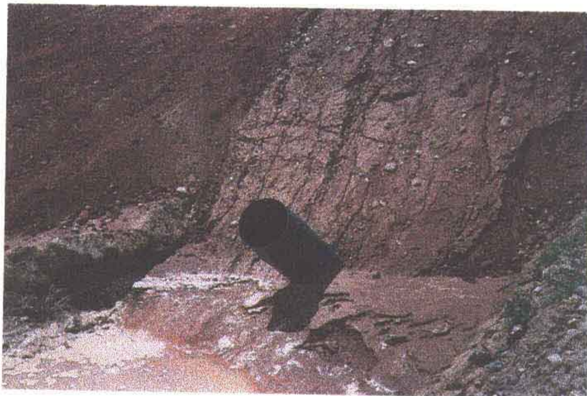
Foto 15 - Extremidade da tubulação quase soterrada a jusante.
