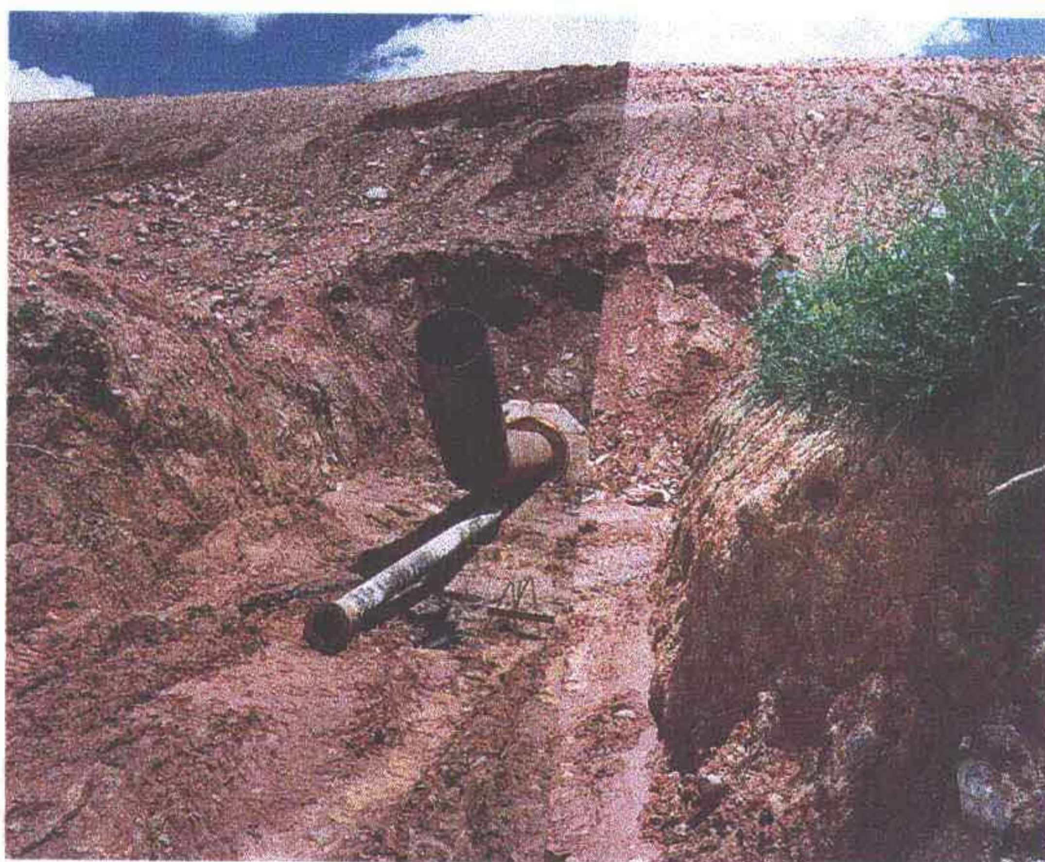
Foto 13 - Saída da galeria. Observe a tubulação do dreno conectada ao fundo da tubulação maior.
