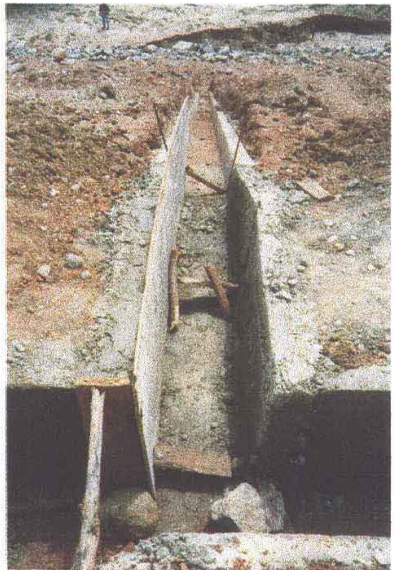
Foto 12 - Construção da calha coletora na berma, observe a espessura da material a ser regularizado
