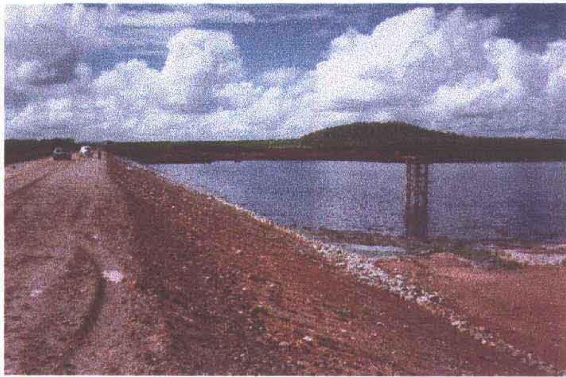
Foto 04 - Verificar o atraso na execução do enrocamento com elevação a do nível d'água.
