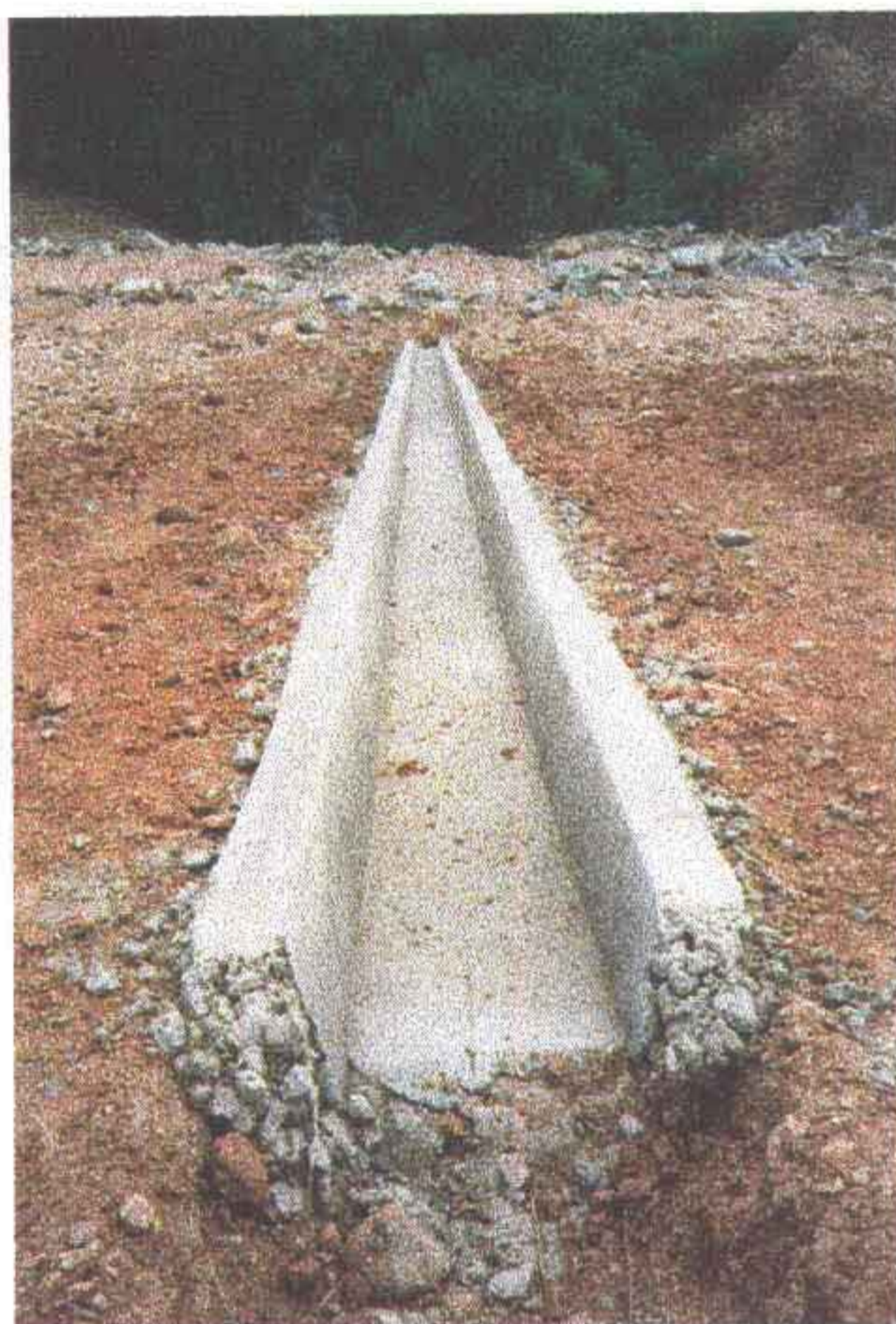
Foto 16 - Calha concretada (rápido de descida). A regularização dos taludes deve atingir o nível na altura das calhas.
