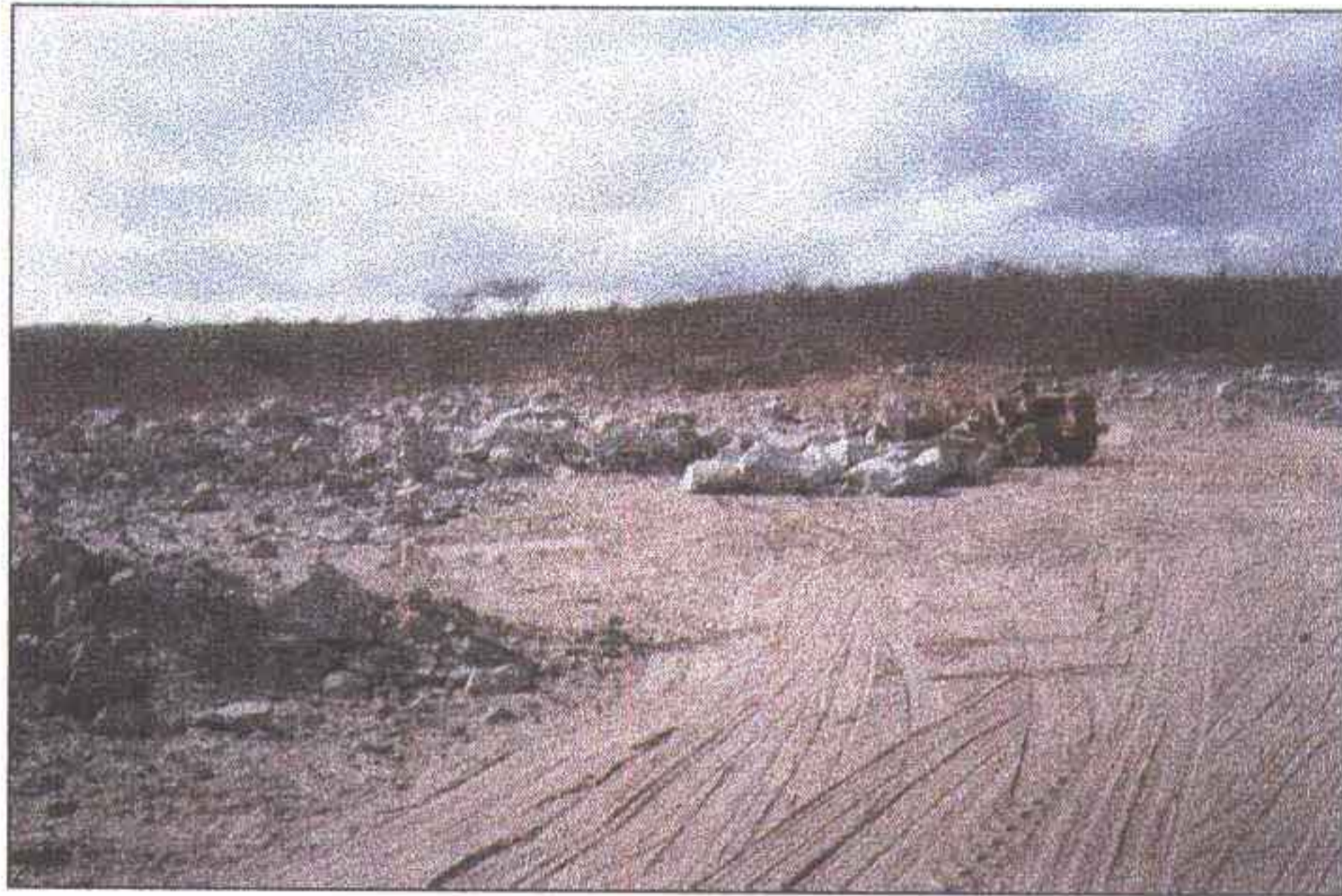
Blocos extraídos da pedreira após ser detonada. Observe-se o tamanho e forma dos blocos
