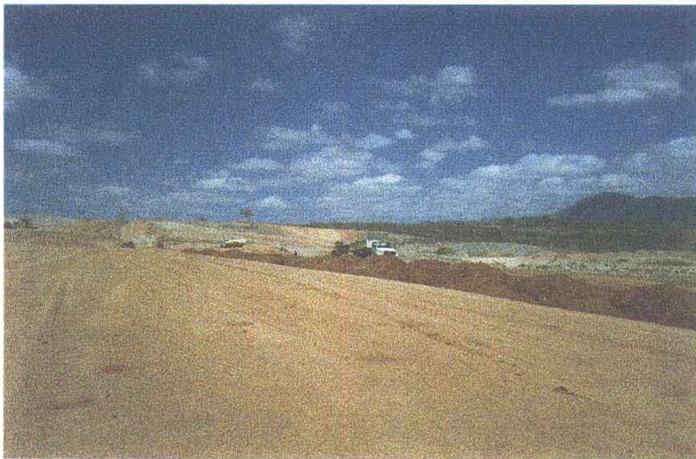
Foto 9 - Trechos da barragem entre estacas 12 e 20. Observa-se o lançamento de terra aguardando espalhamento e compactação.
