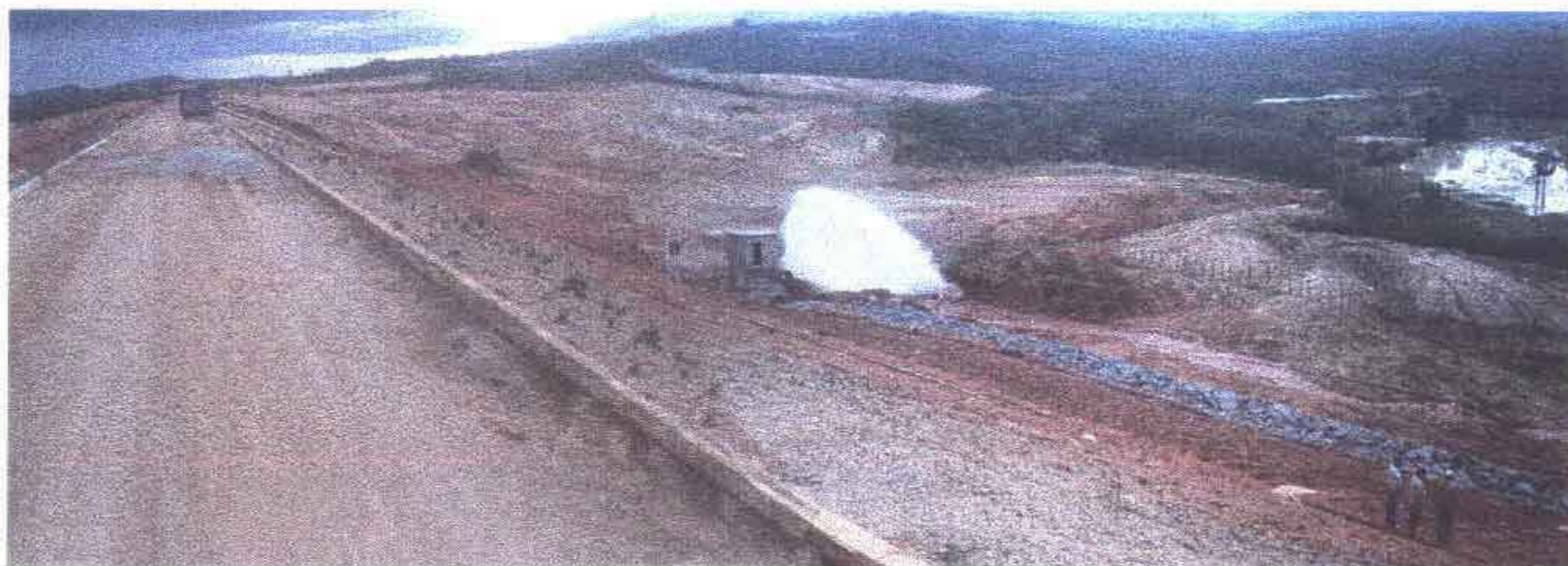
FOTO 1 - Vista do coroamento e da região de jusante a partir do coroamento no centro do boqueirão
